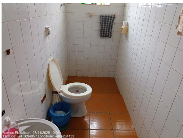
banheiro sem acessibilidade
