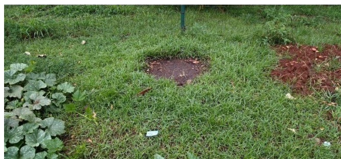
Foto 84: Sinais de vazamento em ponta de rede.
