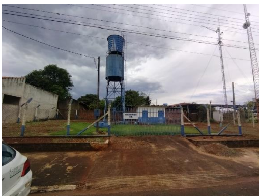
Foto 28: Falta de identificação do poço.
