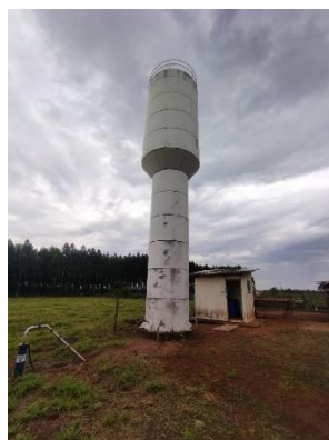
Foto 77: Ausência de para-raios e aterramento.
