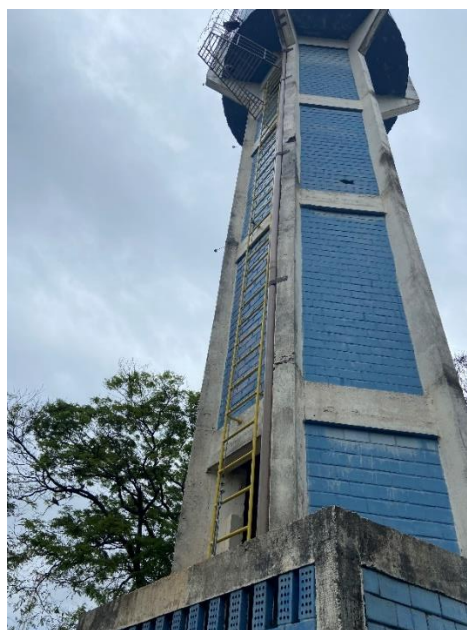
Foto 61: Escadas sem guarda corpo.
