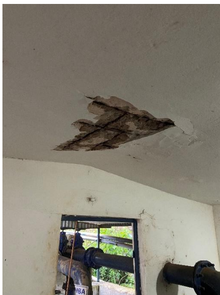
Foto 55: Necessidade de reparos.
