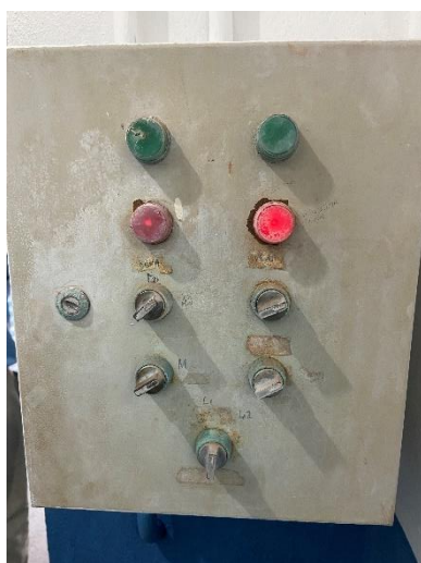
Foto 14: Quadro de comando.
