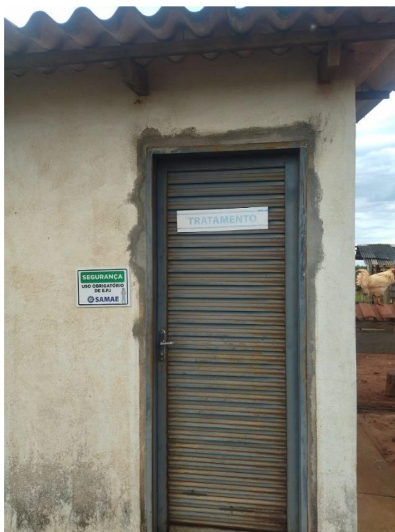
Foto 52: Abrigo do sistema de tratamento de água (poço 06).
