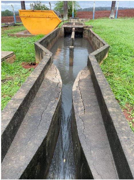
Foto 90: Desarenador e calha parshall (primário).
