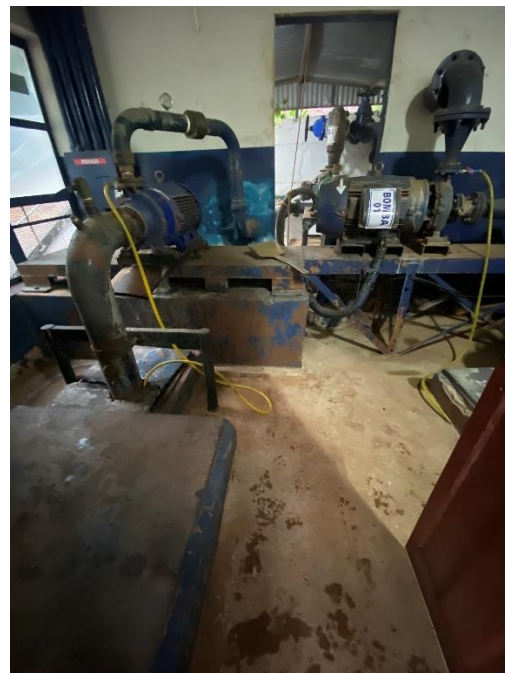
Foto 59: Conjunto moto bomba.
