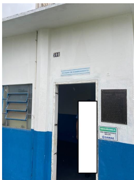
Foto 62: Falta de identificação específica.
