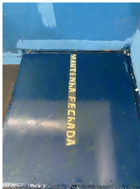
Foto 63: Tampas de inspeção adequadas.
