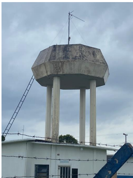
Foto 66: Necessidade de adequação de escadas e providenciar pintura.
