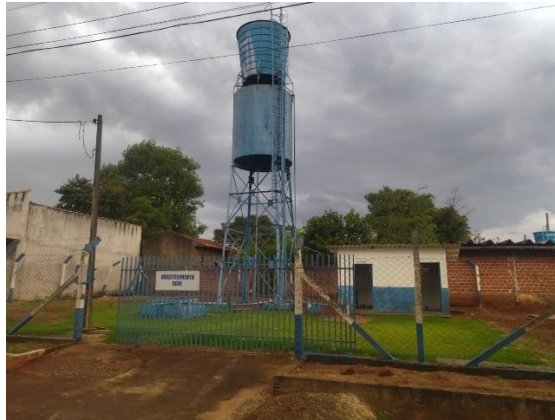
Foto 67: Falta de identificação específica do reservatório.
