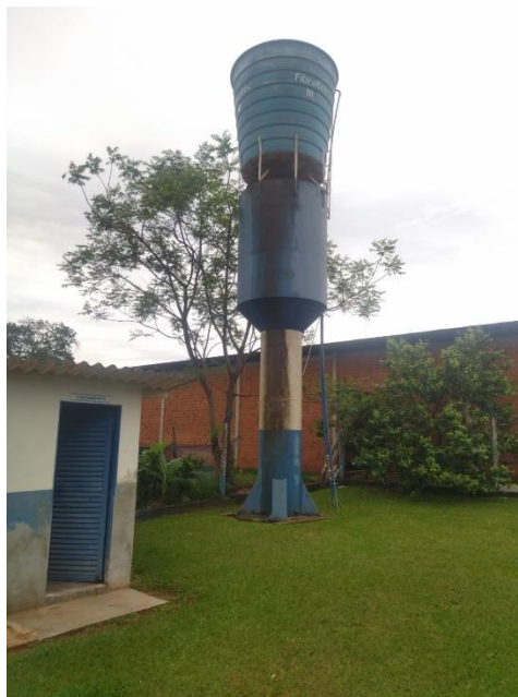
Foto 74: Estrutura inadequada, falta de para-raios.
