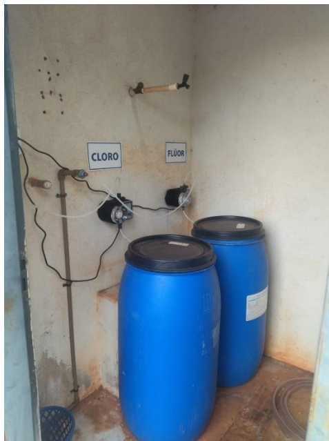
Foto 50: Bombas dosadoras (poço 06).
