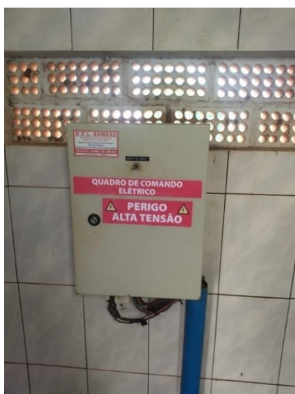
Foto 39: Quadro de comando.
