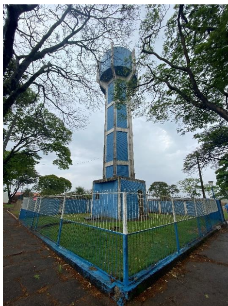
Foto 60: Falta de identificação específica.
