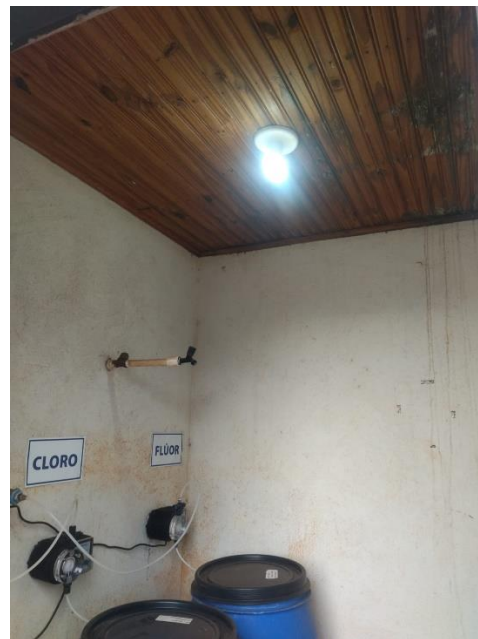
Foto 51: Iluminação interna (poço 06).
