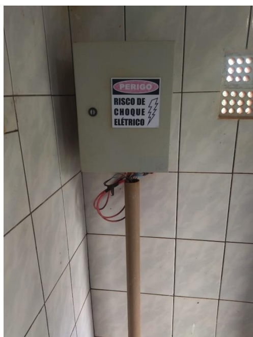
Foto 30: Quadro de comando.
