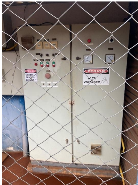
Foto 56: Quadro de comando.
