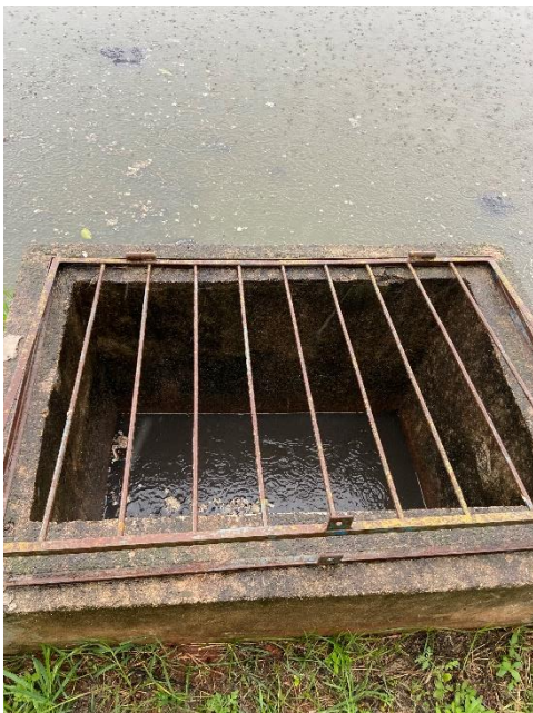
Foto 92: Dispositivo de entrada lagoa facultativa.
