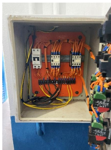
Foto 15: Quadro de Comando.
