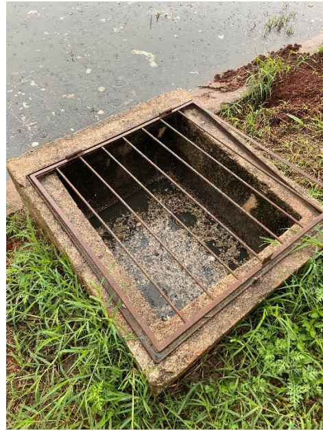
Foto 91: Dispositivo de entrada lagoas anaeróbias.
