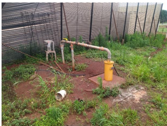
Foto 98: Poço perfurado (desativado).
