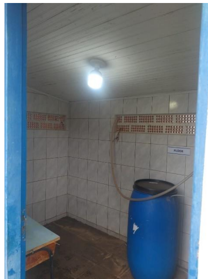
Foto 48: iluminação interna (Poço 05).
