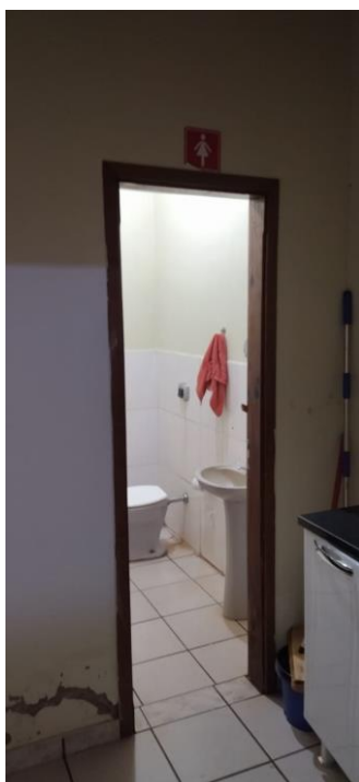
Foto 04: Banheiros sem acessibilidade.
