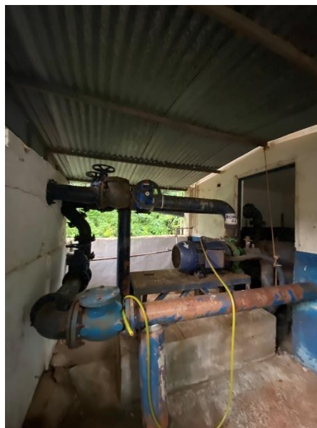
Foto 56: Falta de estrutura para as bombas de recalque.
