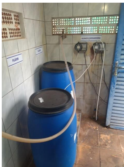
Foto 47: Bombas dosadoras (Poço 05).
