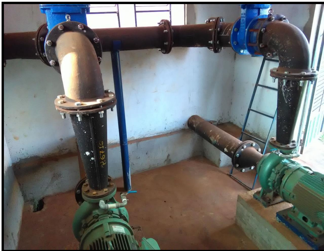
Imagem 52: Conjunto moto bombas da Estação Elevatória junto o poço 4
