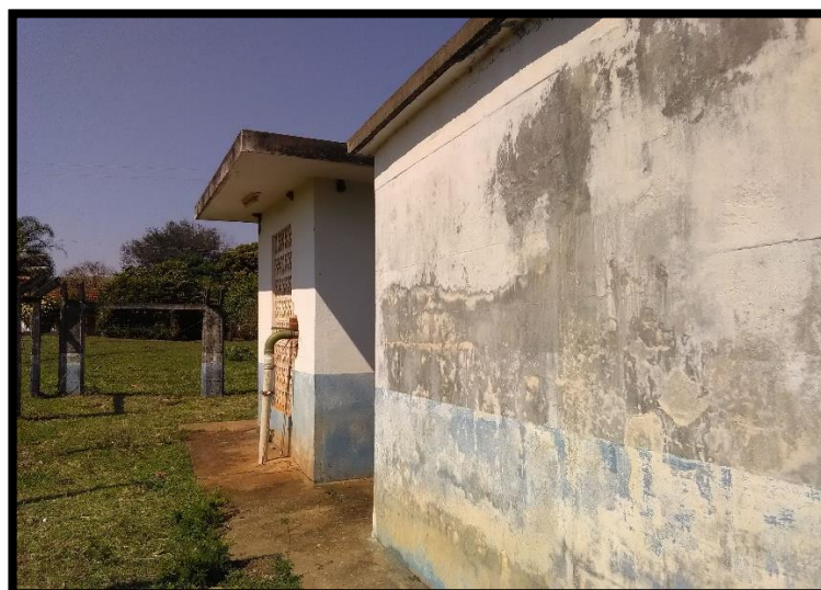
Imagem 42: Reservatório Apoiado do distrito
