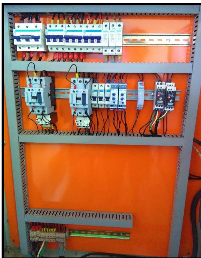
Imagem 59: Quadro de comando da Estação Elevatória do sistema Crispi
