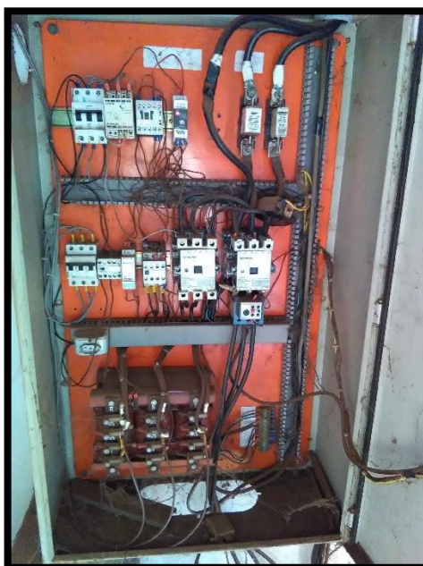
Imagem 9: Quadro de comando do Poço Bela vista
