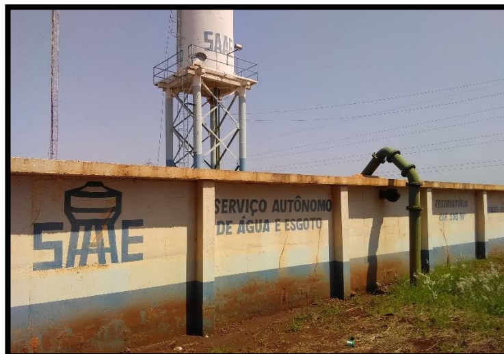
Imagem 39: Reservatório Apoiado e Elevado - Crispi
