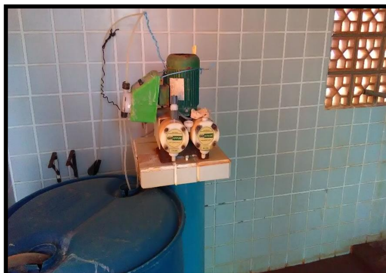
Imagem 24: Unidade de simples cloração do Poço 3
