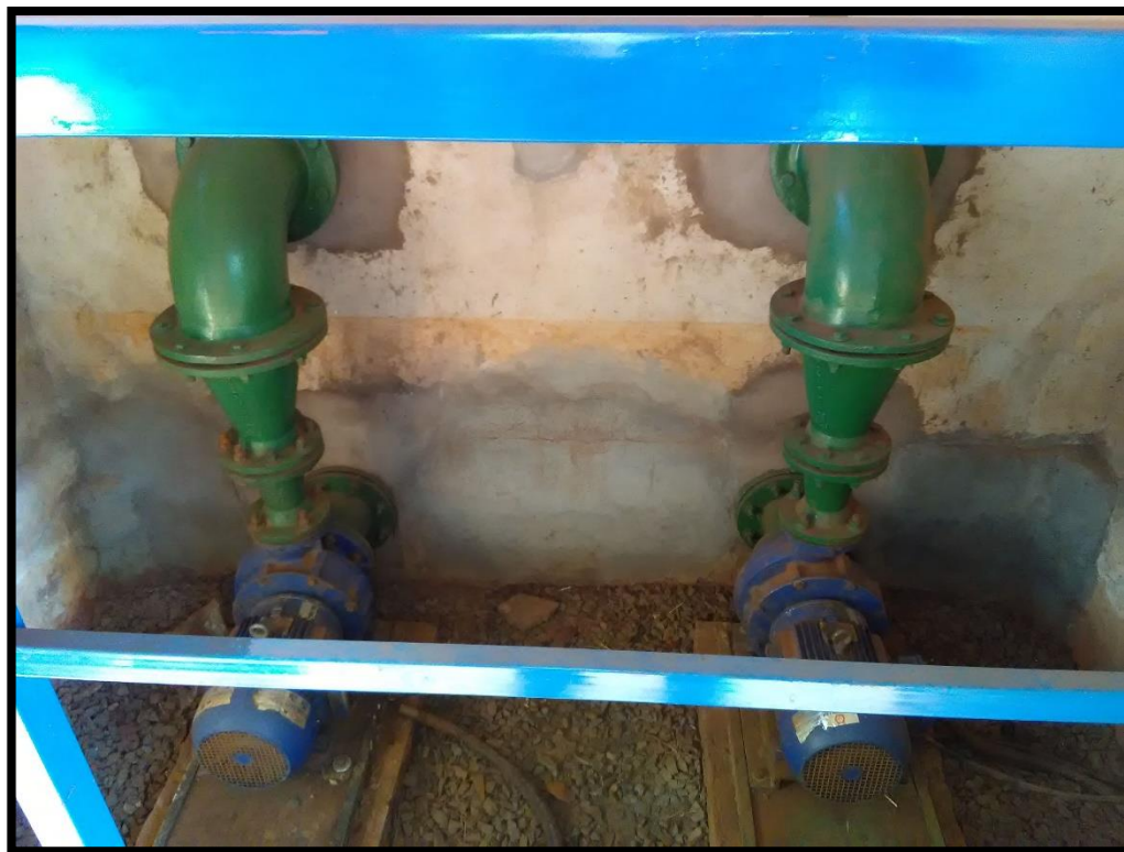
Imagem 50: Conjunto moto bombas da Estação Elevatória junto o poço 2
