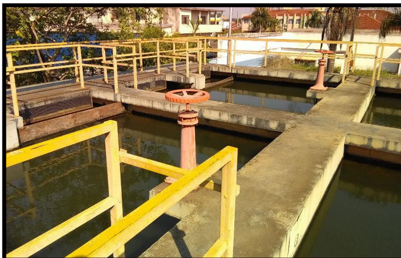
Imagem 18: Decantadores da ETA
