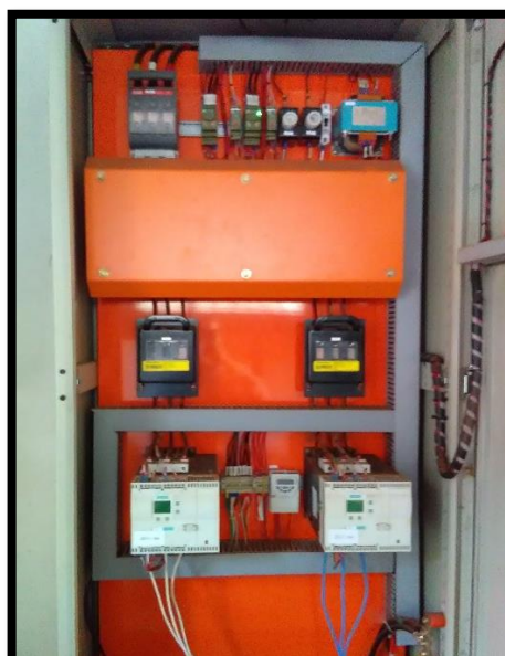
Imagem 7: Quadro de comando do Poço 4
