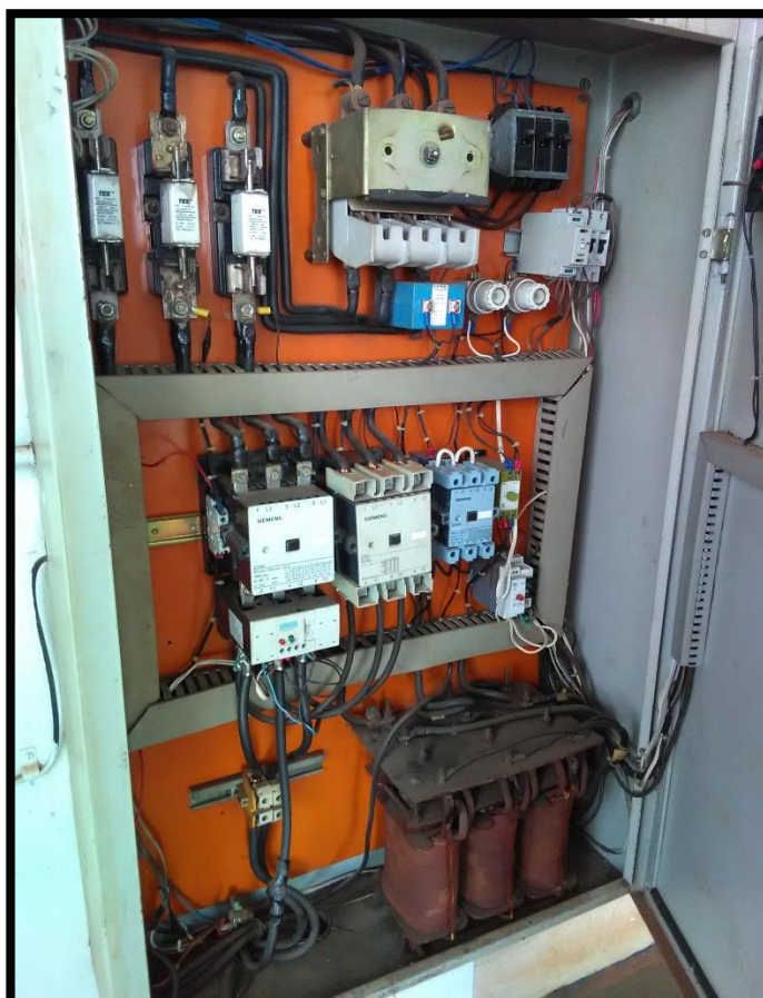
Imagem 47: Quadro de comando da Estação Elevatória da Sede
