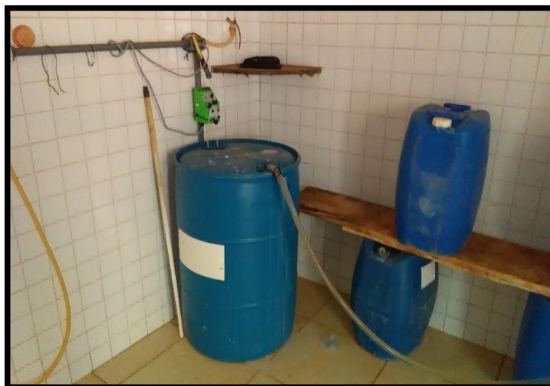
Imagem 23: Unidade de simples cloração do Poço 4
