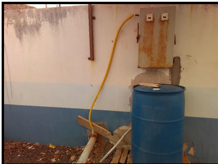
Imagem 25: Unidade de simples cloração do Poço 5
