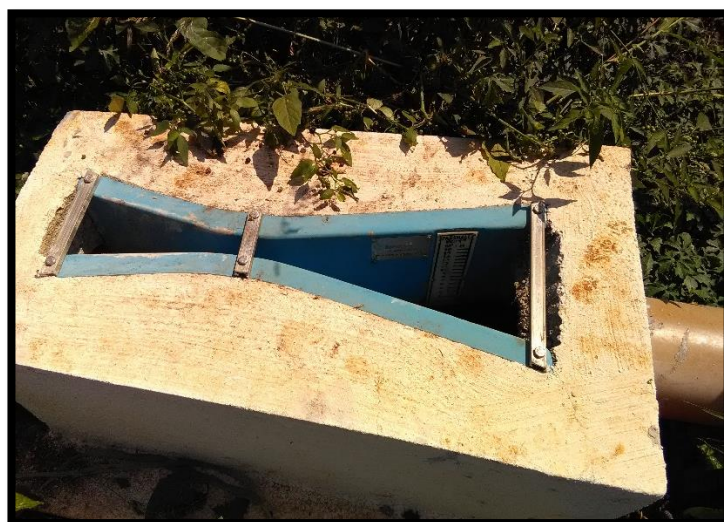
Imagem 74: Calha parshal de saída – ETE do distrito
