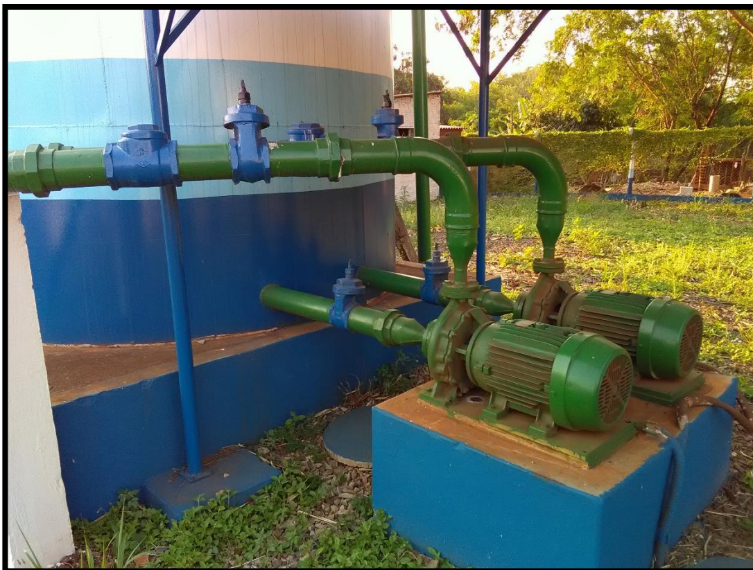
Imagem 54: Conjunto moto bombas da Estação Elevatória junto o poço Bela Vista
