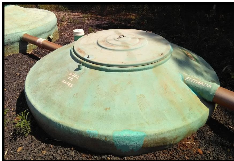
Imagem 72: Reator anaeróbio– ETE do distrito
