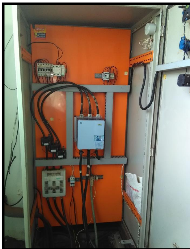
Imagem 49: Quadro de comando da Estação Elevatória que abastece o sistema Crispi
