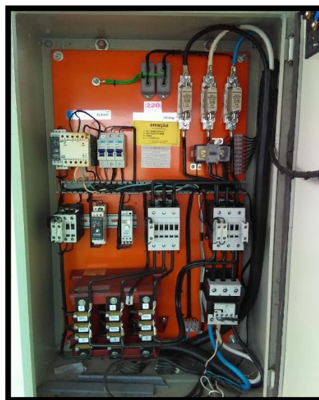
Imagem 12: Quadro de comando do Poço 5
