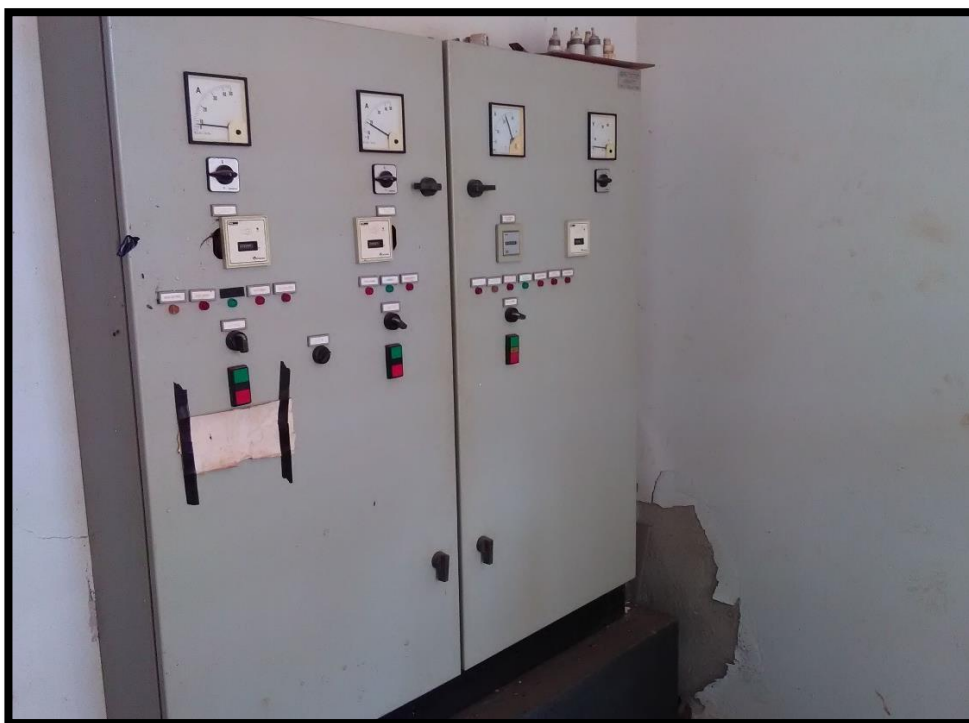
Imagem 61: Quadro de comando da Estação Elevatória do Distrito
