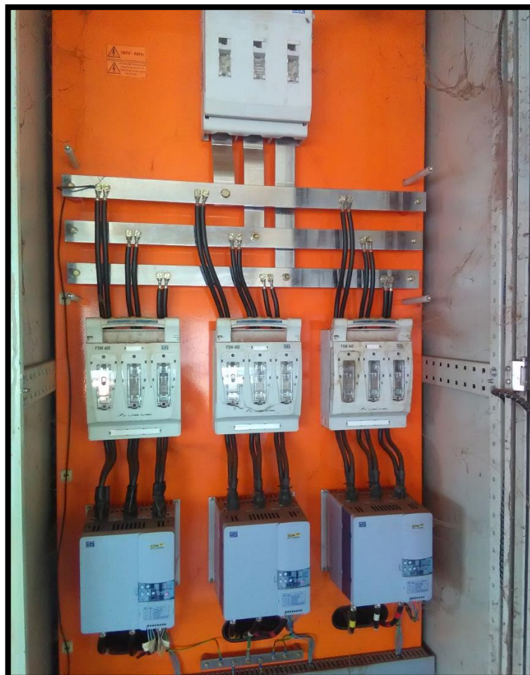
Imagem 45: Quadro de comando da Estação Elevatória da captação
