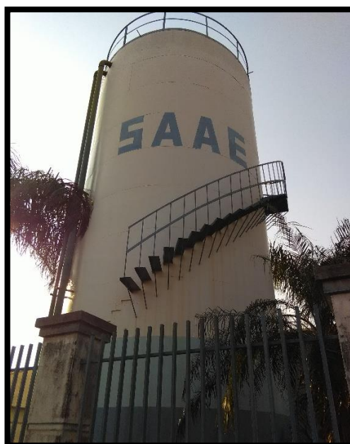
Imagem 33: Reservatório apoiado do IBC
