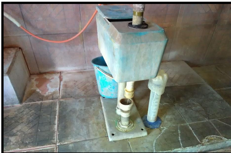
Imagem 16: Dosadora de sulfato de alumínio da ETA
