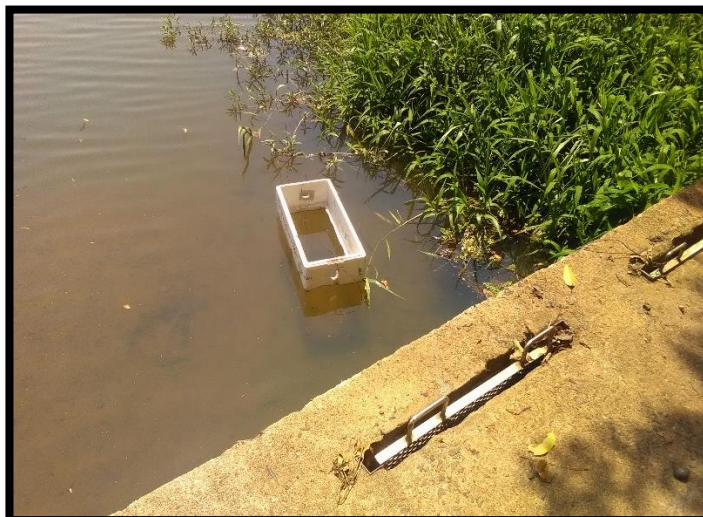
Imagem 1: Captação Superficial no rio das cinzas
