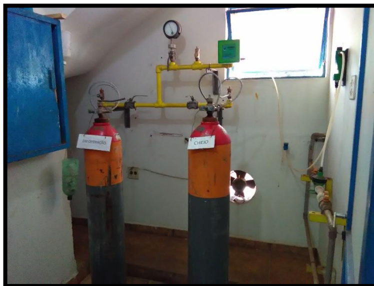
Imagem 20: Tanques de cloro Gás da ETA
