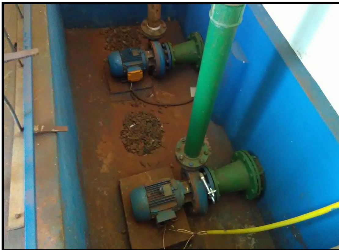
Imagem 58: Conjunto moto bombas da Estação Elevatória do sistema Crispi
