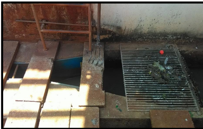
Imagem 67: Gradeamento – ETE da área urbana
