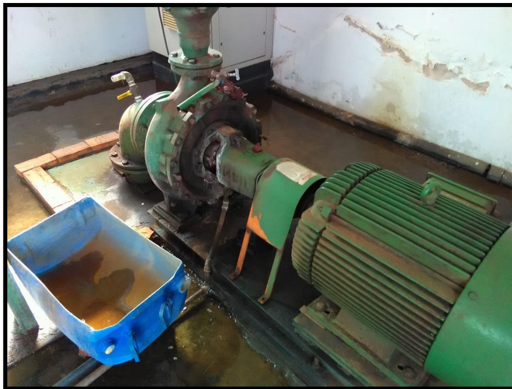
Imagem 48: Conjunto moto bombas da Estação Elevatória que abastece o sistema Crispi
