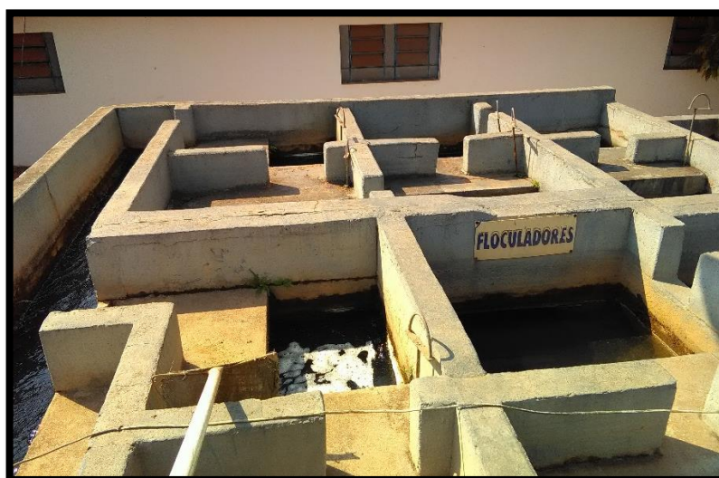
Imagem 17: Entrada da água bruta da ETA
