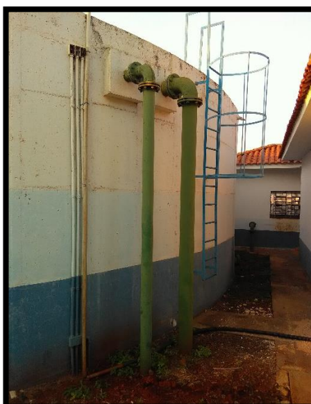
Imagem 36: Reservatórios Apoiado junto ao Poço 3
