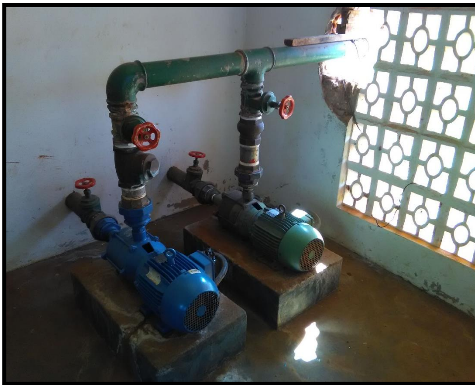
Imagem 60: Conjunto moto bombas da Estação Elevatória do Distrito
