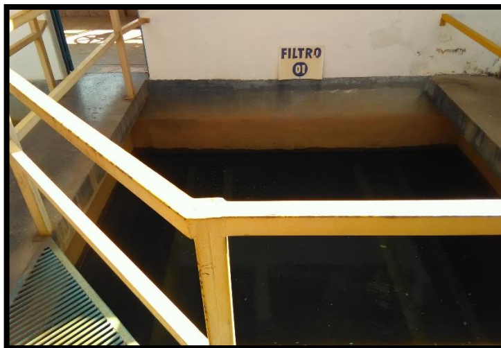
Imagem 19: Filtros da ETA
