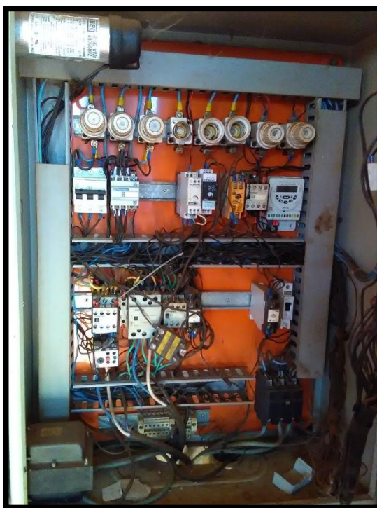
Imagem 51: Quadro de comando da Estação Elevatória junto ao Poço 2
