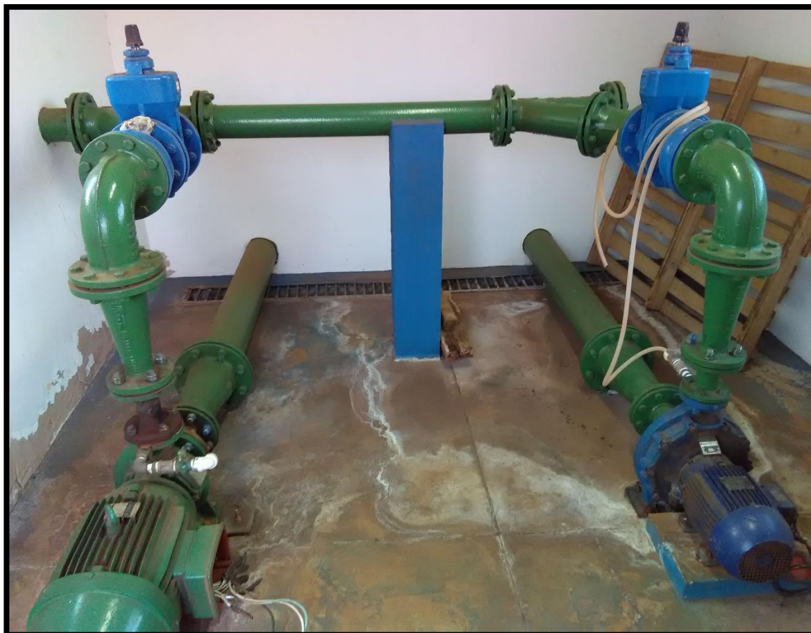
Imagem 56: Conjunto moto bombas da Estação Elevatória junto o Poço 3
