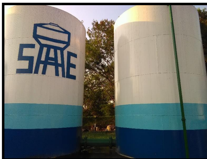
Imagem 35: Reservatórios Apoiados junto ao Poço Bela Vista (água bruta)
