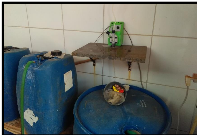
Imagem 22: Unidade de simples cloração do Poço 2
