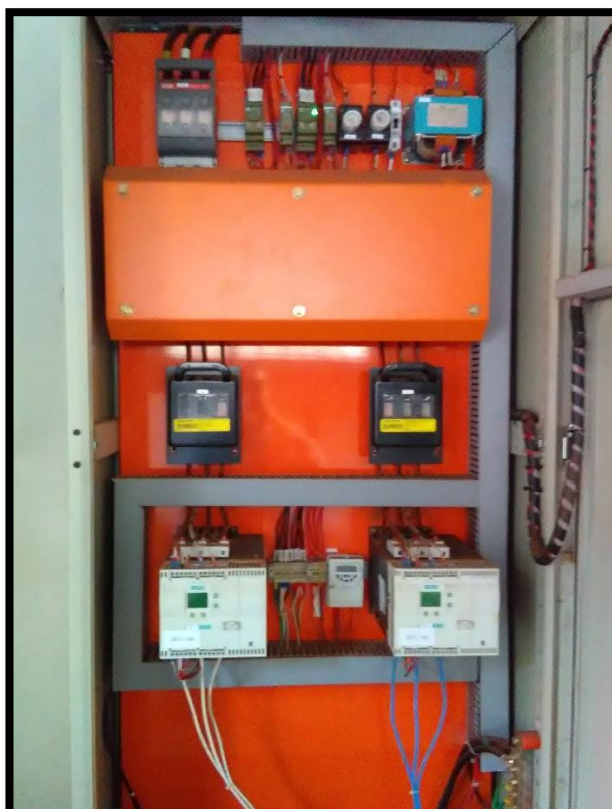
Imagem 53: Quadro de comando da Estação Elevatória junto ao Poço 4
