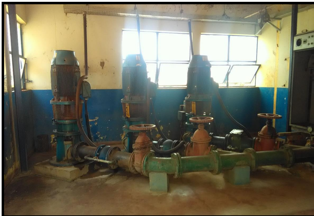
Imagem 44: Conjuntos moto bombas da Estação Elevatória da captação superficial
