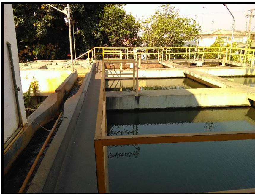
Imagem 15: Calha de entrada e decantadores da ETA
