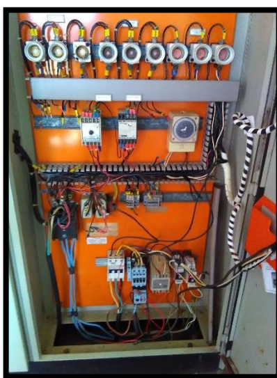
Imagem 14: Quadro de comando do Poço do distrito
