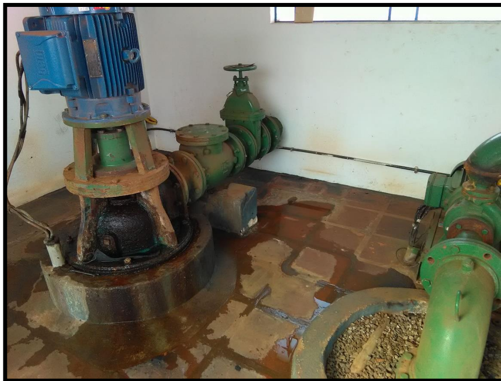
Imagem 46: Estação Elevatória que abastece o Reservatório Elevado da Sede
