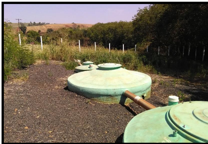
Imagem 73: Filtro – ETE do distrito
