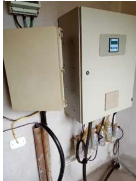
Foto 12 – Frente do quadro de comando poço 8
