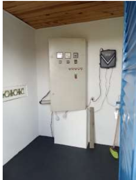
Foto 28 – Frente quadro de comando poço 2
