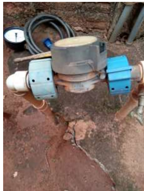
Foto 84 - Identificação hidrômetro P03 (2006)
