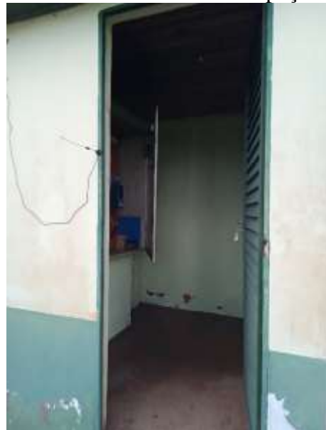
Foto 38 – Casa de comando poço 4
