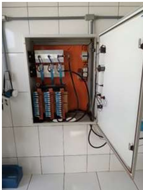
Foto 58 – Quadro de comando UTA sede
