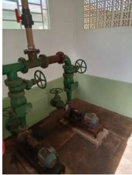
Foto 51 – Conjunto motobomba distrito
