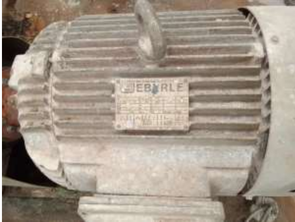
Foto 50 – Identificação bomba elevatória sede
