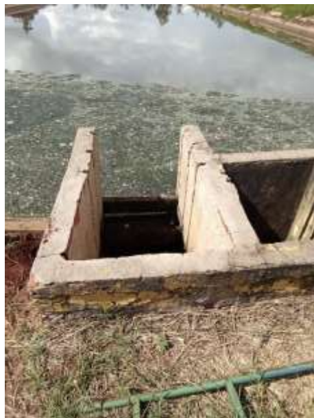
Foto 106 – Saída lagoa anaeróbia 02 Foto 107 – Lagoa facultativa (desativada para manutenção)
