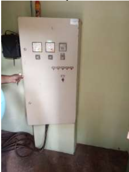
Foto 17 – Frente quadro de comando poço 7
