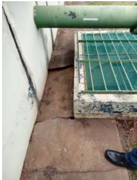
Foto 70 – Indícios de vazamentos RAP 02 sede
