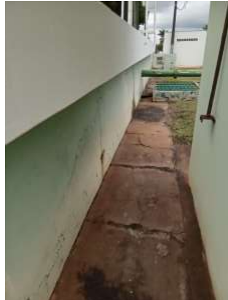
Foto 67 – Indícios de vazamentos RAP 02 sede
