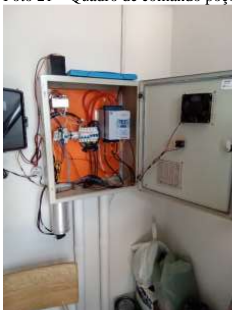
Foto 21 – Quadro de comando poço 9
