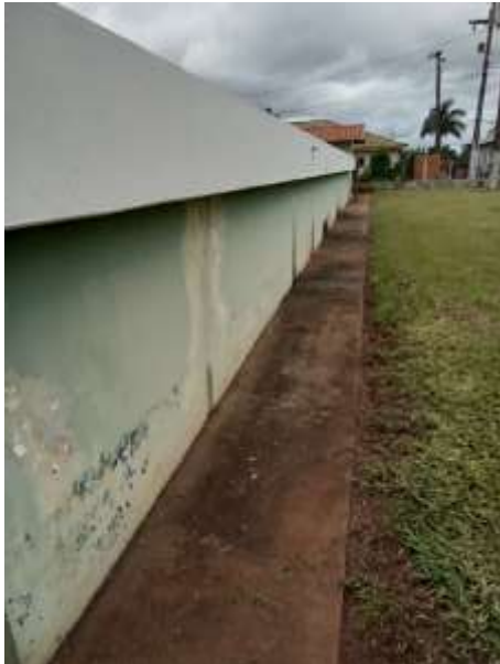
Foto 66 – Indícios de vazamento RAP 02 sede
