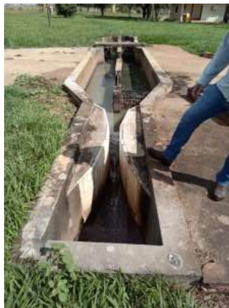
Foto 101 – Gradeamento, caixa de areia e calha Parshall (entrada)
