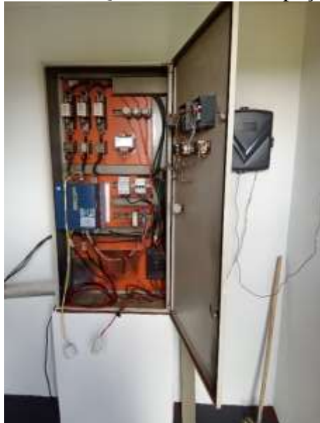
Foto 29 – Quadro de comando poço 2
