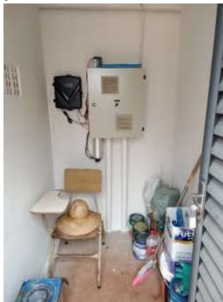
Foto 20 – Frente quadro de comando poço 9
