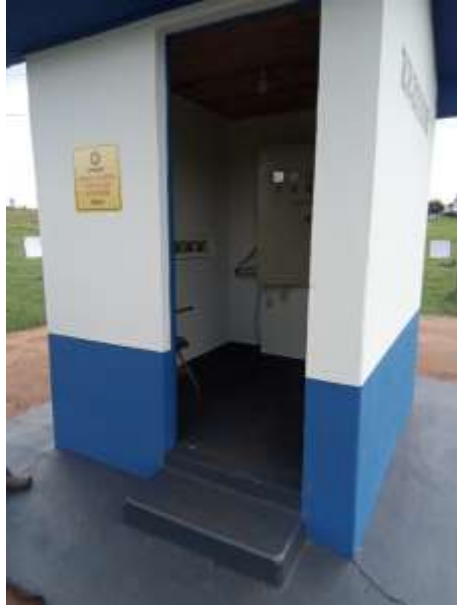
Foto 27 – Casa de comando poço 2
