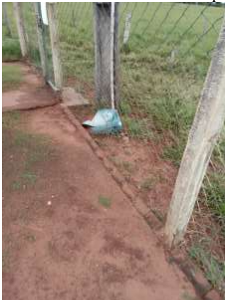
Foto 37 – Isolamento danificado poço 4
