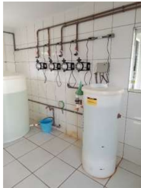
Foto 55 – Bombas dosadoras de cloro e flúor
