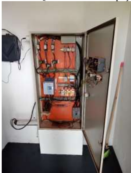
Foto 25 – Quadro de comando poço 1
