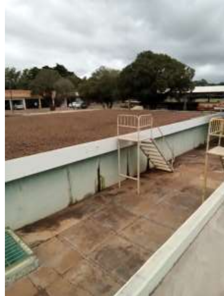
Foto 65 – Escada de acesso e indícios de vazamentos RAP 02
