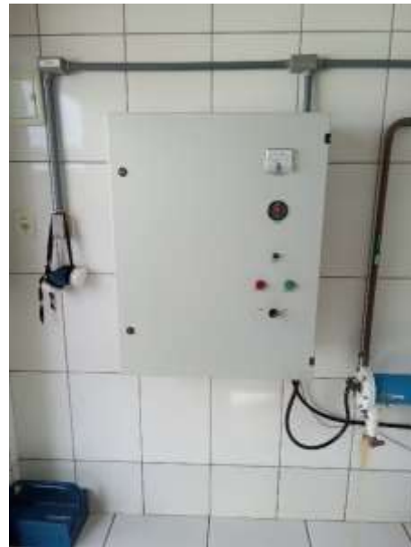
Foto 57 – Frente quadro de comando UTA sede
