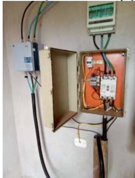
Foto 14 – Quadro de comando poço 8
