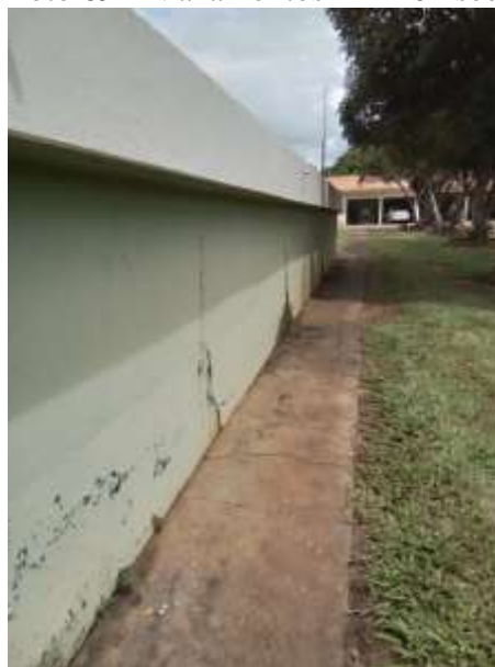
Foto 69 – Vazamentos RAP 02 sede
