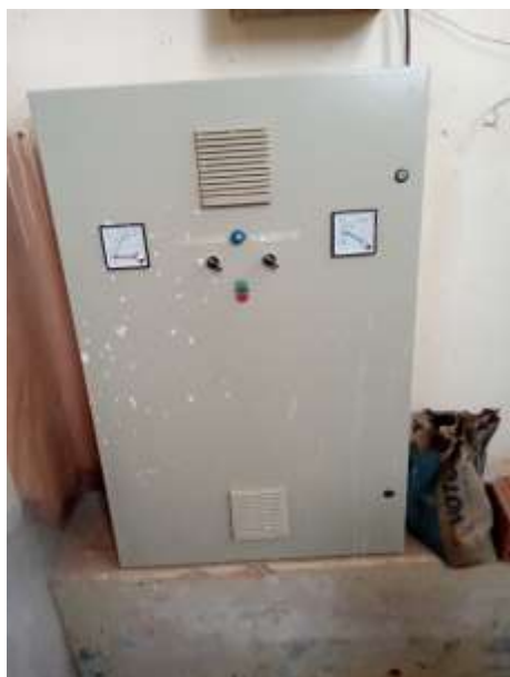
Foto 48 – Frente do quadro de comando elevatória sede
