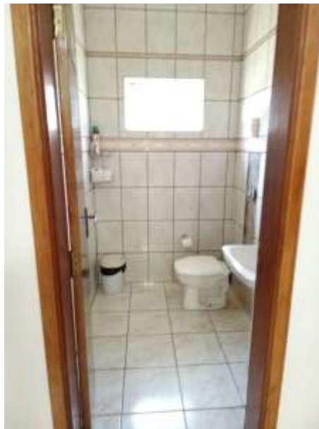
Foto 5 – Falta de barras bwc para PNE
