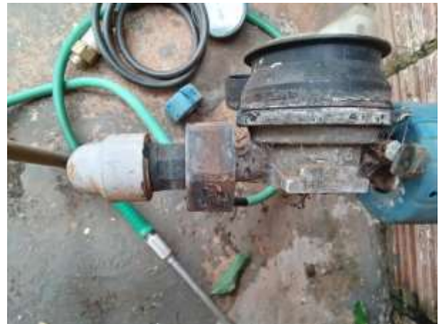
Foto 78 - Identificação hidrômetro P01 (2014)
