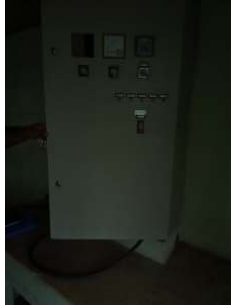
Foto 32 – Frente quadro de comando poço 3
