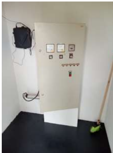
Foto 24 – Frente quadro de comando poço 1
