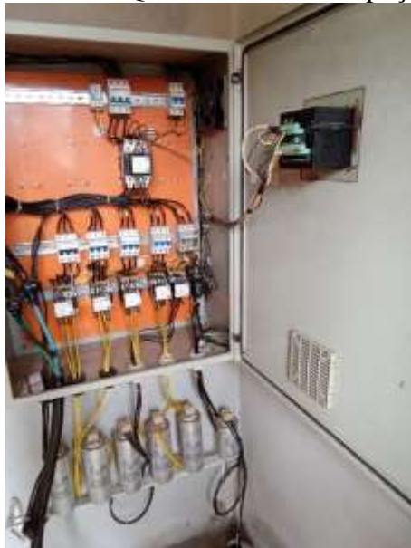
Foto 13 – Quadro de comando poço 8
