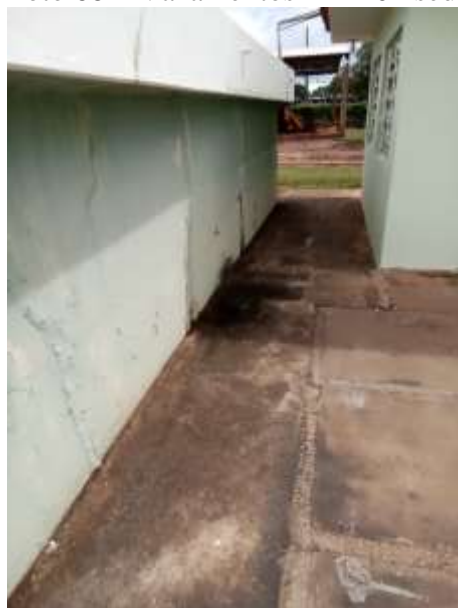
Foto 68 – Vazamentos RAP 02 sede
