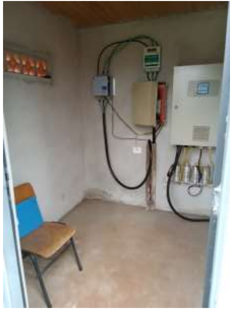
Foto 11 – Casa de comando poço 8
