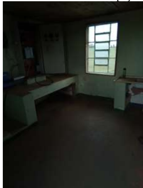
Foto 34 – Casa de comando poço 3
