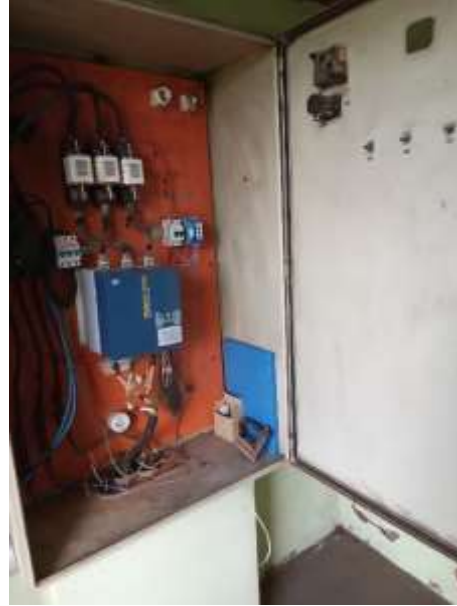
Foto 40 – Quadro de comando poço 4
