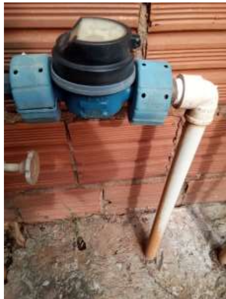
Foto 81 - Identificação hidrômetro P02 (2016)
