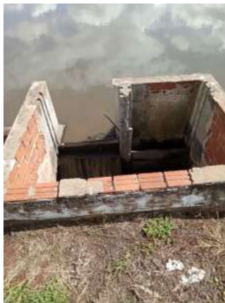
Foto 108 – Saída lagoa facultativa
