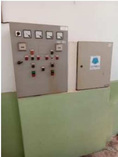
Foto 52 – Frente do quadro de comando elevatória distrito
