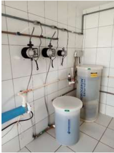
Foto 56 – Bombas dosadoras sede
