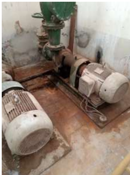
Foto 47 – Conjunto motobomba elevatória (sede)
