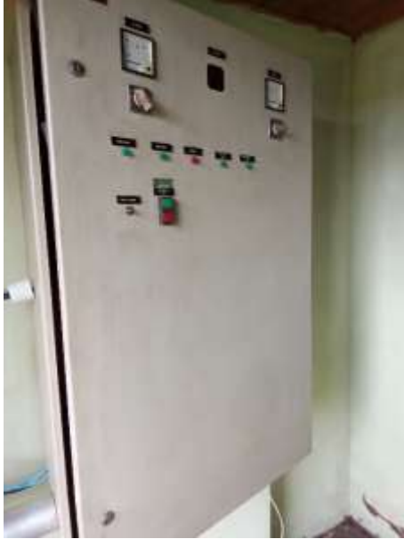
Foto 39 – Frente do quadro de comando poço 4
