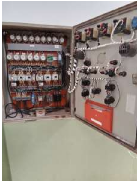
Foto 53 – Quadro de comando elevatória distrito
