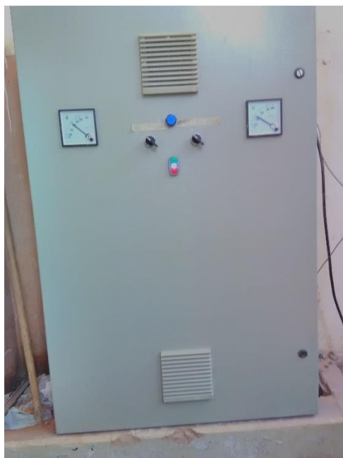
Foto 89 – Frente quadro de comando Foto 90 – Elevatória sede elevatória (sede)
