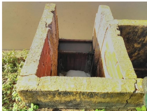
Foto 126 – Saída lagoa anaeróbia 01
