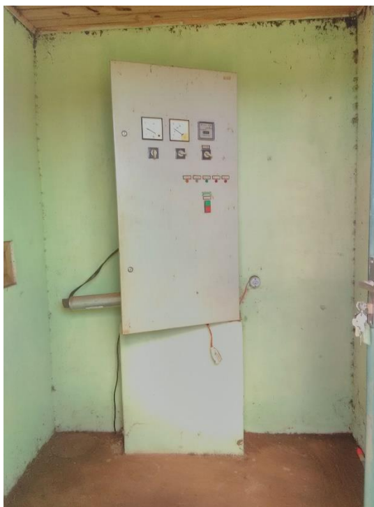
Foto 20 – Frente quadro de comando poço 02
