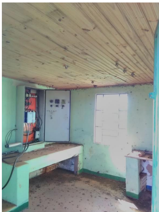
Foto 27 – Limpeza, situação da edificação e infestação de insetos no abrigo quadro poço 03
