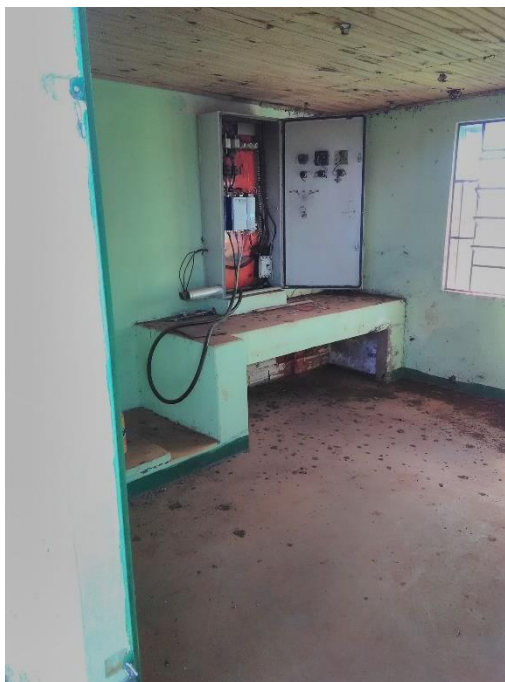
Foto 26 – Quadro de comando poço 03
