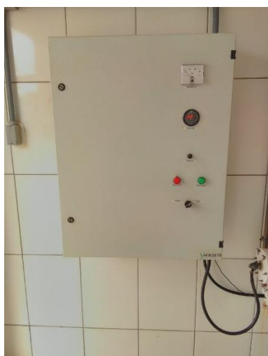
Foto 55 – Frente do quadro de comando da unidade de tratamento (sede)
