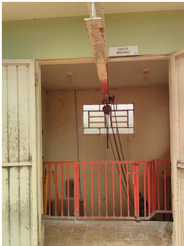
Foto 83 – Identificação elevatória (sede)
