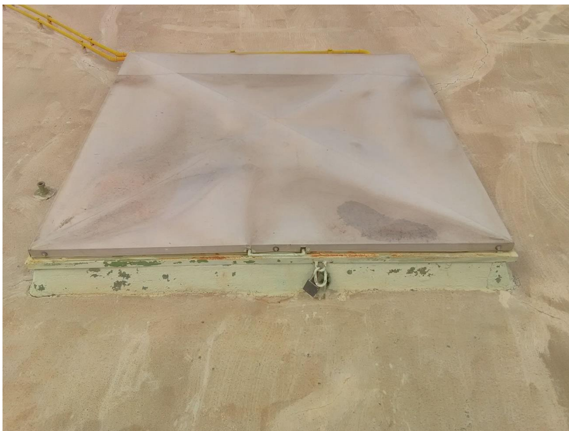
Foto 71 – Abertura de acesso RAP 01
