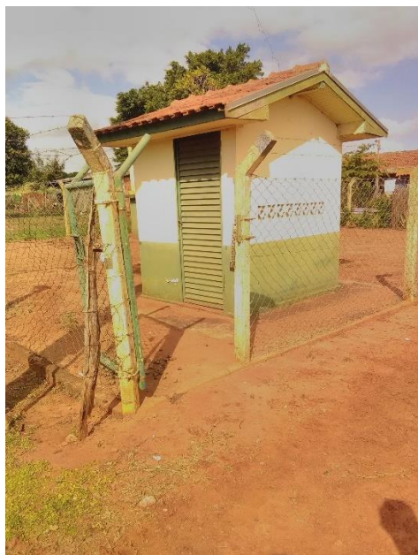
Foto 12 - Isolamento e identificação poço 01
