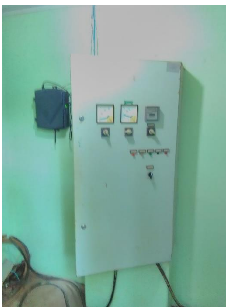
Foto 36 – Frente do quadro de comando poço 07
