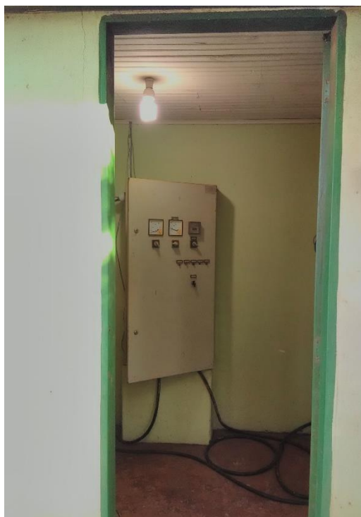
Foto 35 – Abrigo quadro comando poço 07
