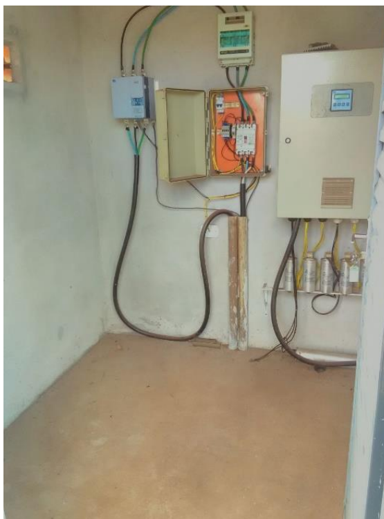
Foto 32 – Frente quadro de comando poço 05
