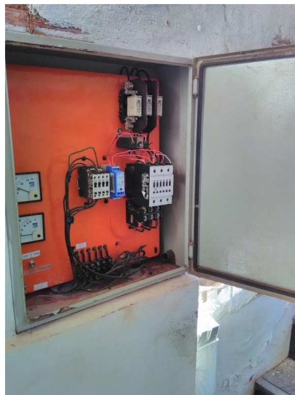
Foto 50 – Quadro de comando poço no distrito (sede)
