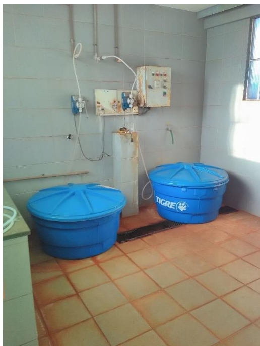
Foto 61 – Bomba dosadora (distrito)
