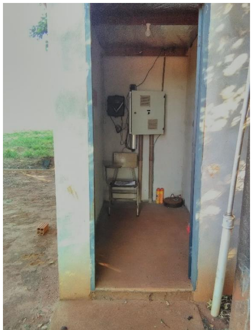
Foto 39 – Abrigo casa de comando poço 08 Foto 40 – Frente quadro de comando poço 08
