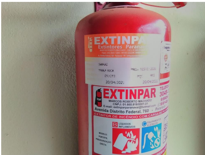
Foto 11 – Extintor área almojarifado
