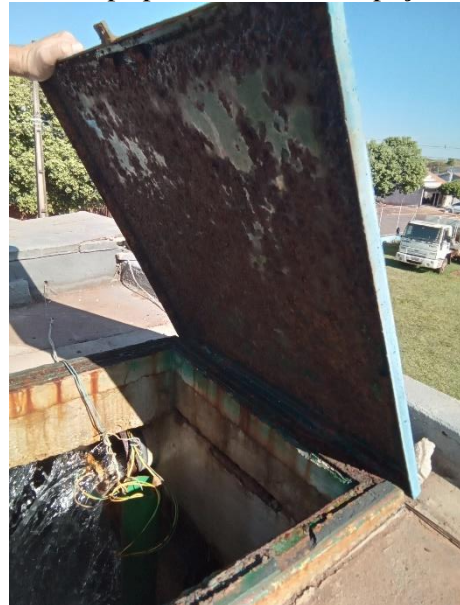
Foto 52 – Tampa para abertura de inspeção RAP
