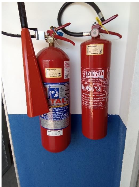
Foto 43 – Extintor UTA e laboratório
