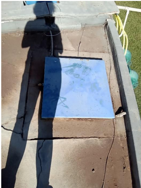
Foto 51 – Tampa para abertura de inspeção do RAP
