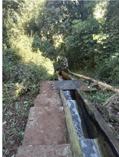
Foto 79 – Emissário para lançamento de efluente
