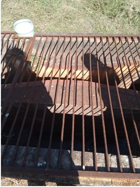
Foto 70 – Calha Parshall entrada
