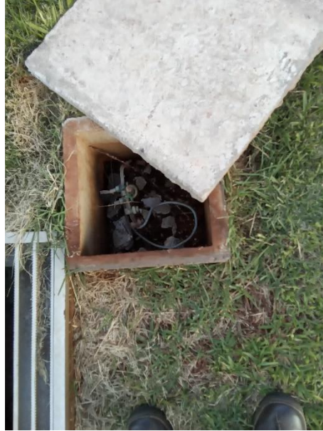
Foto 46 – Sistema de aterramento REL sede
