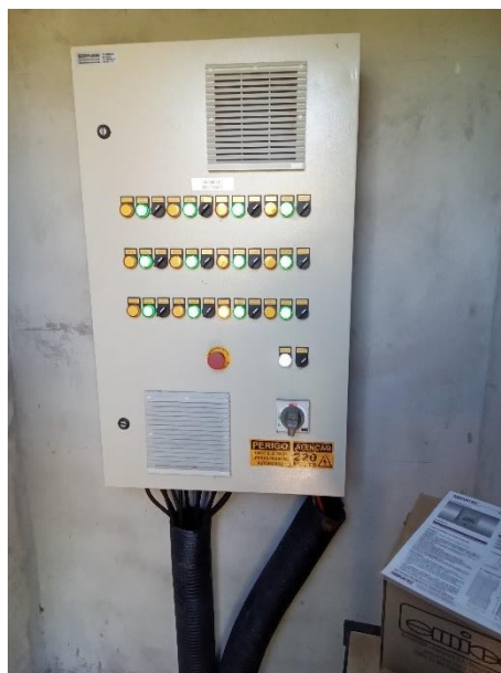
Foto 75 – Frente do quadro de comando
