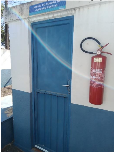
Foto 27 – Identificação e extintor poço 3
