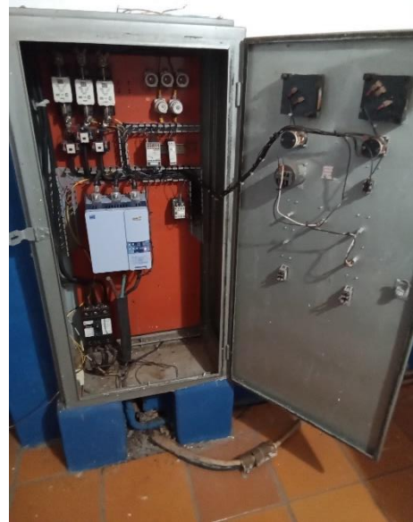
Foto 21 – Quadro de comando poço 5
