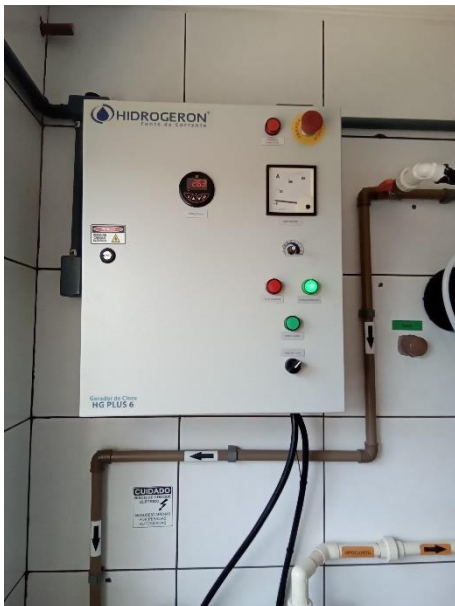
Foto 41 – Quadro de comando UTA
