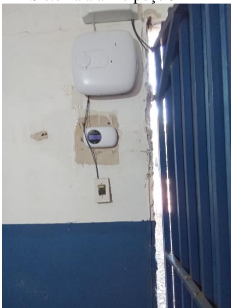
Foto 22 – Sistema alarme poço 5
