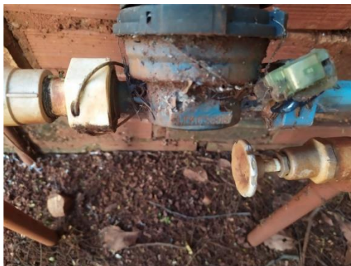
Foto 56 - Identificação hidrômetro P02 (2015)
