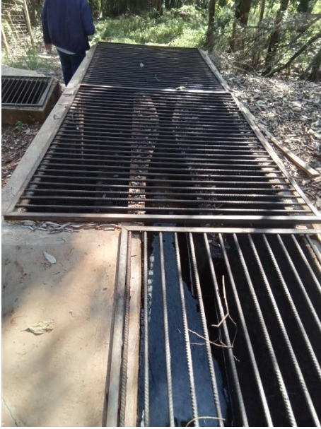
Foto 78 – Calha Parshall saída
