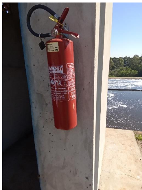
Foto 77 – Extintor casa de comando
