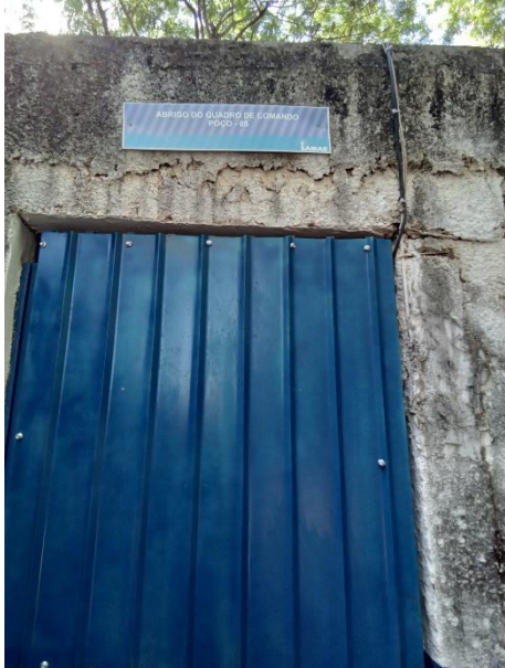
Foto 20 – Identificação casa de comando poço 5
