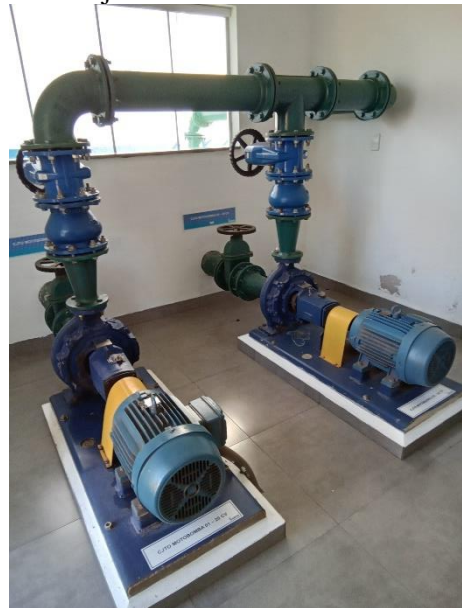
Foto 34 – Conjunto moto bomba
