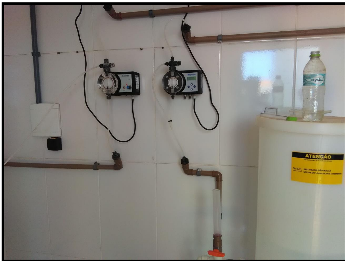
Imagem 21: Unidade de tratamento do Sistema 2
