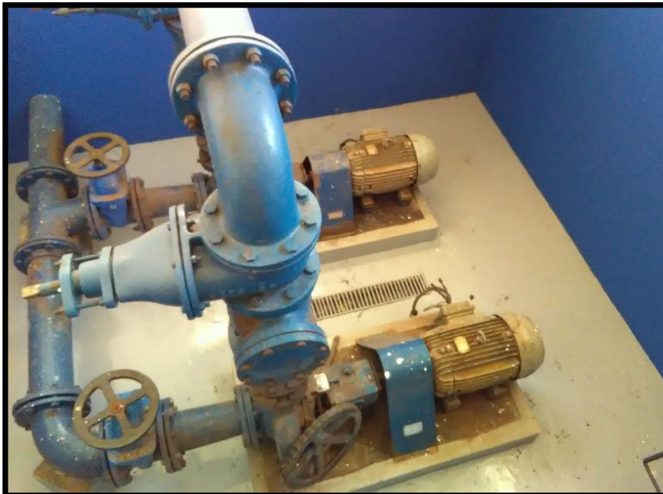
Imagem 23: conjuntos moto bombas da Estação Elevatória
