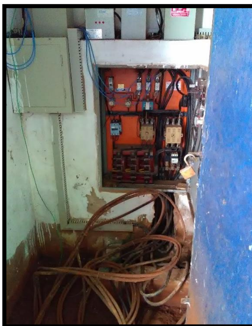
Imagem 4: Quadro de comando do poço Edimão Simão
