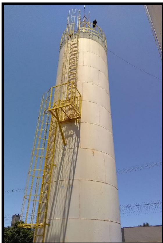
Imagem 17: reservatório apoiado do Sistema 2
