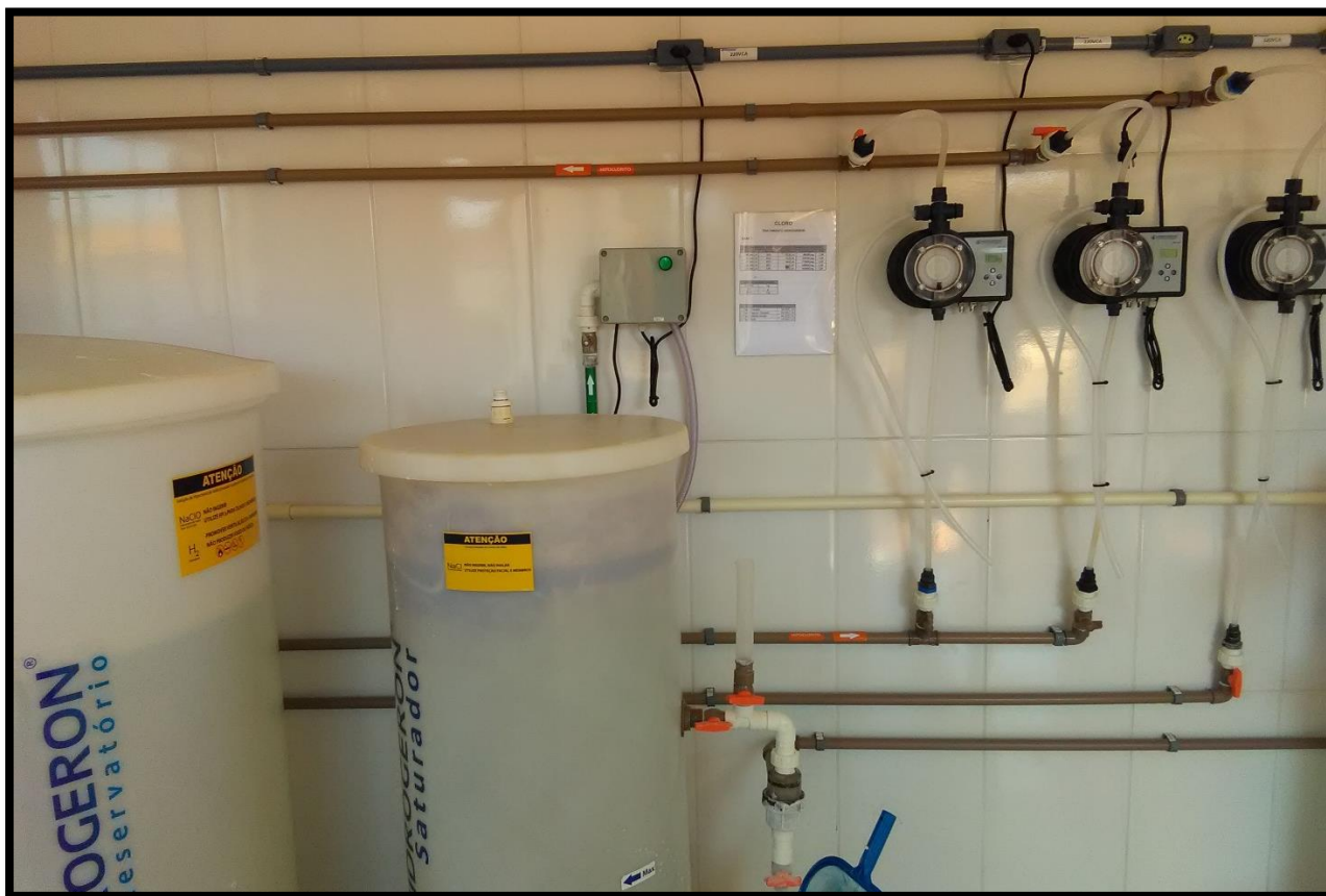
Imagem 20: Unidade de tratamento do Sistema Sede
