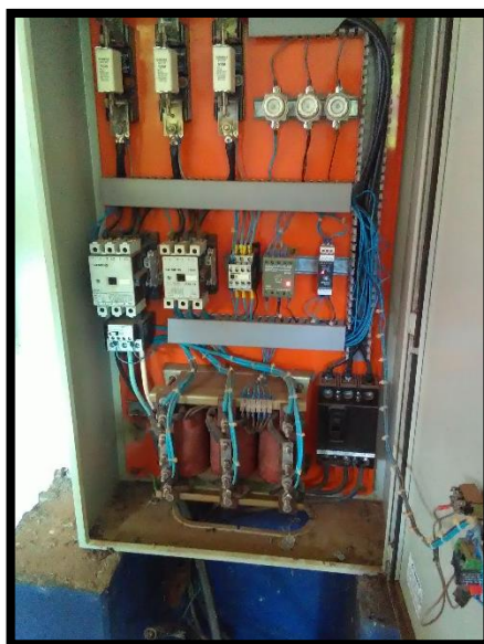
Imagem 8: Quadro de comando do poço Chácara
