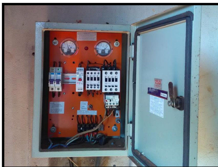
Imagem 14: Quadro de comando do poço distrito Silvolandia
