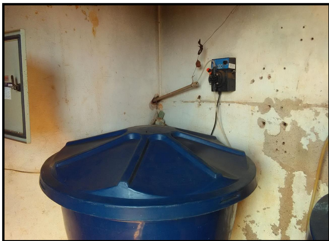
Imagem 22: Unidade de tratamento do Sistema do Distrito
