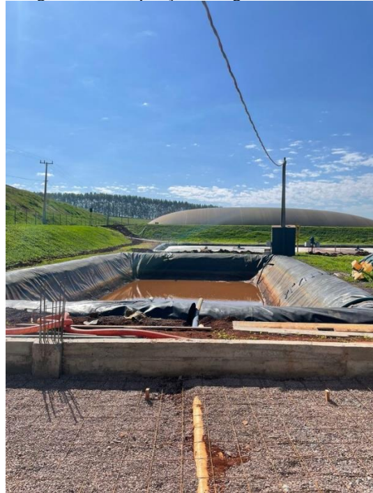
Imagem 31 – Ampliação de lagoas de tratamento
