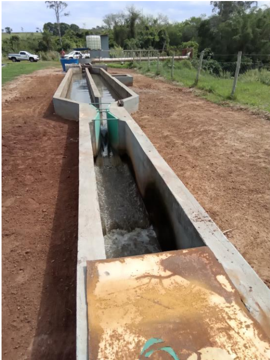
Foto 159 – Caixa de areia + calha parshall
