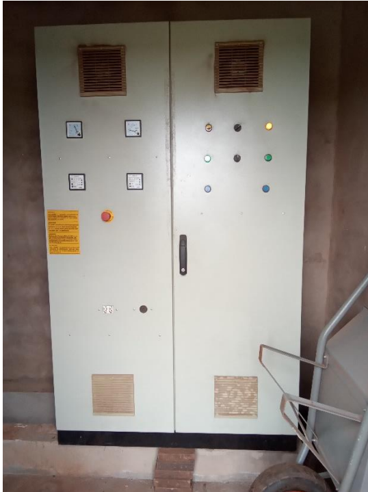
Foto 140 – Quadro de comando
