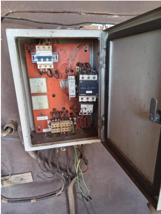
Foto 26 – Quadro de comando aberto
