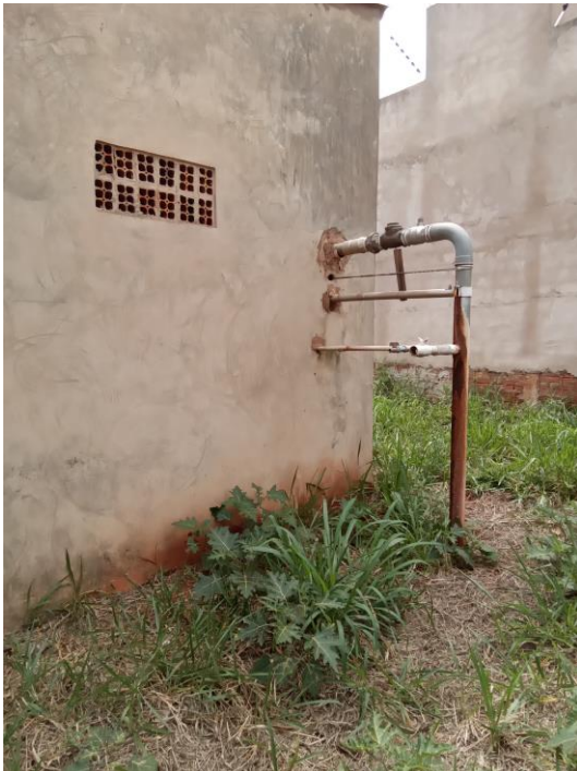
Foto 70 – Saída água tratada
