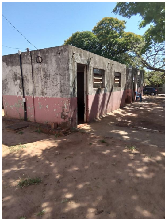
Foto 108 – Casa de máquinas elevatória
