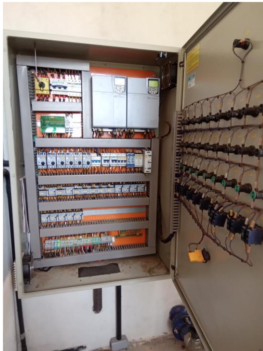
Foto 156 – Quadro de comando aberto
