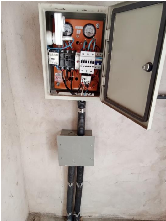
Foto 66 – Quadro de comando aberto
