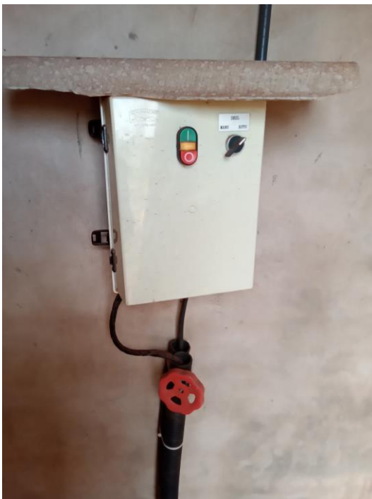
Foto 51 – Quadro de comando
