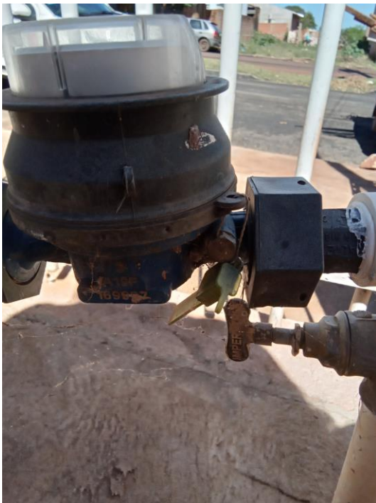
Foto 116 – Identificação hidrômetro P02 (2019)
