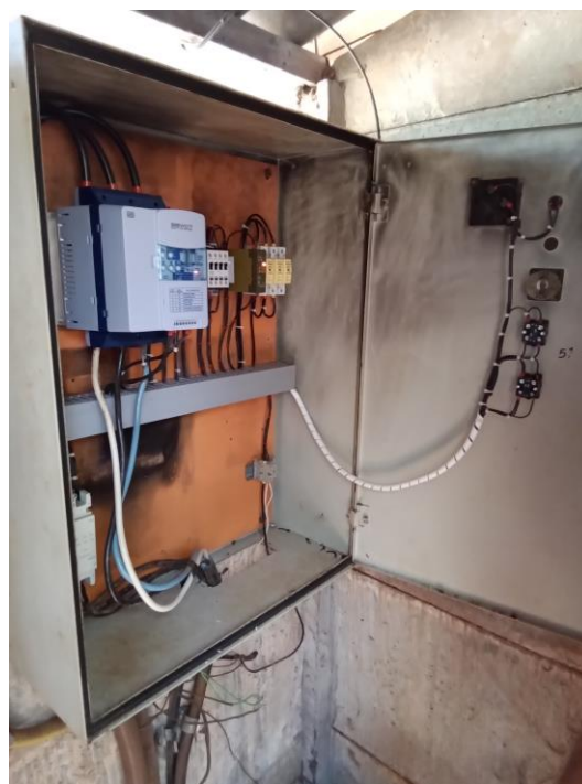
Foto 37 – Quadro de comando aberto
