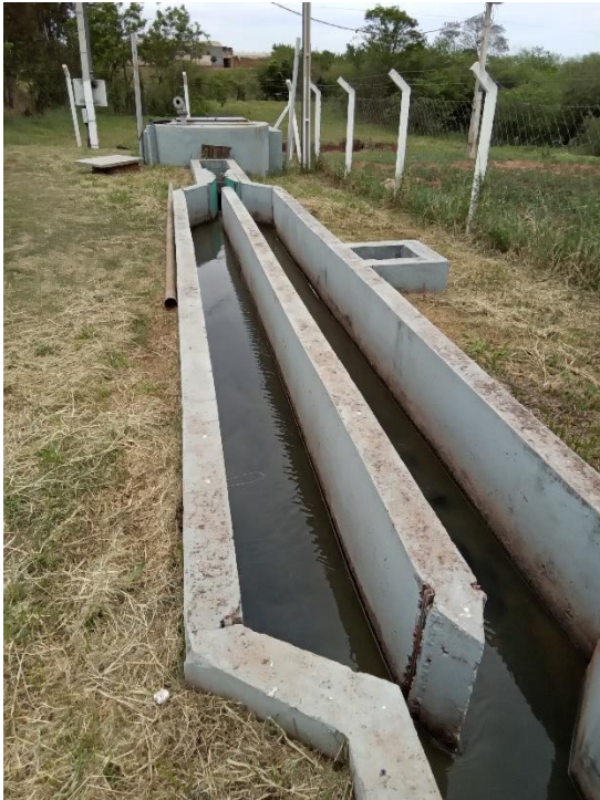
Foto 138 – Caixa de areia
