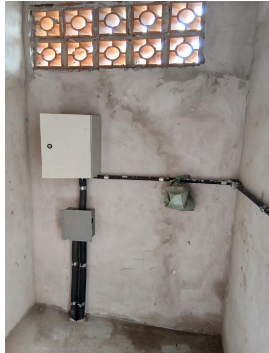
Foto 65 – Quadro de comando
