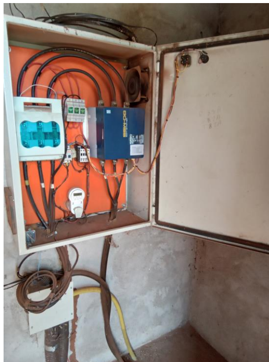
Foto 73 – Quadro de comando aberto
