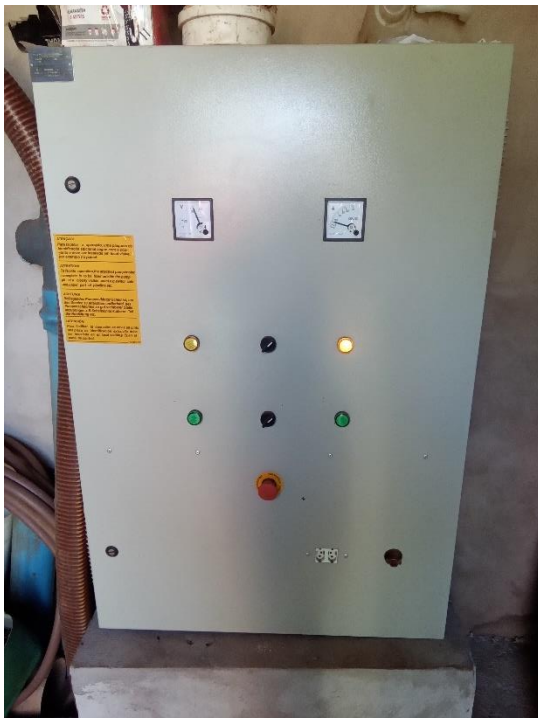
Foto 132 – Quadro de comando
