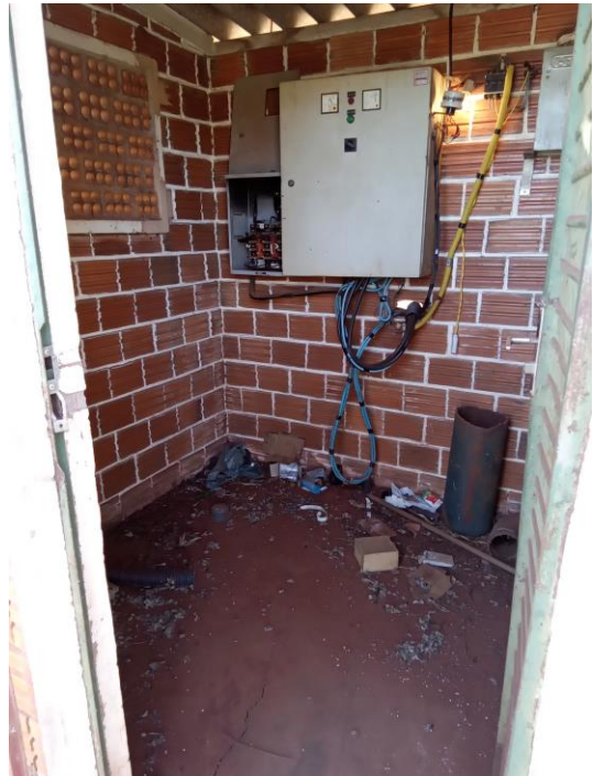
Foto 47 – Quadro de comando
