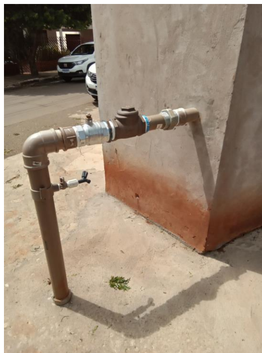
Foto 61 – Saída água tratada
