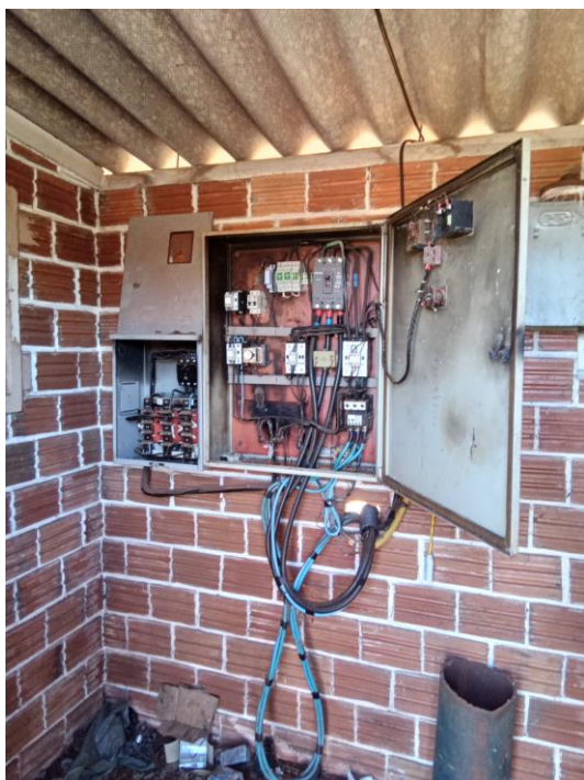
Foto 48 – Quadro de comando aberto
