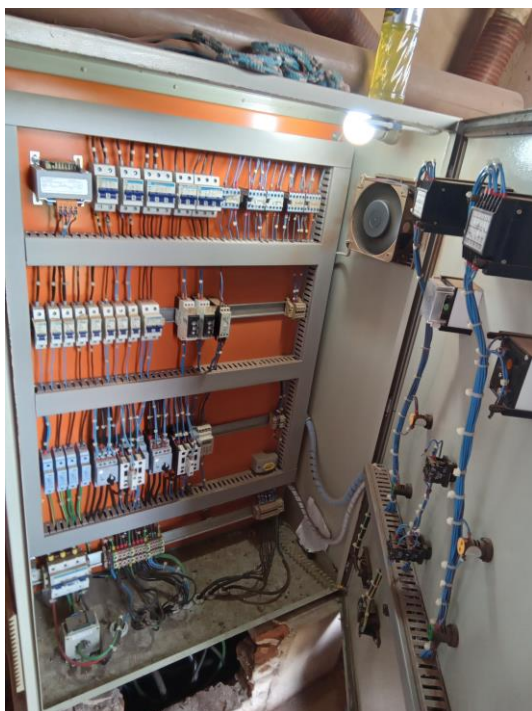
Foto 126 – Quadro de comando aberto
