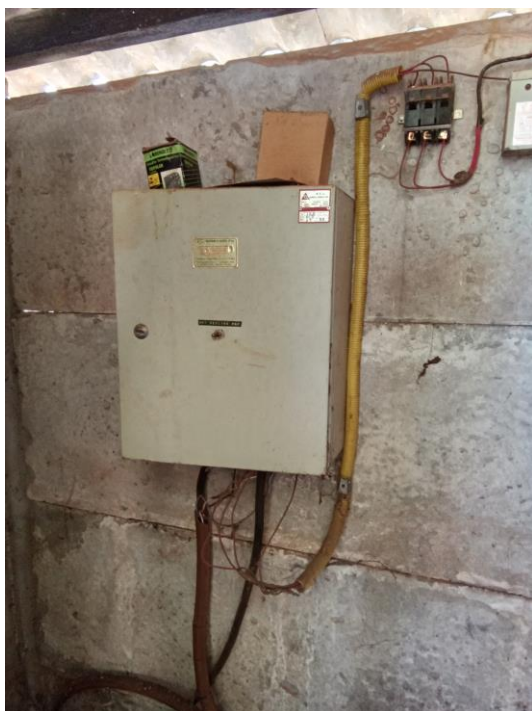
Foto 32 – Quadro de comando fechado
