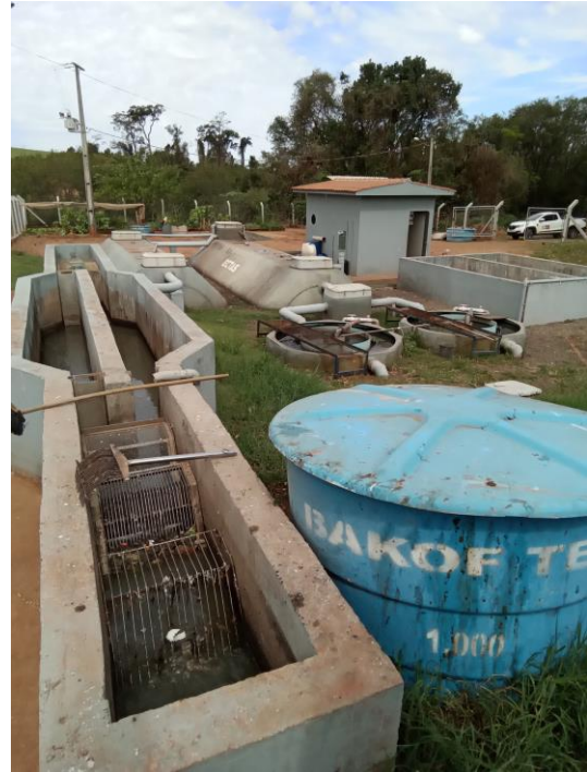
Foto 147 – Estrutura ETE compacta
