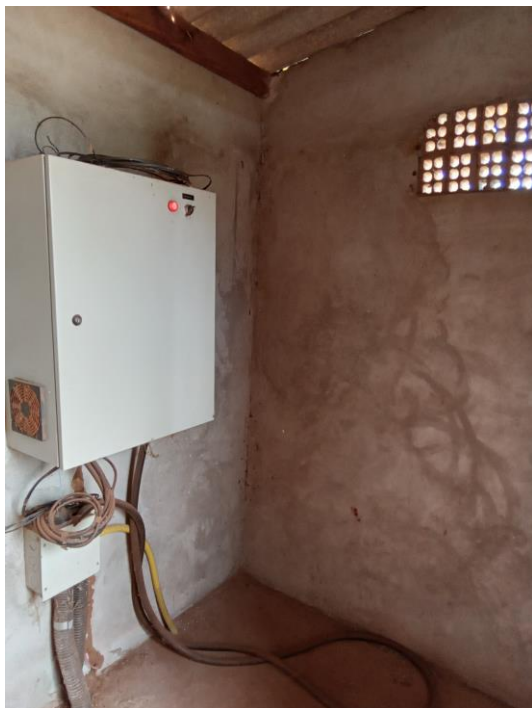
Foto 72 – Quadro de comando
