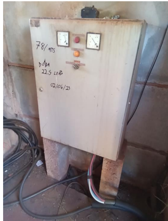
Foto 41 – Quadro de comando
