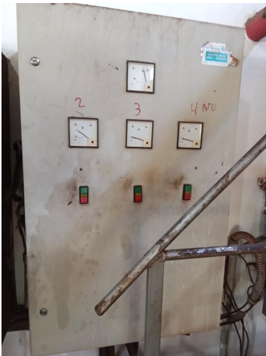
Foto 104 – Quadro de comando
