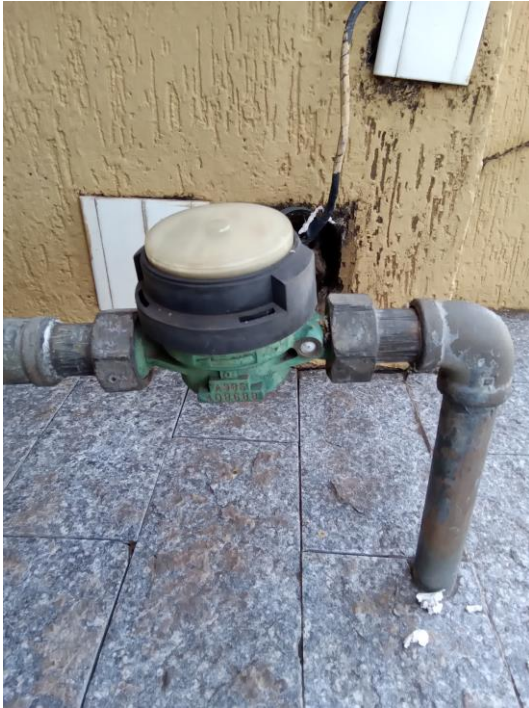
Foto 114 – Identificação hidrômetro P01 (1998)
