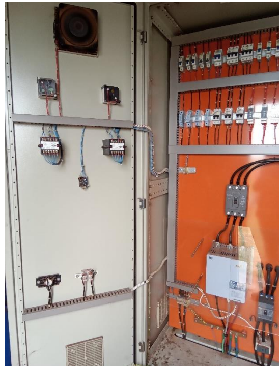
Foto 143 – Quadro de comando aberto
