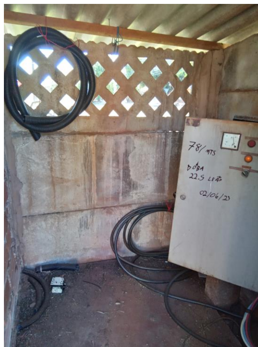
Foto 43 – Entrada de ventilação e iluminação
