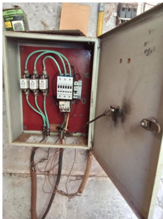
Foto 33 – Quadro de comando aberto
