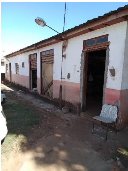
Foto 100 – Casa de máquinas elevatória
