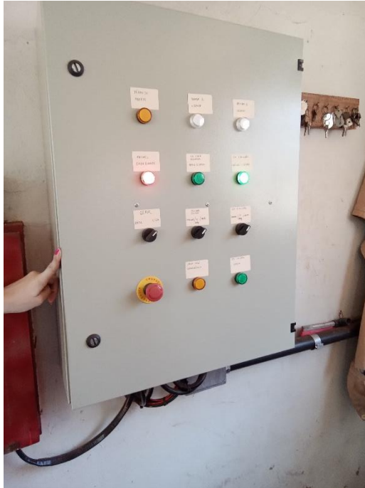
Foto 110 – Quadro de comando
