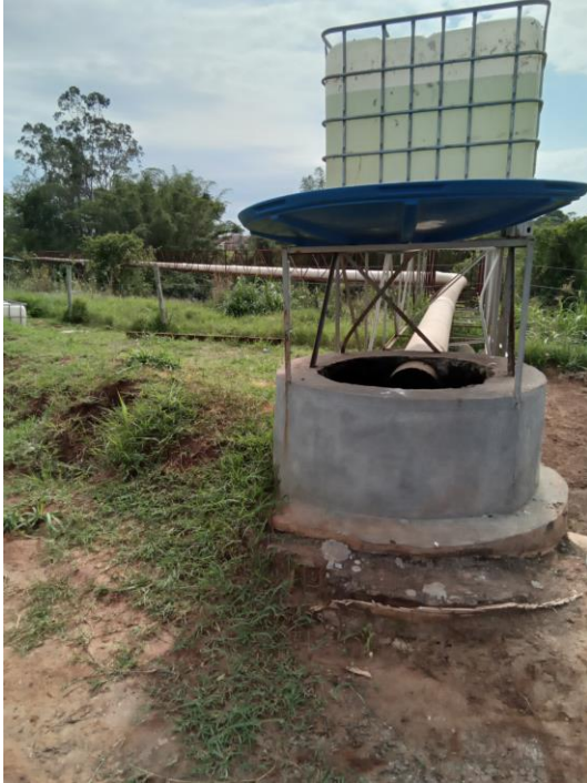
Foto 157 – Caixa de entrada do efluente
