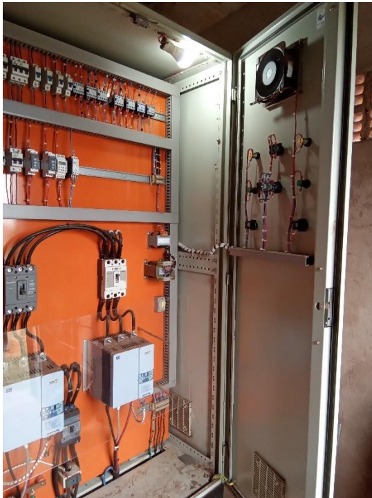
Foto 142 – Quadro de comando aberto
