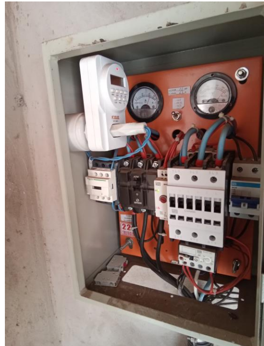
Foto 67 – Quadro de comando aberto
