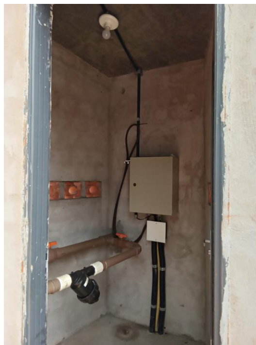
Foto 59 – Quadro de comando
