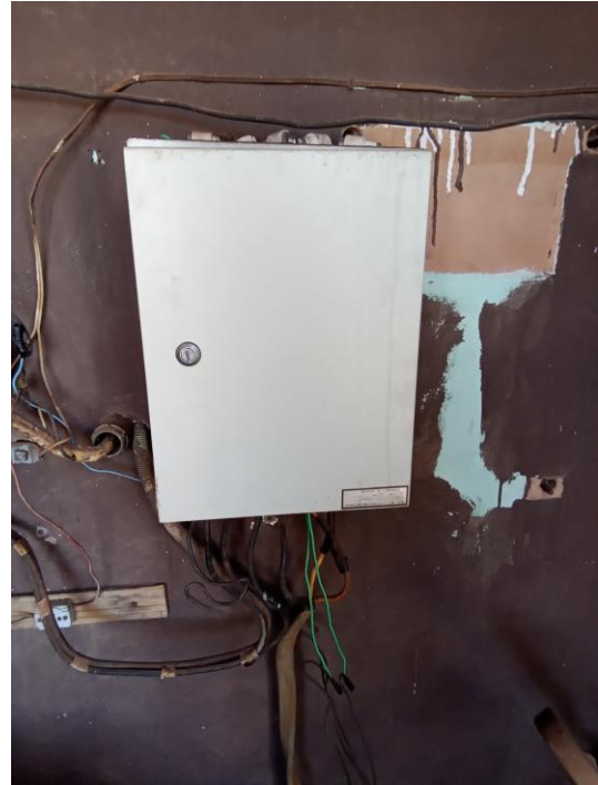
Foto 25 – Quadro de comando
