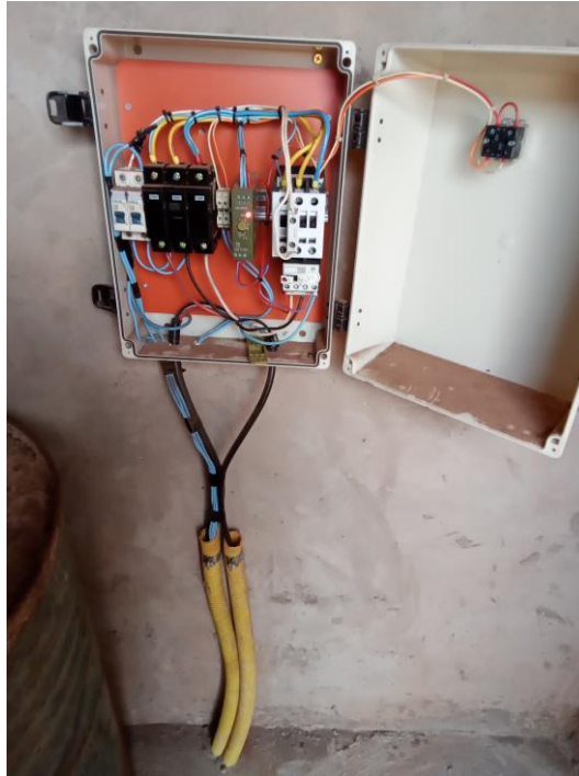
Foto 76 – Quadro de comando aberto
