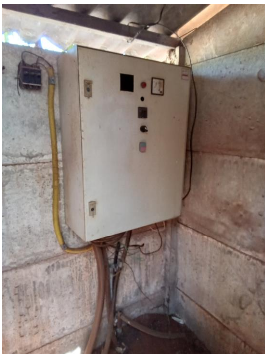
Foto 36 – Quadro de comando
