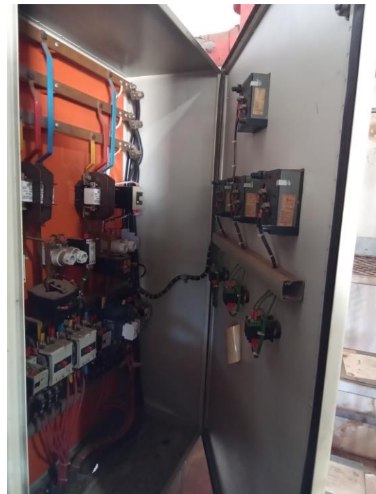
Foto 105 – Quadro de comando aberto
