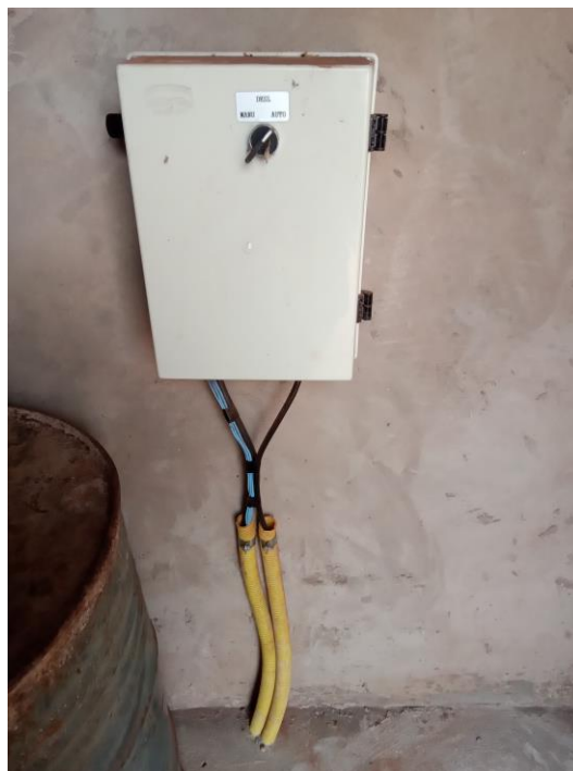
Foto 75 – Quadro de comando
