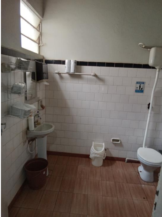
Foto 08 – BWC sem acessibilidade
