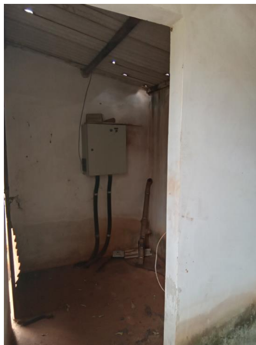
Foto 18 – Quadro de comando
