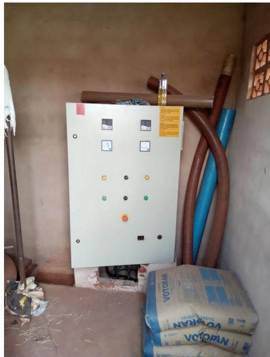
Foto 125 – Quadro de comando
