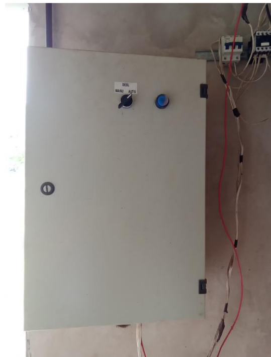
Foto 56 –Quadro de comando
