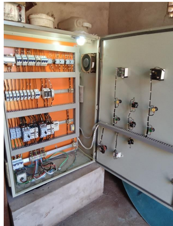
Foto 133 – Quadro de comando aberto
