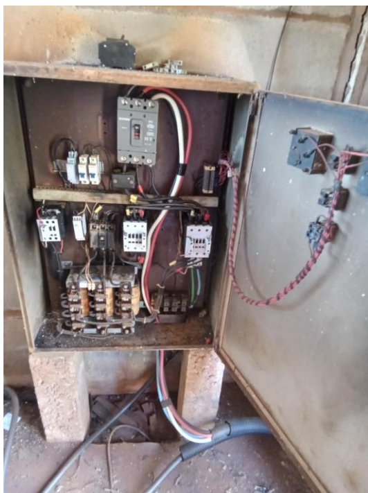
Foto 42 – Quadro de comando aberto
