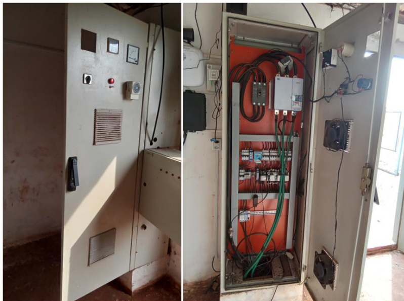
Foto 17 – Quadro de comando (fechado/aberto)
