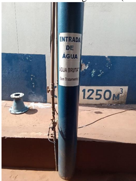
Foto 63 – Adutora de água bruta (Sede)
