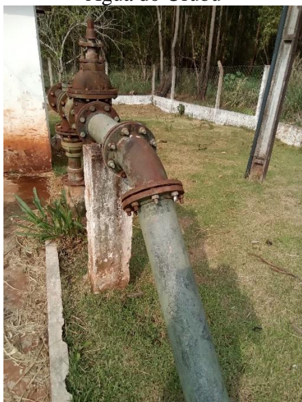
Foto 61 – Adutora de água bruta do poço Água do Urubu
