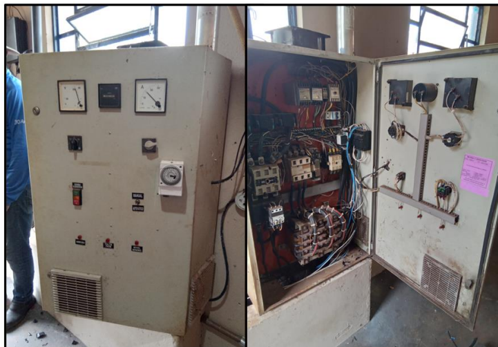
Foto 40 – Quadro de comando (fechado/aberto)
