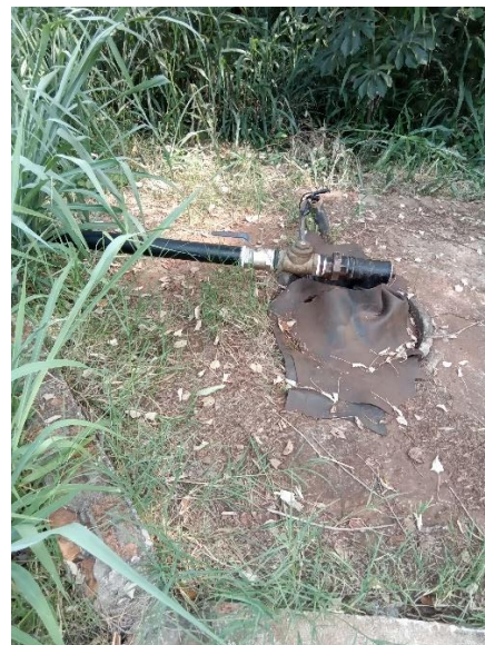
Foto 60 – Adutora de água bruta Mina Água do Óleo
