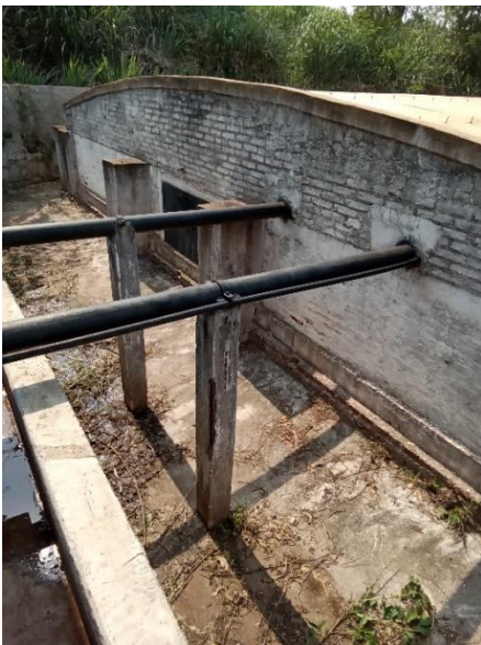
Foto 59 – Adutora de água bruta Mina Água da onça
