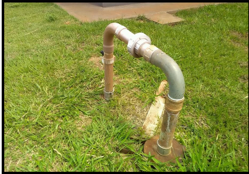
Imagem 4: Barrilete do Poço 1
