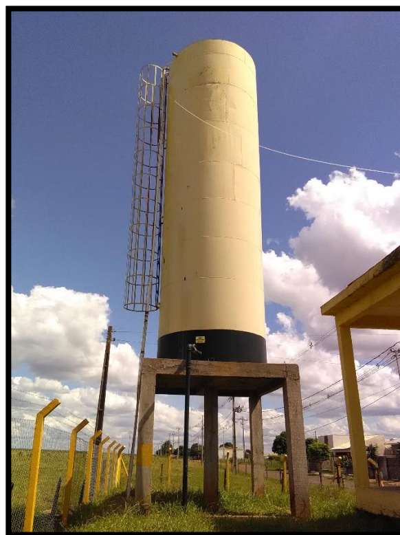
Imagem 19: reservatório elevado de 50m 3 do sistema Bela Vista
