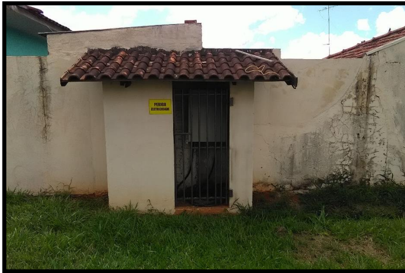
Imagem 5: Abrigo do quadro de comando do Poço 1
