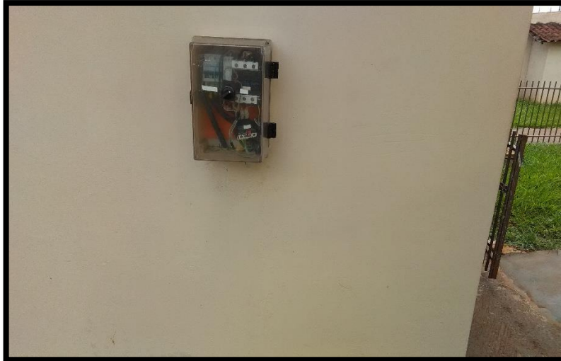
Imagem 7: Quadro de comando do Poço 2
