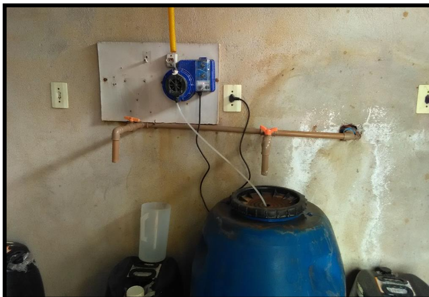
Imagem 13: Unidade de tratamento do reservatório apoiado de 200 m 3
