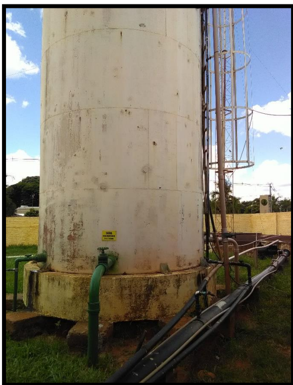
Imagem 18: reservatório de 200m 3
