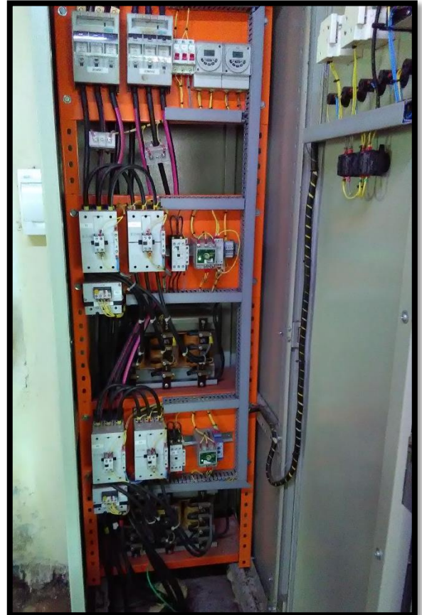
Imagem 22: Quadro de comando da Estação Elevatória
