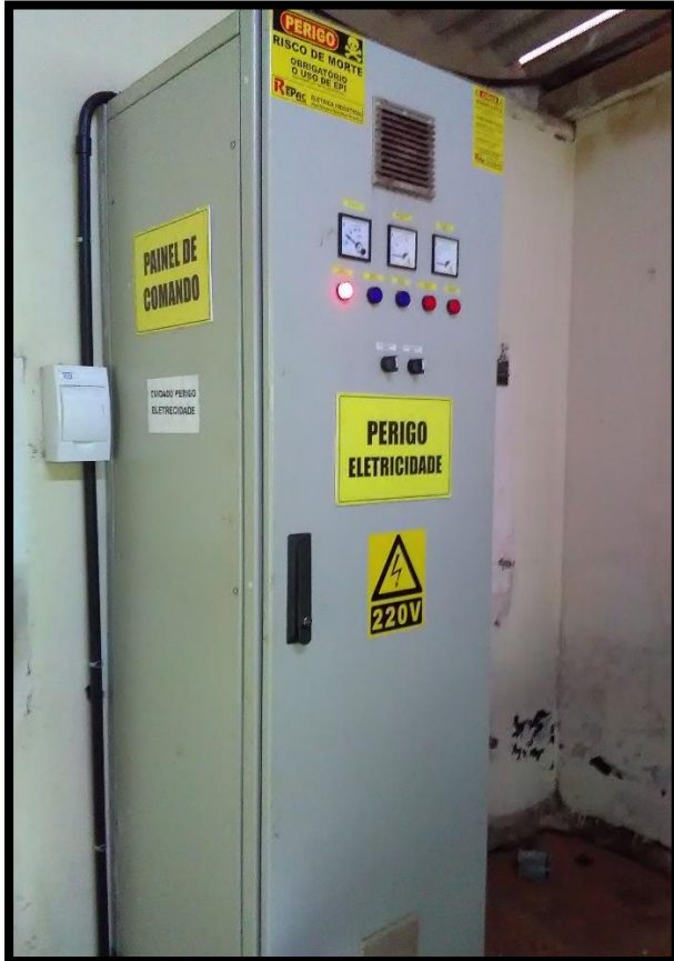
Imagem 21: Quadro de comando da Estação Elevatória
