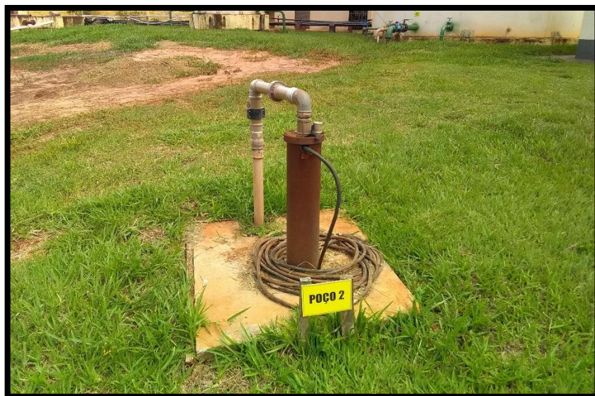
Imagem 6: Barrilete do Poço 2
