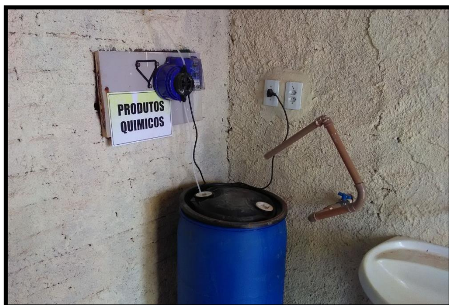
Imagem 14: Unidade de tratamento do reservatório elevado de 50 m 3
