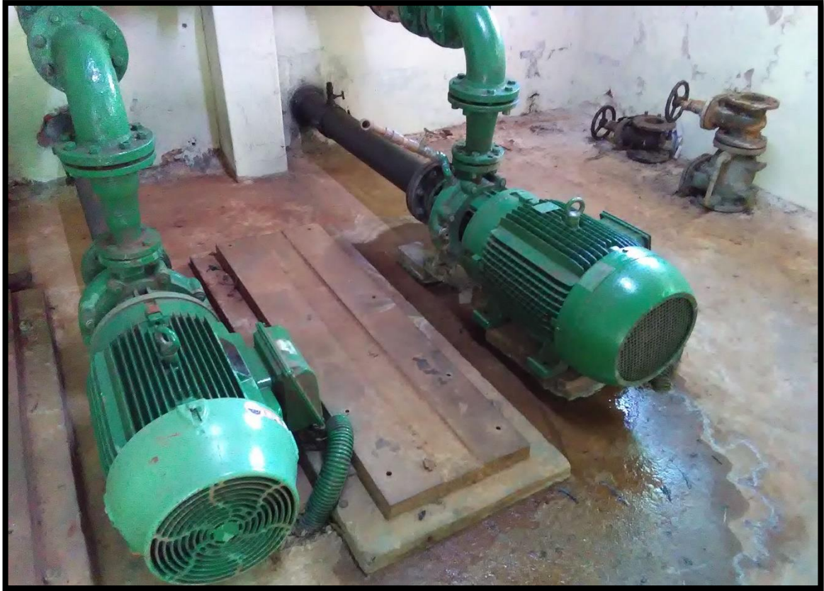
Imagem 20: Conjuntos moto bombas da Estação Elevatória
