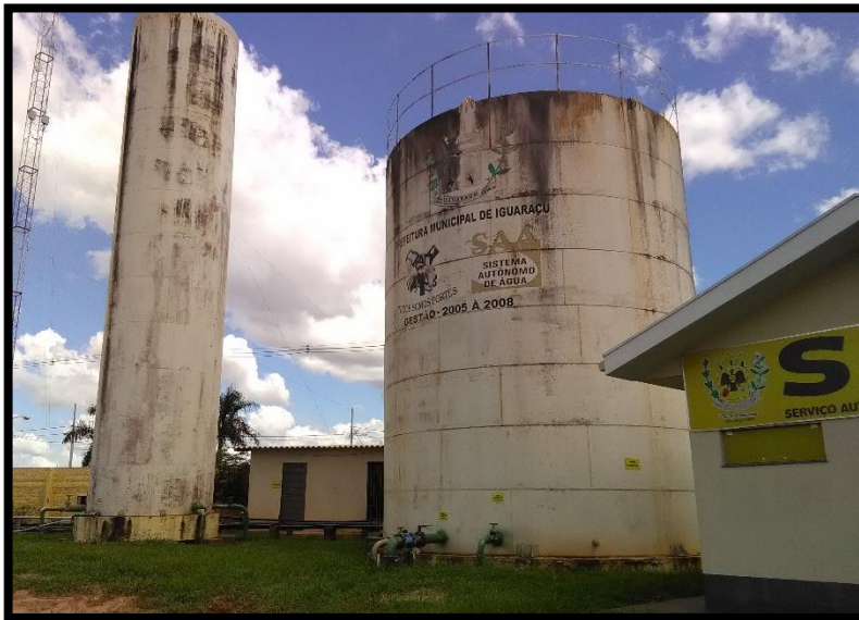
Imagem 15: Reservatórios apoiados da sede
