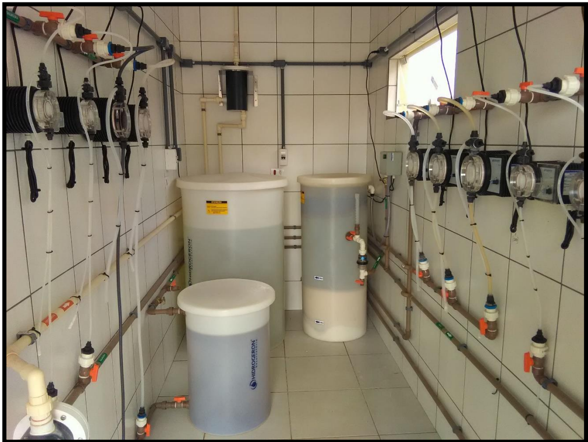
Imagem 12: Unidade de tratamento do reservatório apoiado de 400 m 3
