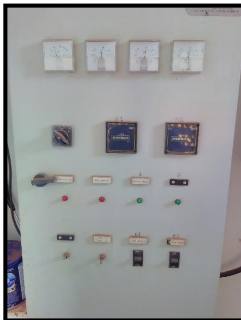
Imagem 12: Quadro de comando da Estação Elevatória
