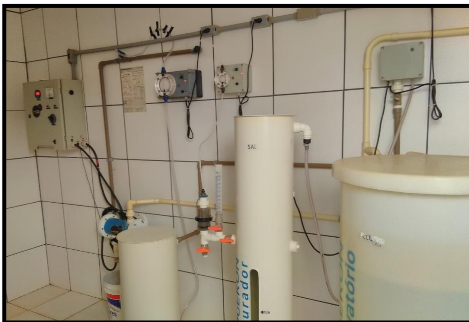
Imagem 5: Estação de tratamento simplificado
