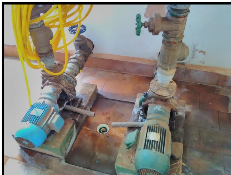
Imagem 11: Conjunto motobomba da Estação Elevatória
