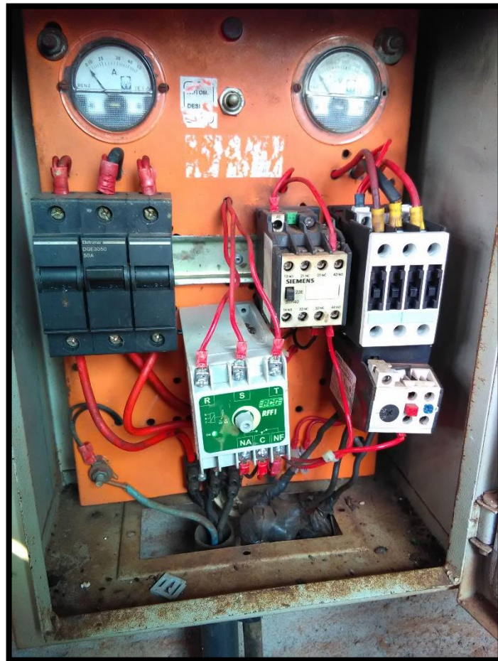
Imagem 4: Quadro de comando do poço
