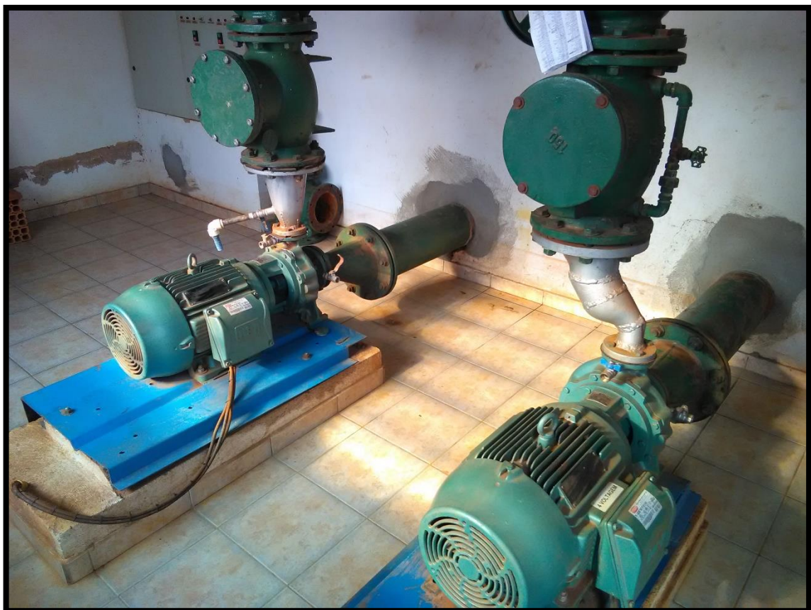
Imagem 12: Conjunto motobombas da EEB
