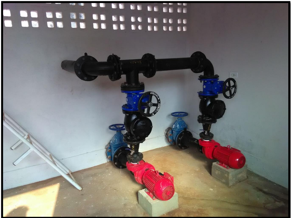
Imagem 14: Conjunto motobombas da EET
