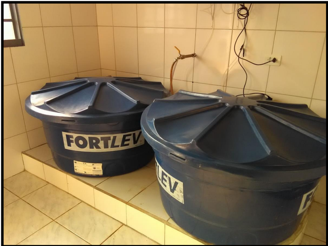
Imagem 6: Reservatórios de Cloro
