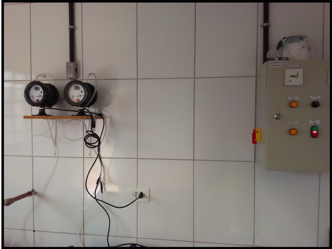
Imagem 7: Bombas dosadoras e quadro de comando
