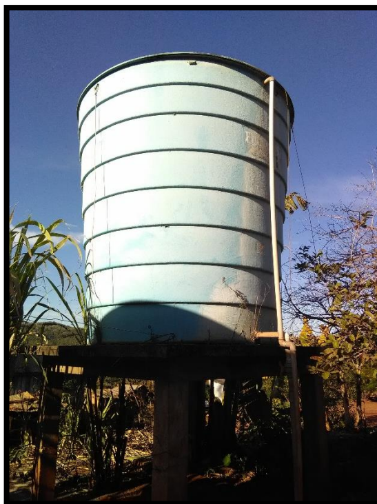
Imagem 21: Reservatório elevado do Distrito Silvolandia
