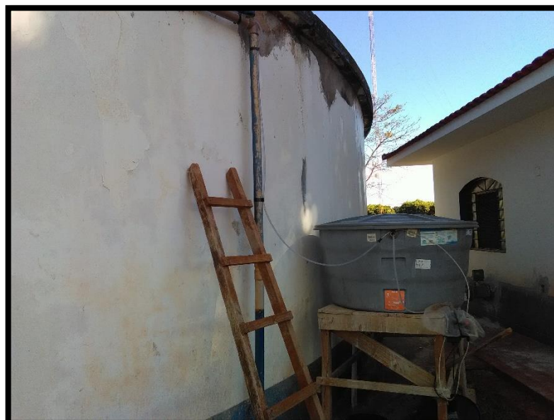
Imagem 8: Reservatório e dosadora de Cloro
