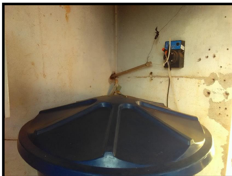
Imagem 20: Unidade de tratamento simplificado do Distrito Silvolandia
