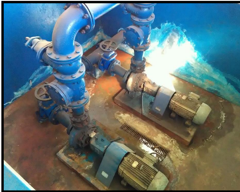
Imagem 13: Estação Elevatória – conjunto motobomba
