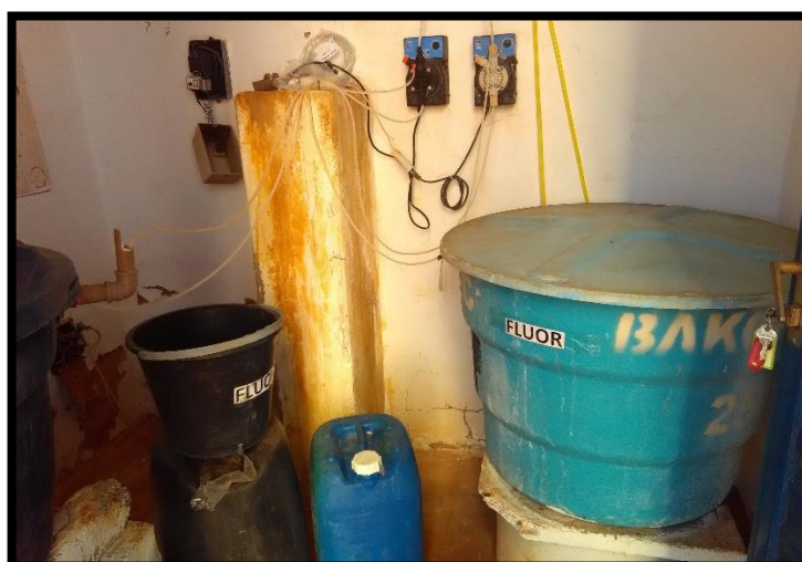
Imagem 18: Estação de tratamento simplificado do Sistema 2
