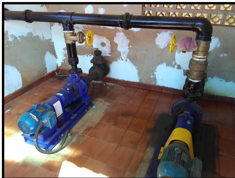
Imagem 15: Conjunto motobomba da Estação Elevatória
