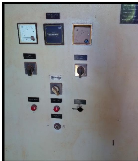
Imagem 8: Quadro de comando do Poço 4
