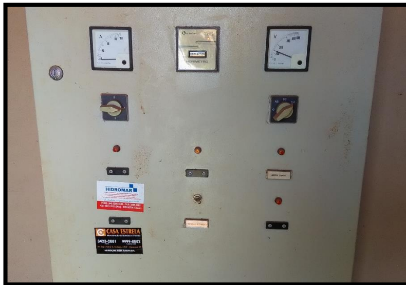
Imagem 4: Quadro de Comando do Poço 1
