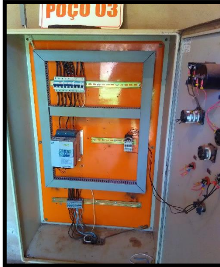
Imagem 6: Quadro de comando do Poço 3
