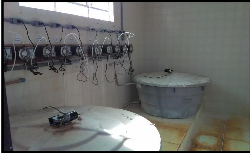
Imagem 10: Estação de tratamento simplificado – Dosadora e reservatórios de Cloro e Flúor
