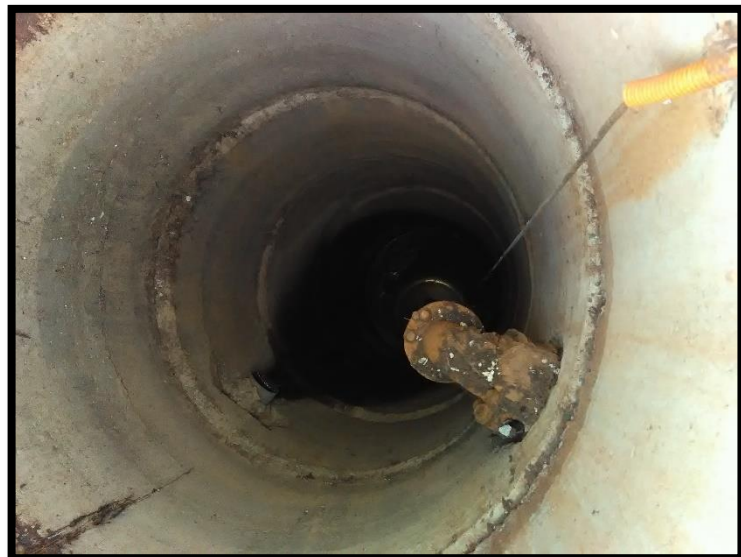
Imagem 29: Estação elevatória de Esgoto 3 – Poço de recalque
