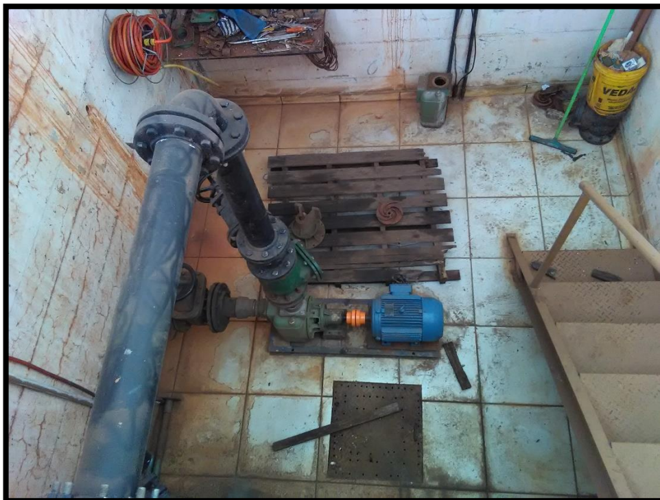
Imagem 26: Estação elevatória de esgoto 1 - Conjunto motobombas
