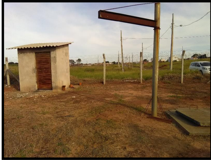
Imagem 30: Estação elevatória de Esgoto 3 – Casa do quadro de comando
