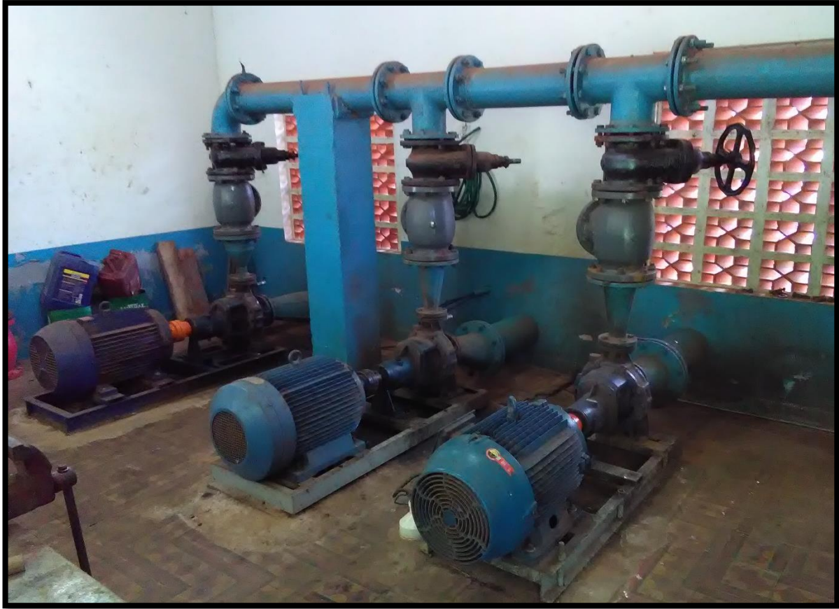
Imagem 19: Estação Elevatória das minas
