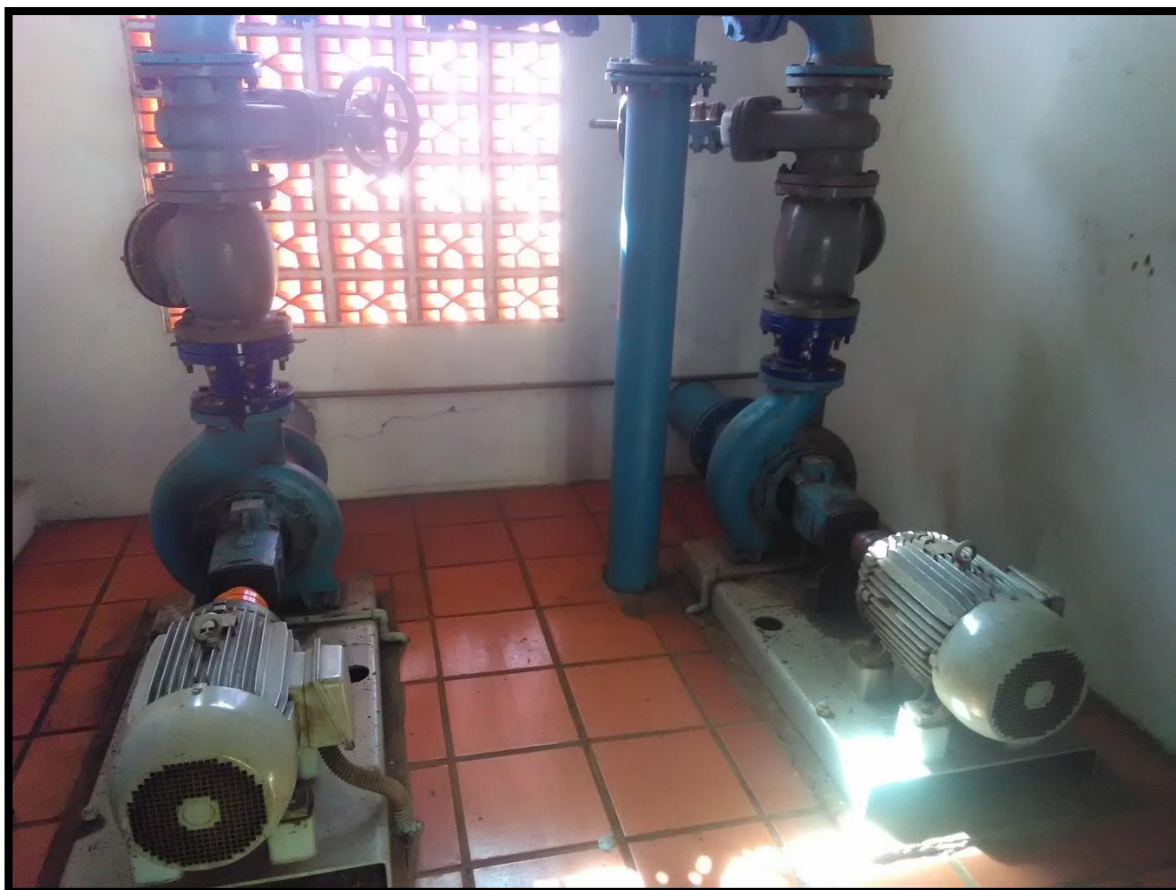
Imagem 21: Estação Elevatória que abastece o REL central
