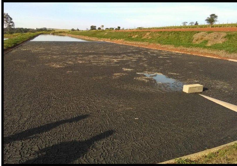
Imagem 33: Estação de Tratamento de Esgoto – Lagoa Anaeróbia
