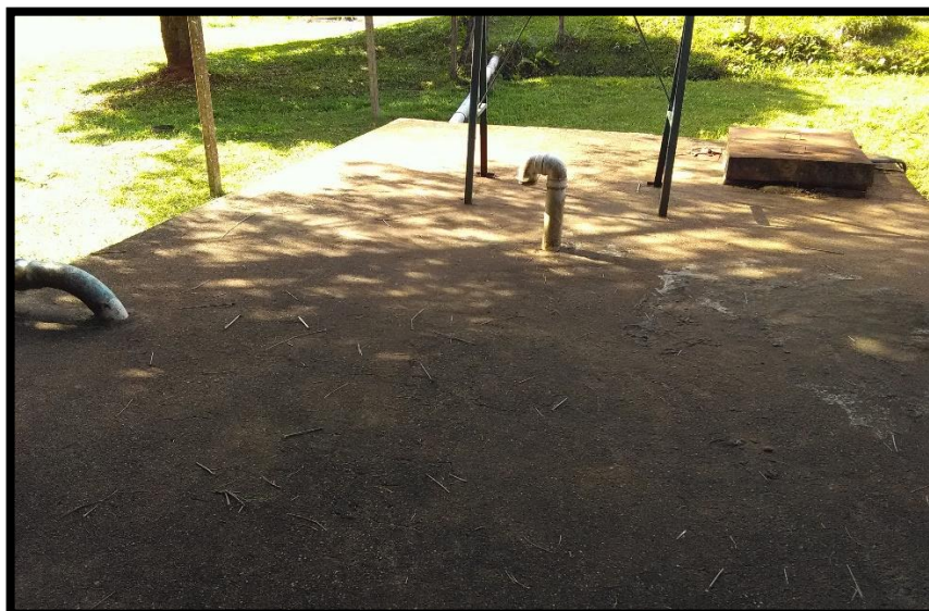
Imagem 9: Reservatório de Recalque das Minas
