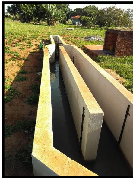
Imagem 31: Estação de Tratamento de Esgoto – Gradeamento, Desarenador e Calha Parshall
