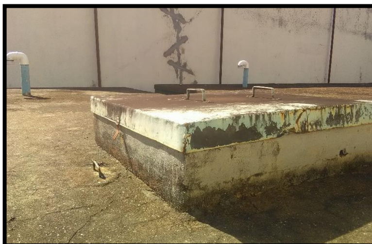
Imagem 14: Reservatórios semienterrados – RES 2
