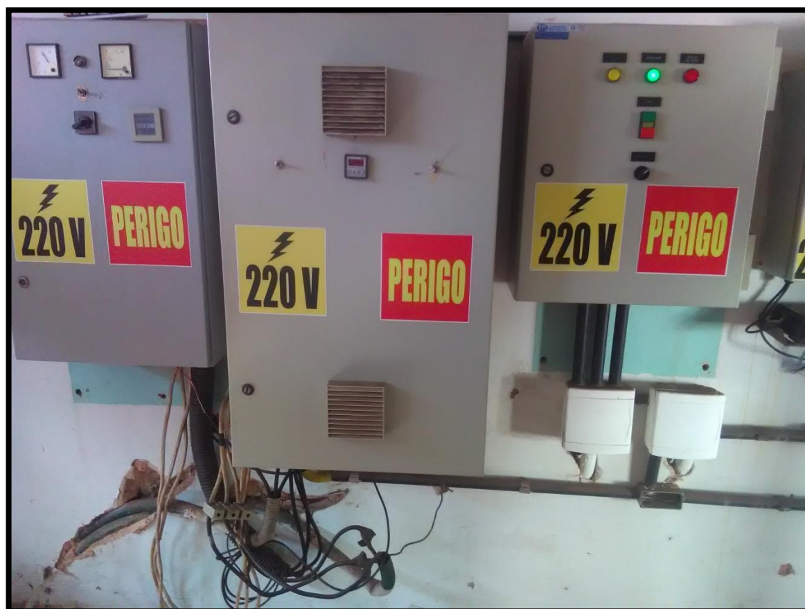
Imagem 22: Estação Elevatória que abastece o REL central – quadros de comando
