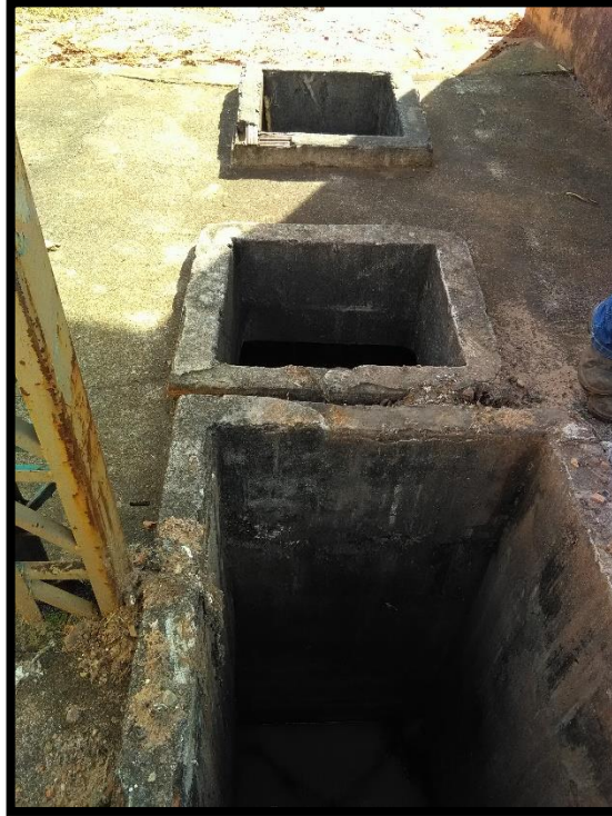
Imagem 25: Estação elevatória de esgoto 1 – reservatório de recalque
