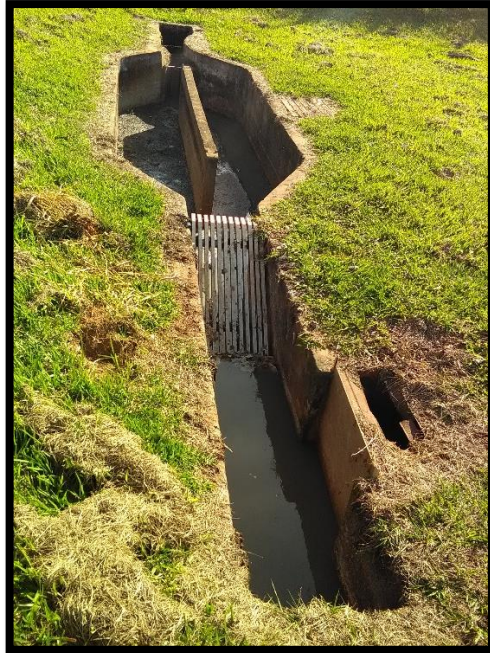
Imagem 27: Estação elevatória de esgoto 2 – Gradeamento e desarenador
