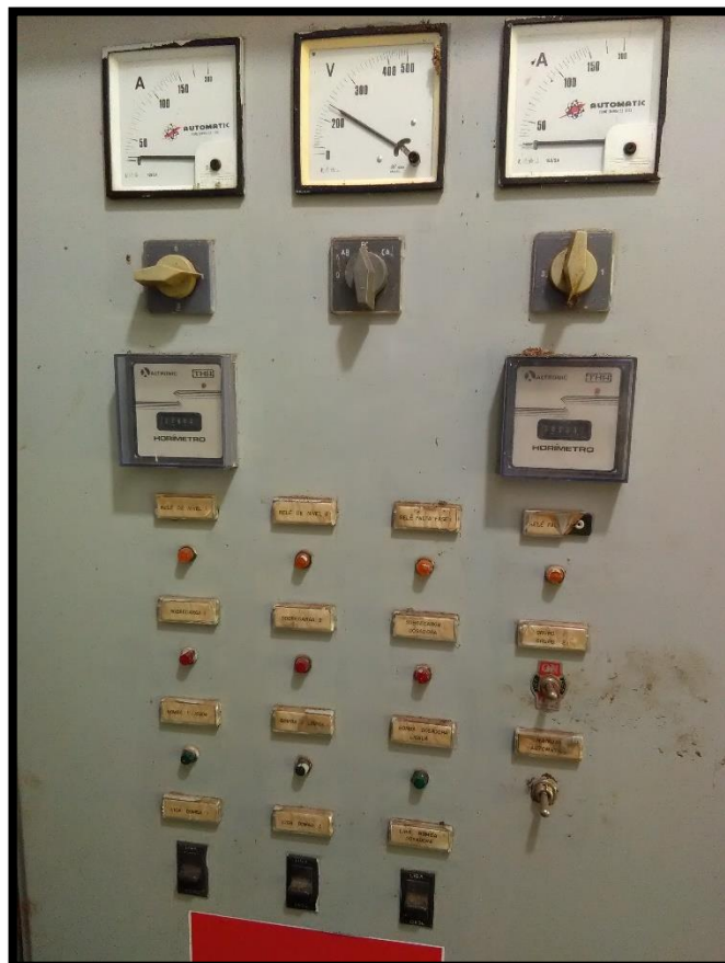
Imagem 20: Estação Elevatória das minas – quadro de comando
