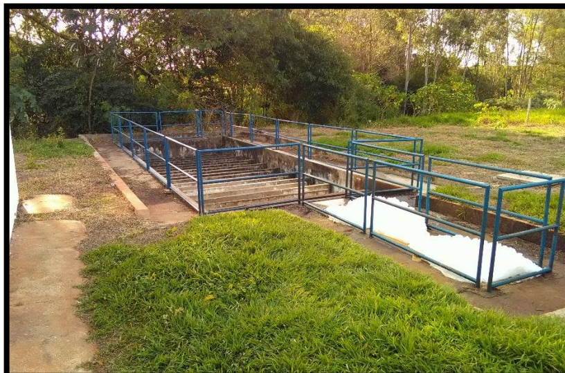
Imagem 34: Estação de Tratamento de Esgoto – Medidor de Vazão de saída e cloração
