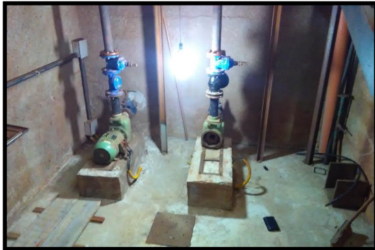
Imagem 28: Estação elevatória de Esgoto 2 – Conjunto Motobombas
