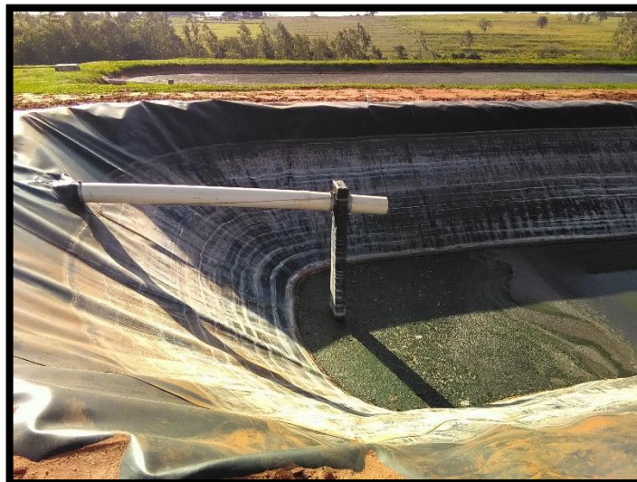
Imagem 32: Estação de Tratamento de Esgoto – Lagoa Anaeróbia nova
