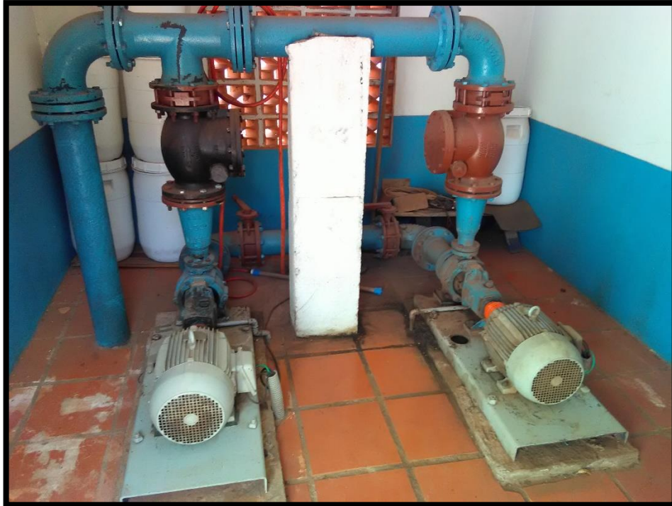
Imagem 23: Estação Elevatória que abastece a rede e reservatórios de apoio
