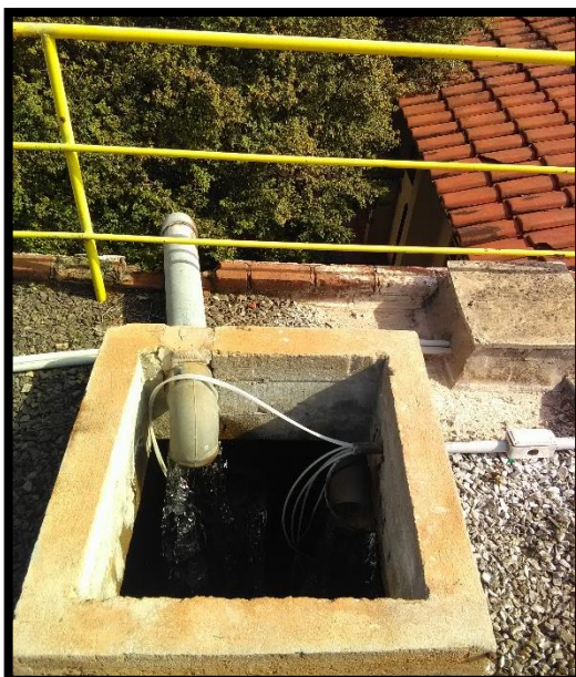
Imagem 13: Reservatório semienterrado – RES 1
