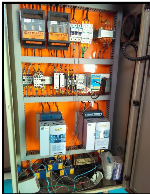
Imagem 24: Estação Elevatória que abastece a rede e reservatórios de apoio – quadro de comando
