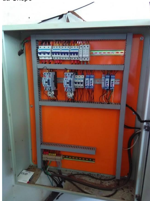
Foto 57 – Quadro de comando elevatória poço da Crispe
