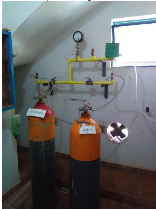
Foto 33 – Tanques de cloro gás
