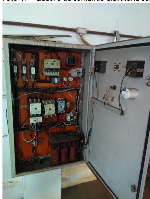
Foto 47 – Quadro de comando elevatória sede
