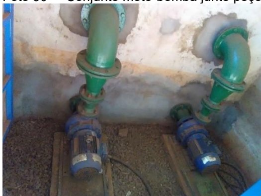
Foto 50 – Conjunto moto-bomba junto poço 02
