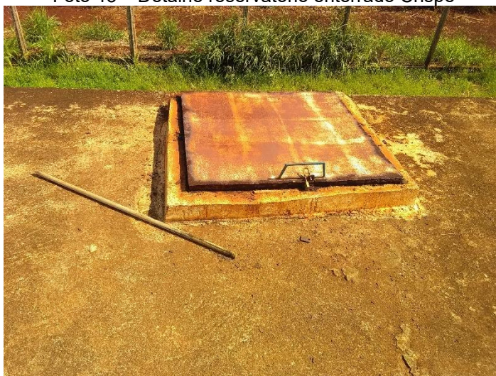
Foto 43 – Detalhe reservatório enterrado Crispe
