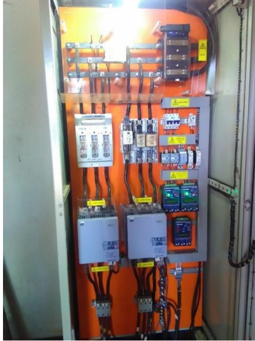
Foto 70 – Quadro de comando da ETE
