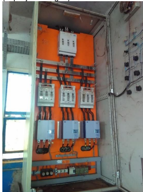
Foto 45 – Quadro de comando elevatória (captação de água)
