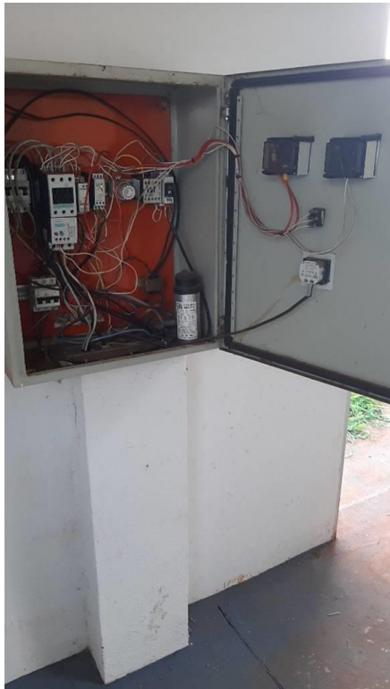
Foto 56 – Quadro de comando da elevatória do poço 03
