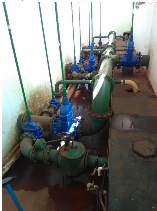
Foto 31 – Bombas da ETA
