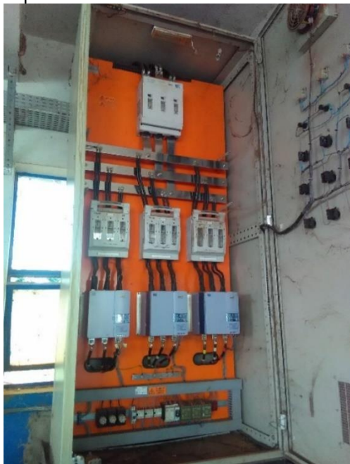
Foto 08 – Quadro de comando captação de água superficial
