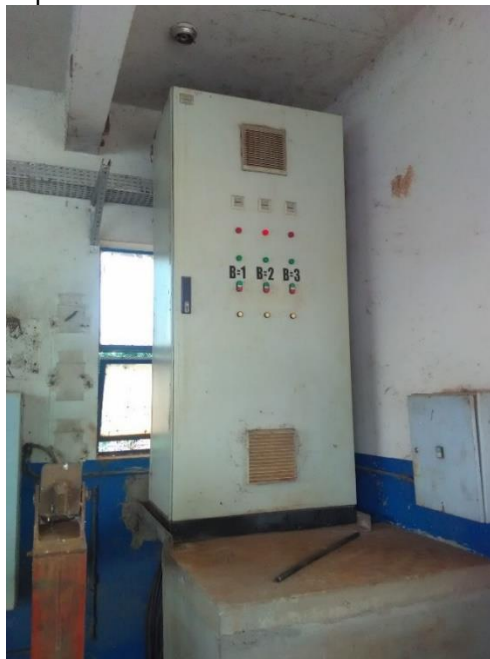
Foto 09 – Frente do quadro de comando captação superficial
