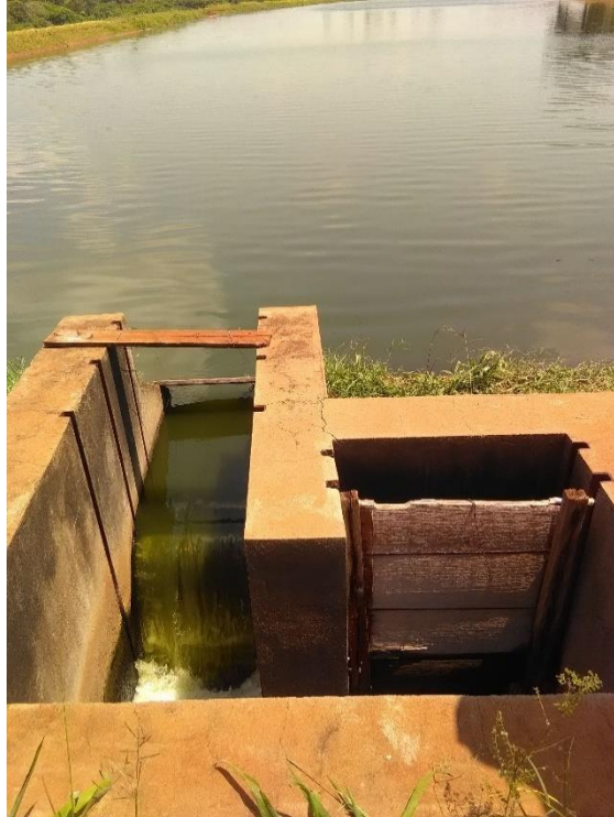
Foto 72 – Dispositivo de saída da lagoa facultativa
