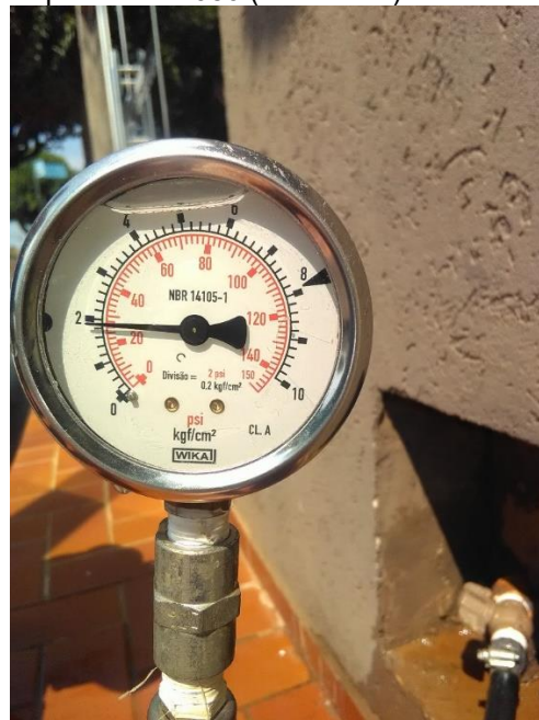
Foto 62 – Medição pressão na rede: Rua João Siqueira nº. 1080 (P=24 mca)
