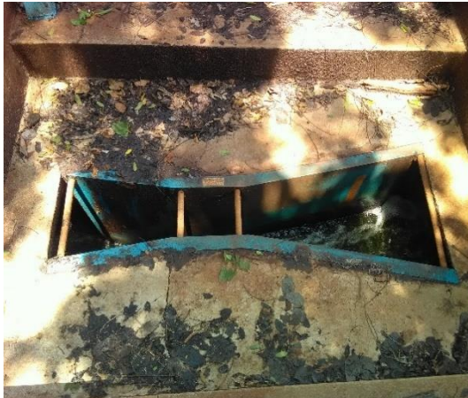
Foto 71 – Calha Parshall da ETE
