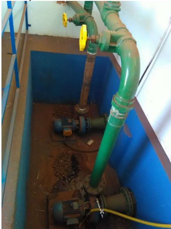
Foto 58 – Conjunto moto bombas do sistema elevatório Crispe
