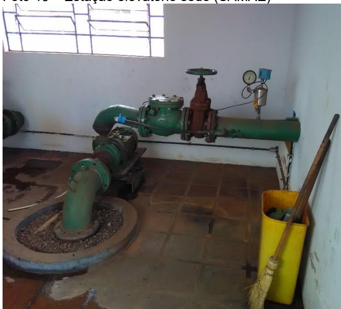
Foto 46 – Estação elevatório sede (SAMAE)
