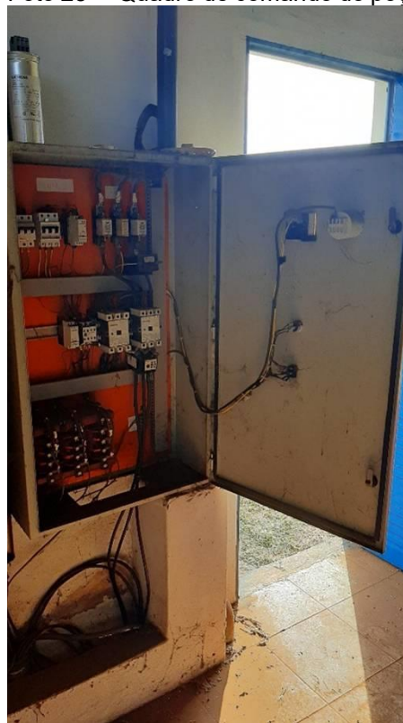
Foto 25 – Quadro de comando do poço Bela Vista
