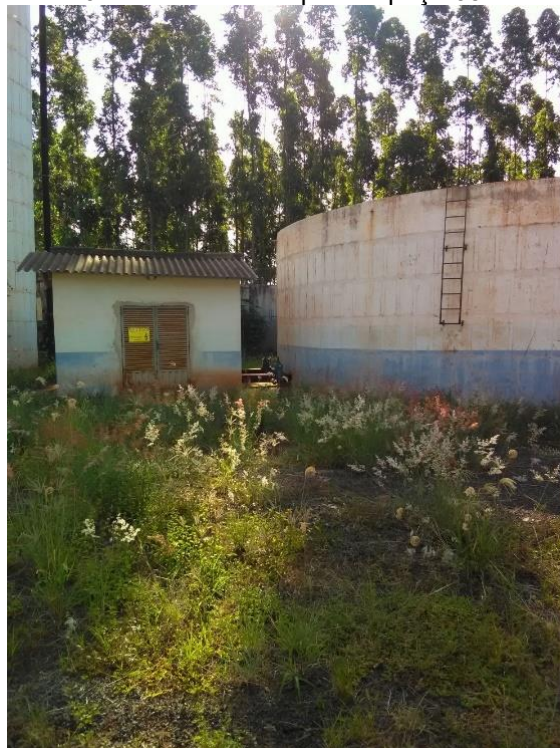
Foto 40 – Reservatório apoiado poço 05
