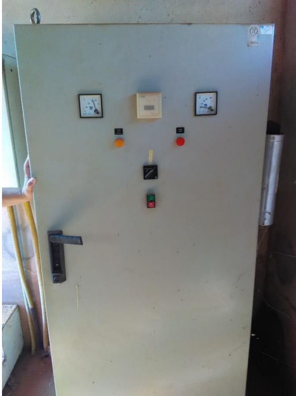
Foto 16 – Frente quadro de comando poço 02
