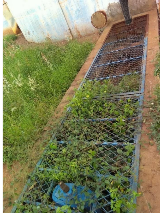
Foto 21 – Cavalete do poço 04
