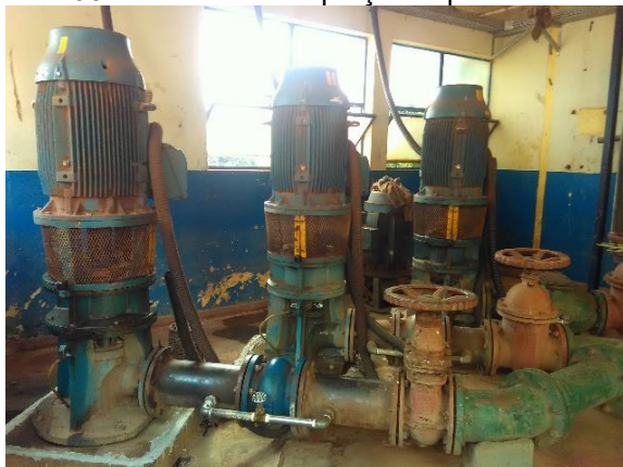
Foto 06 – Bombas da captação superficial
