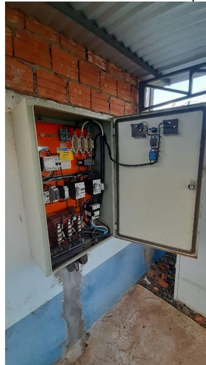
Foto 23 – Quadro de comando poço 05
