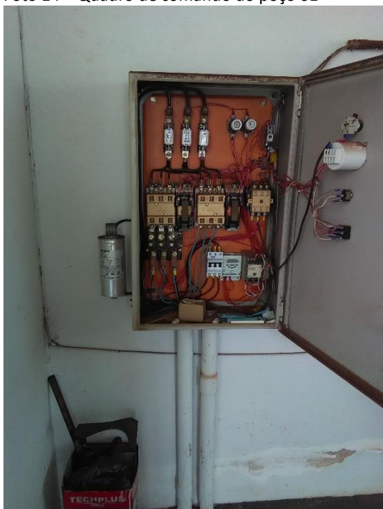
Foto 14 – Quadro de comando do poço 01
