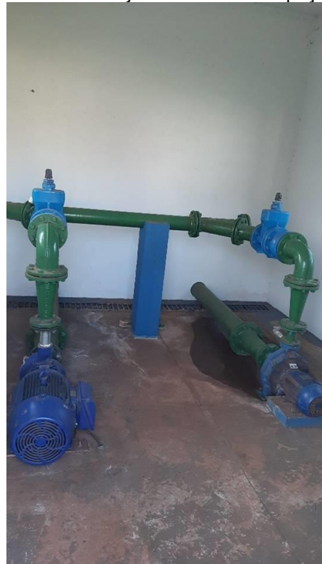
Foto 55 – Conjunto moto-bomba poço 03
