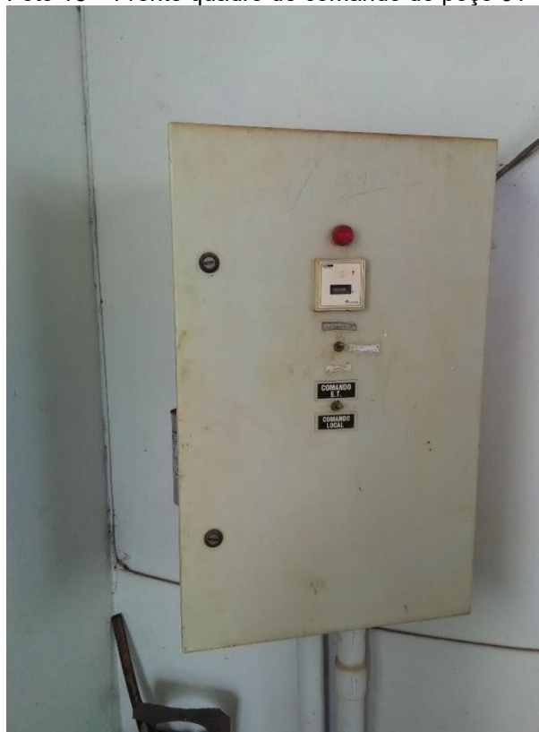
Foto 13 – Frente quadro de comando do poço 01
