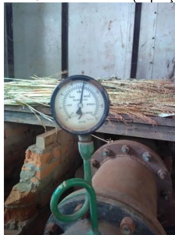
Foto 07 – Manômetro (captação superficial)
