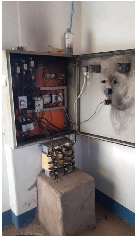
Foto 19 – Quadro de comando poço 03
