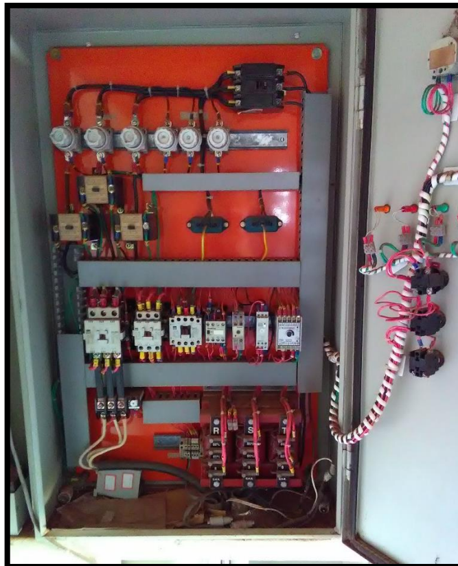
Imagem 2: Quadro de comando do poço da sede
