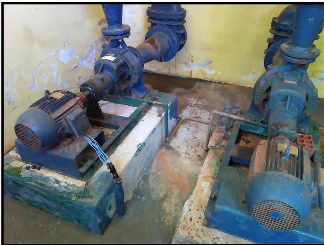
Imagem 15: Conjunto moto bombas do sistema sede
