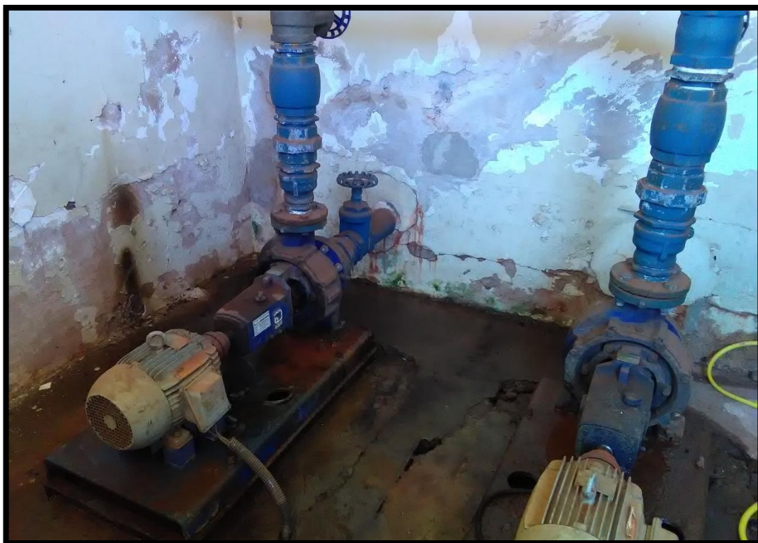
Imagem 17: Conjunto moto bombas do sistema sede
