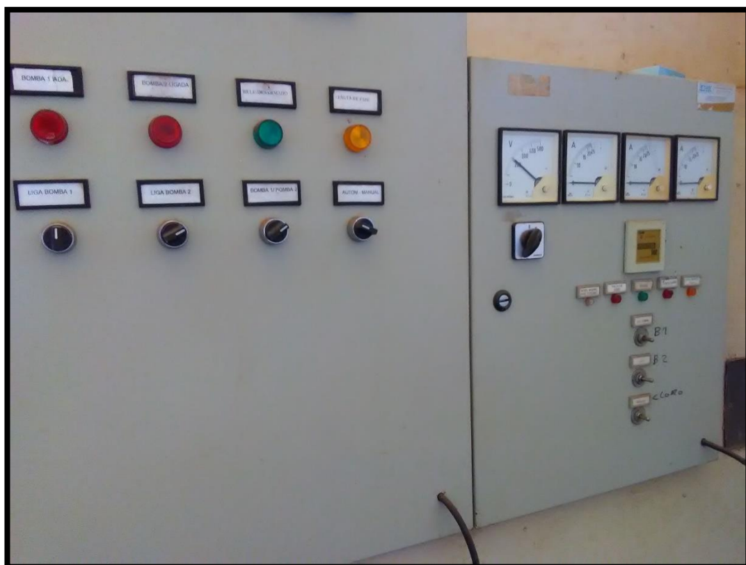
Imagem 18: Conjunto moto bombas do sistema sede
