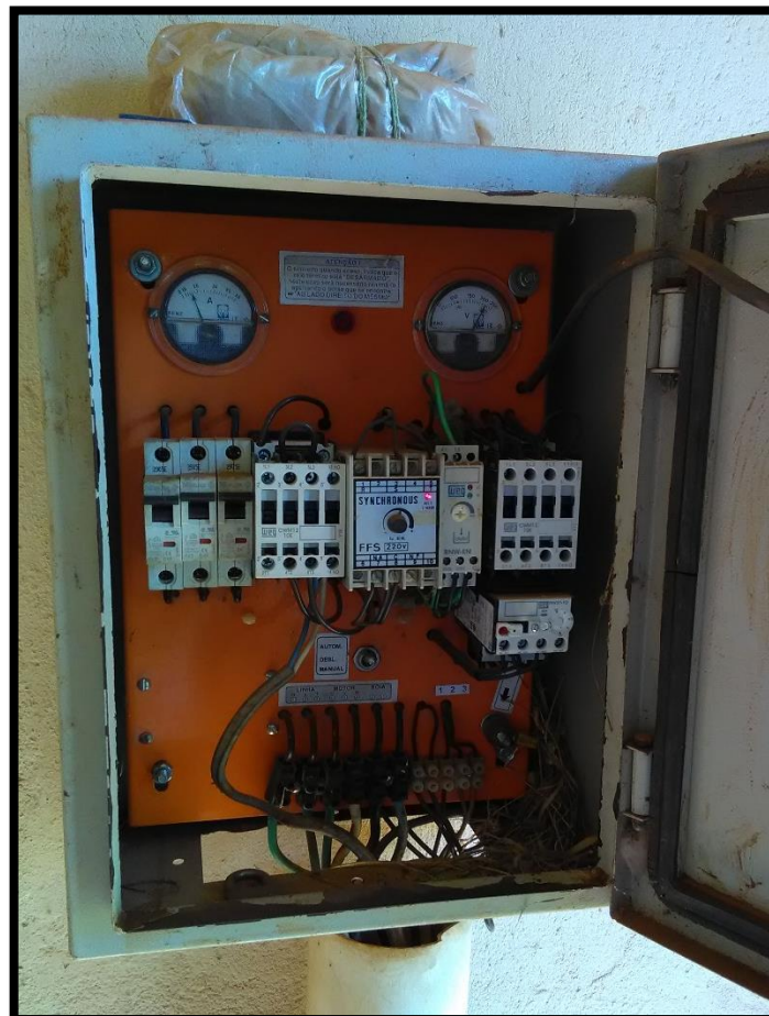
Imagem 4: Quadro de comando do Poço do distrito
