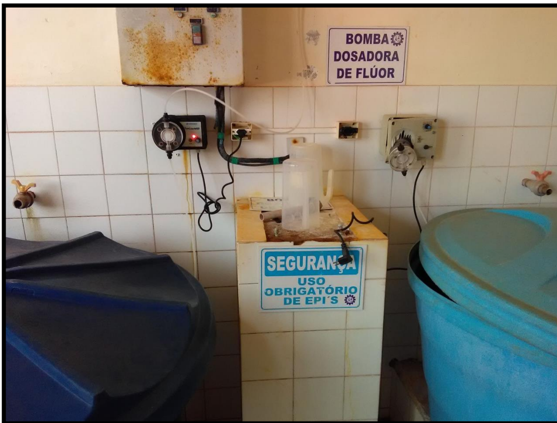
Imagem 5: Unidade de tratamento da Sede
