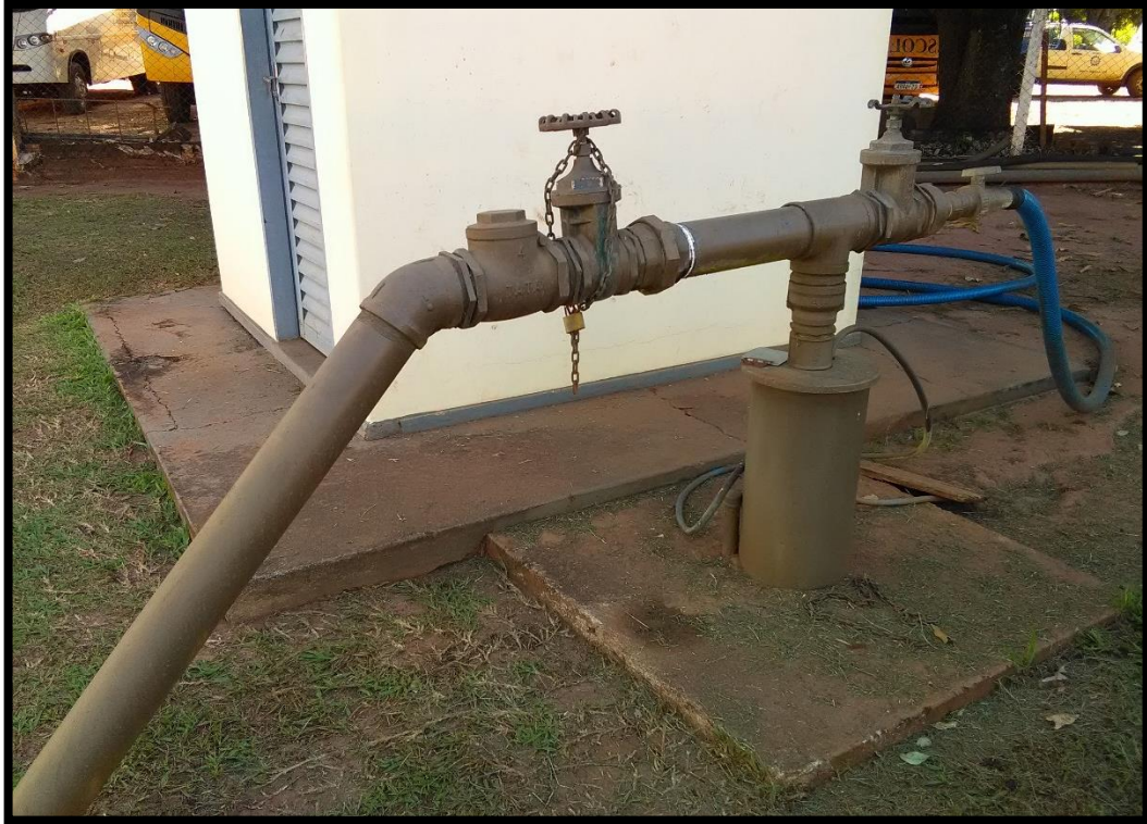
Imagem 1: Poço do sistema Sede
