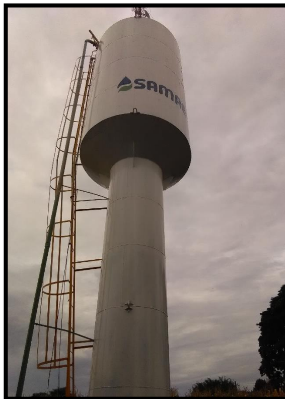
Imagem 23: Reservatório elevado do distrito Nossa Senhora Aparecida
