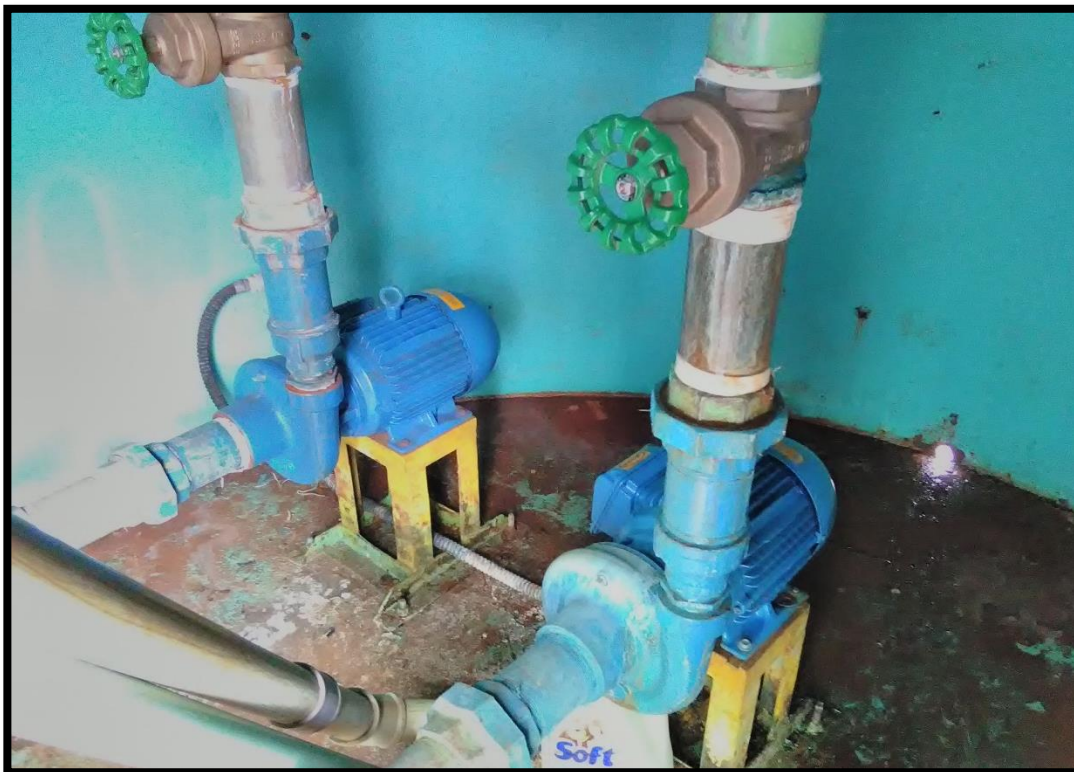
Imagem 29: Conjunto moto bombas da Estação Elevatória de Água do bairro Americana
