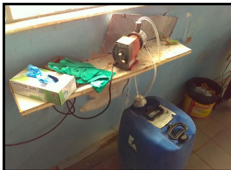
Imagem 19: Unidade de simples cloração do Distrito Nossa Senhora Aparecida
