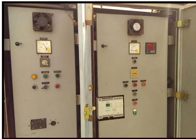
Imagem 7: Quadro de comando do Poço Ivai
