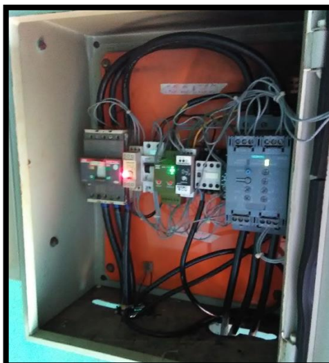
Imagem 9: Quadro de comando do poço americana
