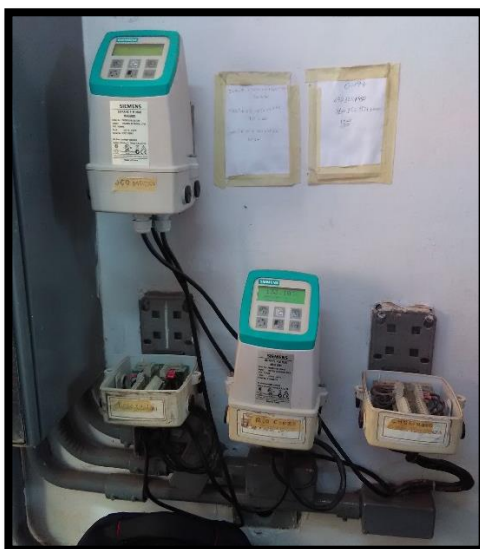
Imagem 12: ETA - Medidores de vazão da captação
