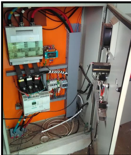
Imagem 5: Quadro de comando do poço major
