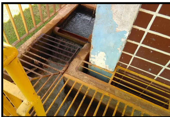
Imagem 13: ETA - Entrada da água bruta
