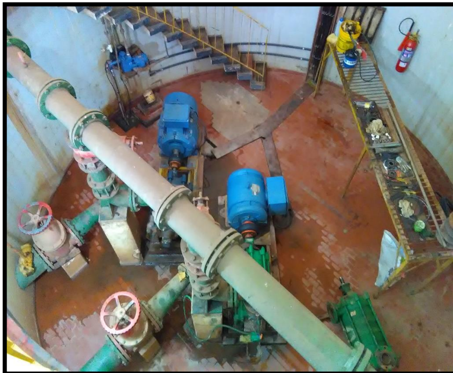
Imagem 25: Conjuntos moto bombas da Estação Elevatória de Água Bruta
