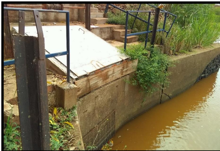
Imagem 3: Captação Superficial no rio das cinzas
