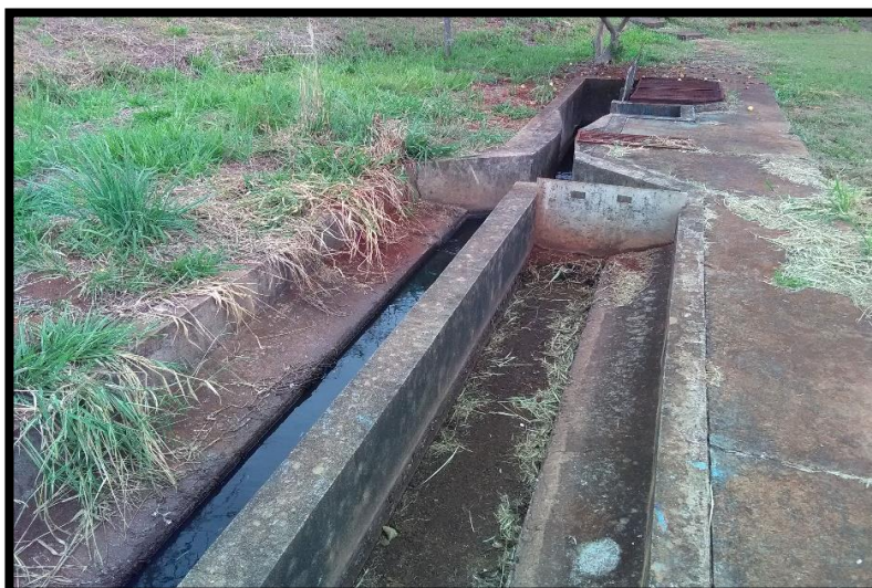
Imagem 38: Caixa de Areia – ETE Barrerão
