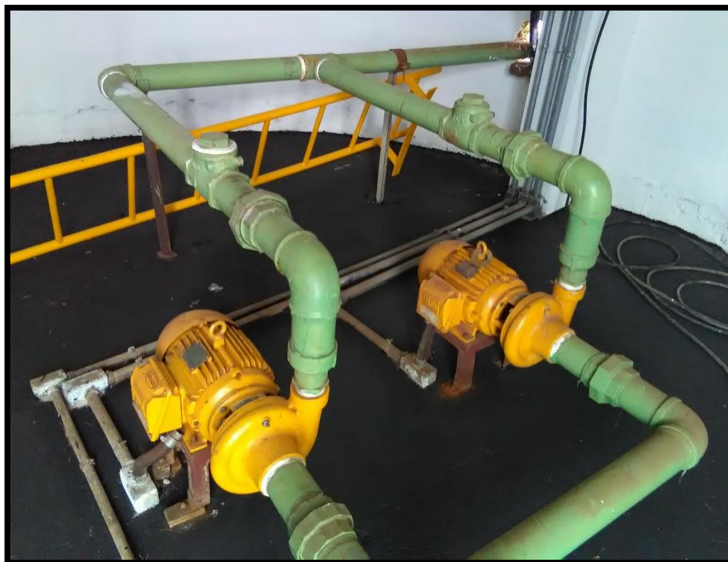
Imagem 27: Conjunto moto bombas da Estação Elevatória de Água do bairro Timburi
