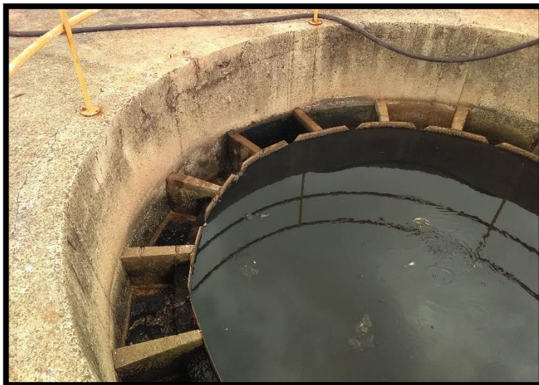
Imagem 40: Reator Anaeróbio – ETE Barrerão
