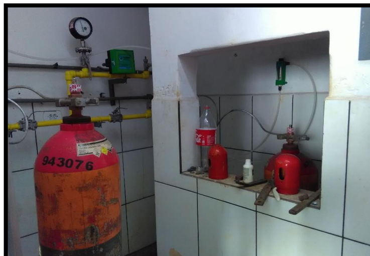
Imagem 17: ETA - Desinfecção por cloro gás
