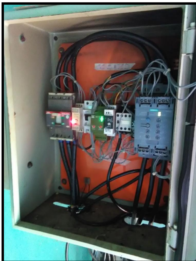
Imagem 30: Estação Elevatória de Água do bairro Timburi
