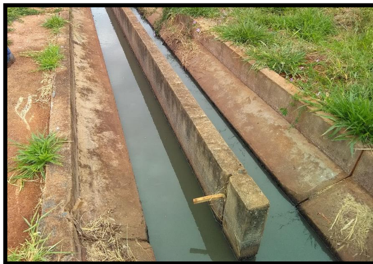
Imagem 44: Caixa de Areia – ETE das Antas
