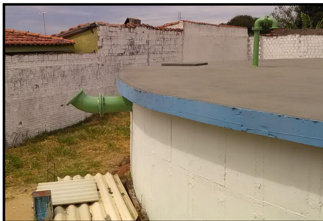
Imagem 21: Reservatório apoiado (RAP 1)
