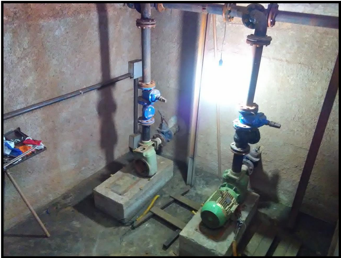
Imagem 24: Estação elevatória de esgoto 2 – conjunto moto bombas
