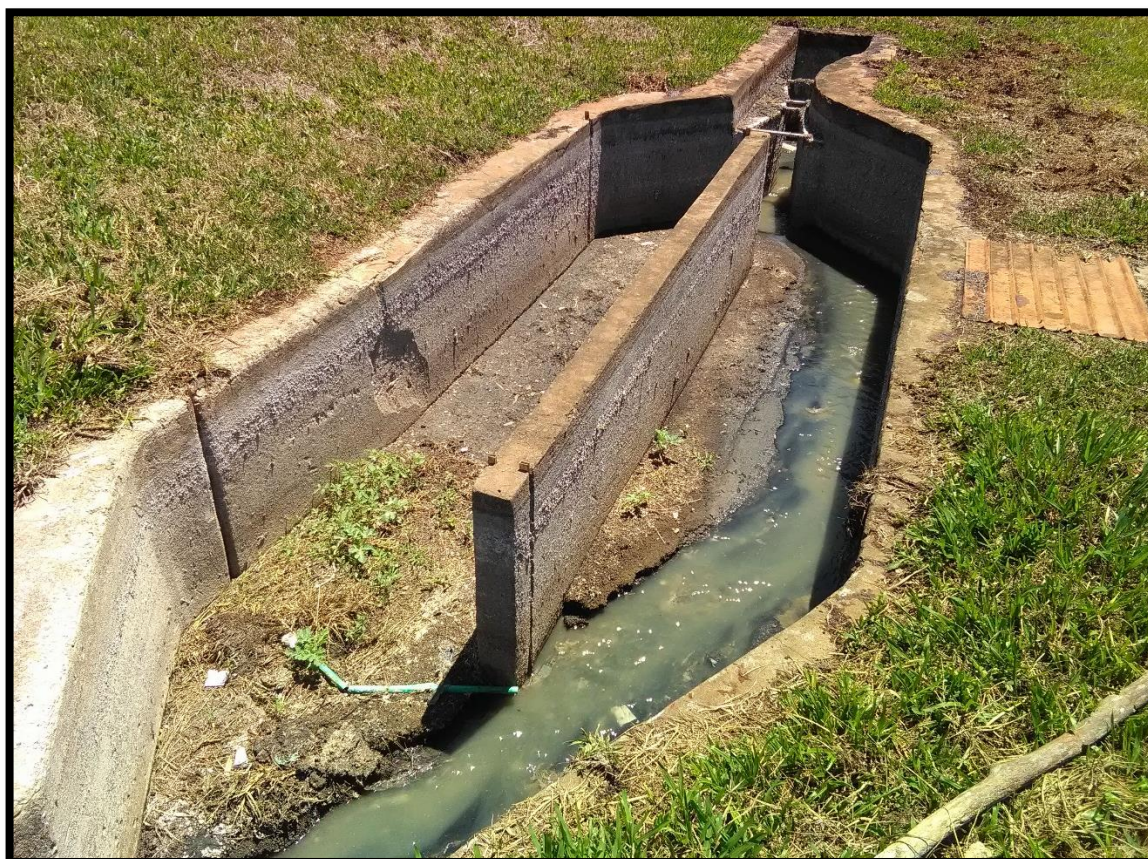
Imagem 23: Estação elevatória de esgoto 2 – caixa de areia
