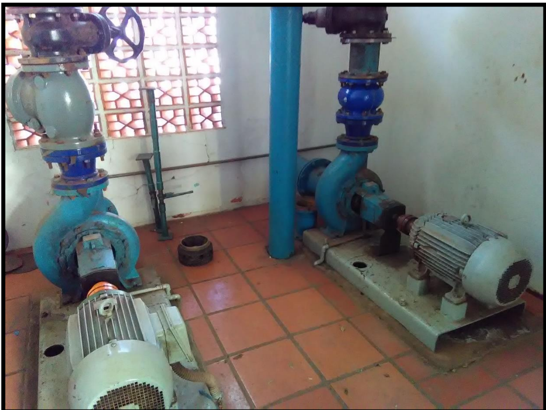
Imagem 11: conjunto moto bomba da Estação elevatória que abastece o REL Central
