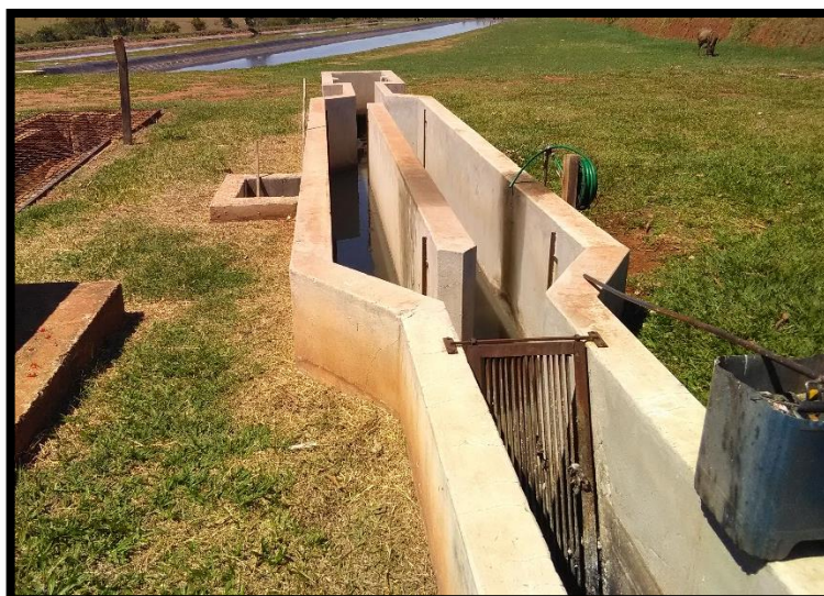
Imagem 27: Gradeamento, Caixa de areia e Medidor de vazão
