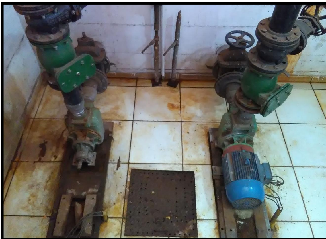
Imagem 22: Estação elevatória de esgoto 1 – conjunto moto bombas
