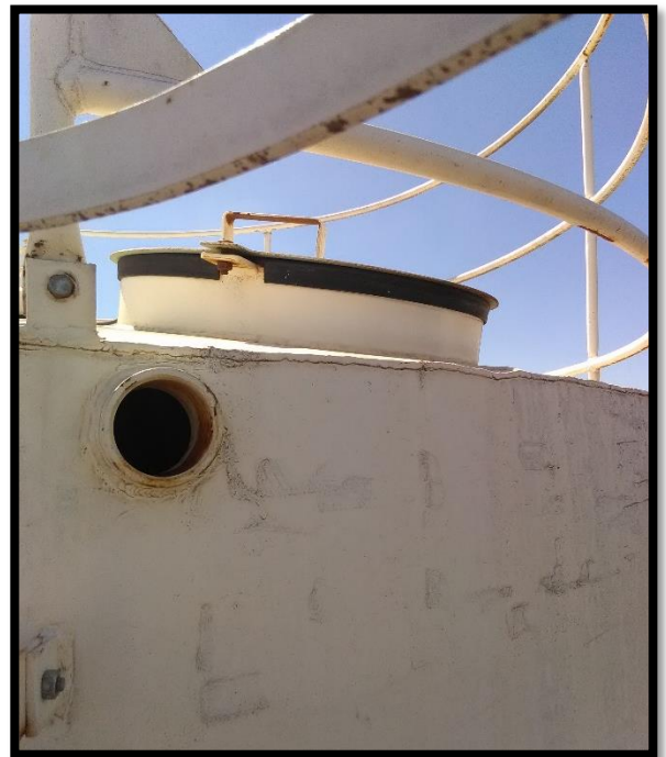
Imagem 10: Reservatório Novo de Apoio
