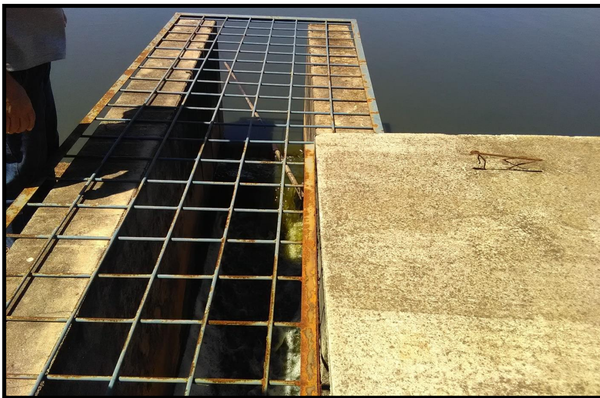
Imagem 30: Dispositivo de saída da Lagoa Facultativa
