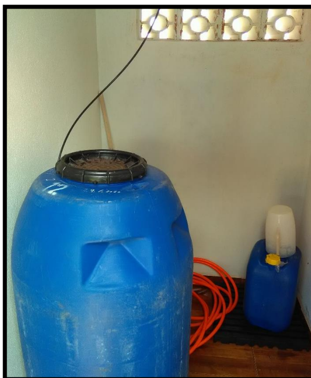
Imagem 13: Unidade de tratamento do distrito
