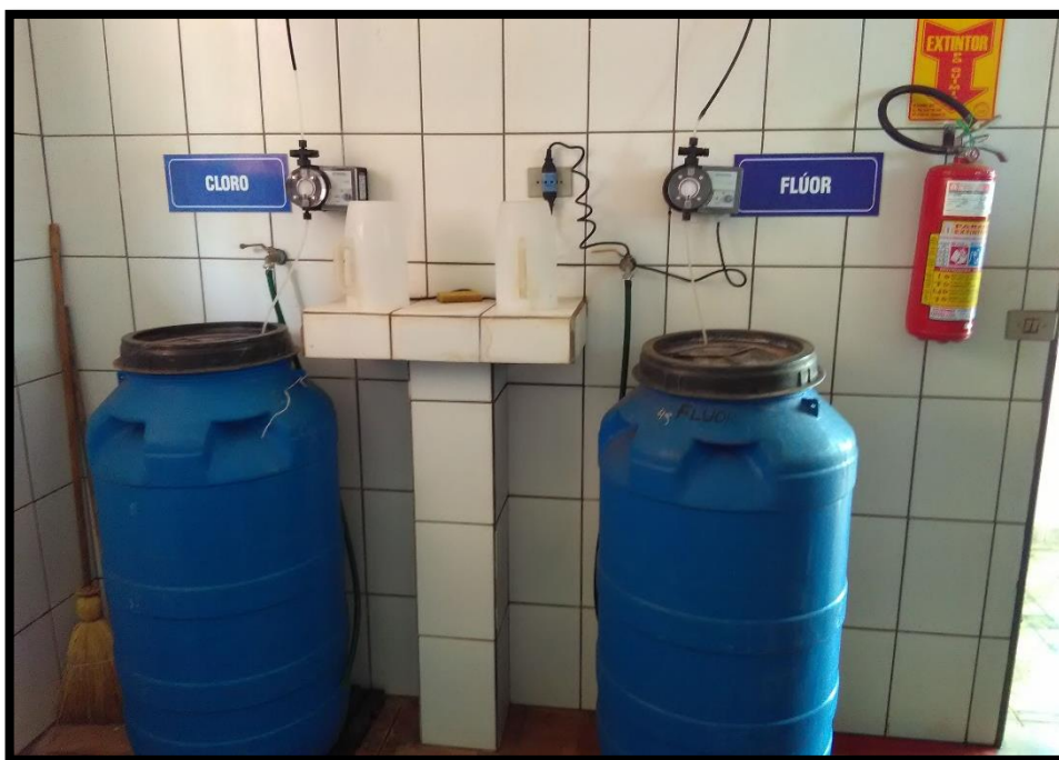
Imagem 12: Unidade de tratamento da área urbana
