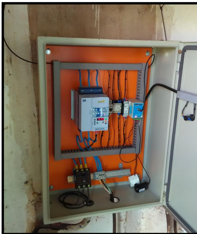
Imagem 4: quadro de comando do poço 2
