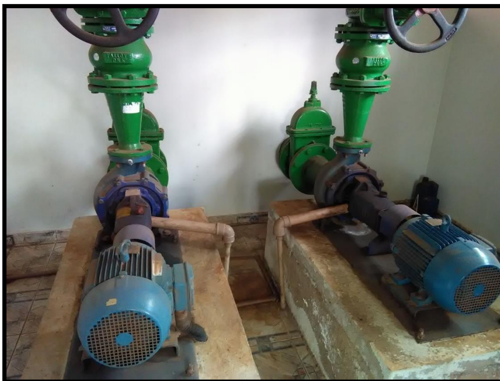
Imagem 14: Estação Elevatória de água
