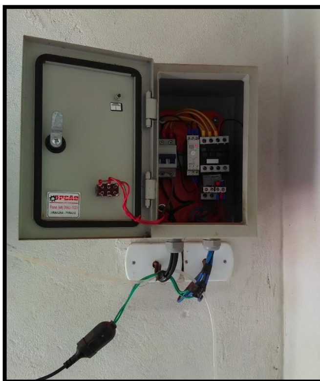
Imagem 6: quadro de comando do poço do distrito
