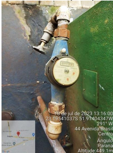
Foto 59 – Ponto de medição de pressão 02
