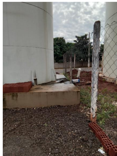
Foto 54 – Vazamento reservatório central novo
