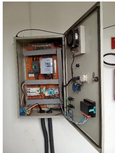
Foto 50 – Quadro de energia poço novo
