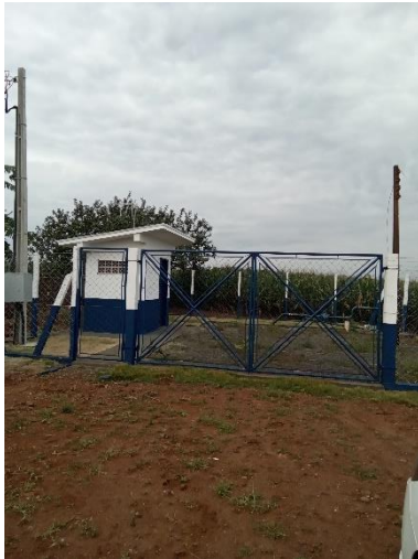
Foto 47 – Instalações poço novo
