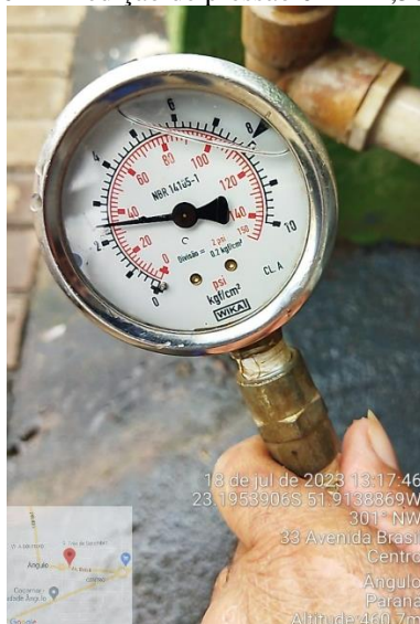
Foto 61 – Medição de pressão 02 = 24,50 m.c.a
