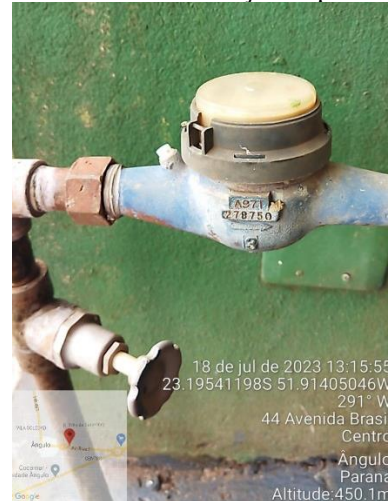
Foto 60 – Ponto de medição de pressão 02
