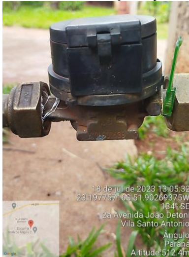
Foto 57 – Ponto de medição de pressão 01
