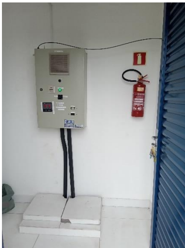
Foto 49 – Quadro de energia poço novo
