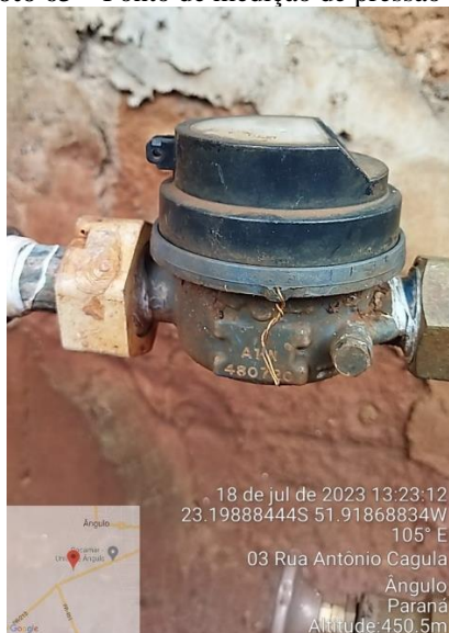
Foto 63 – Ponto de medição de pressão 03
