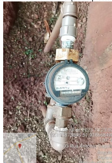
Foto 62 – Ponto de medição de pressão 03
