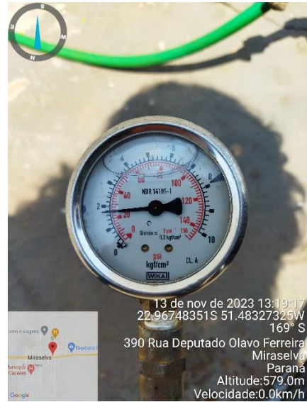
Foto 37 - Medição de pressão do ponto 02
