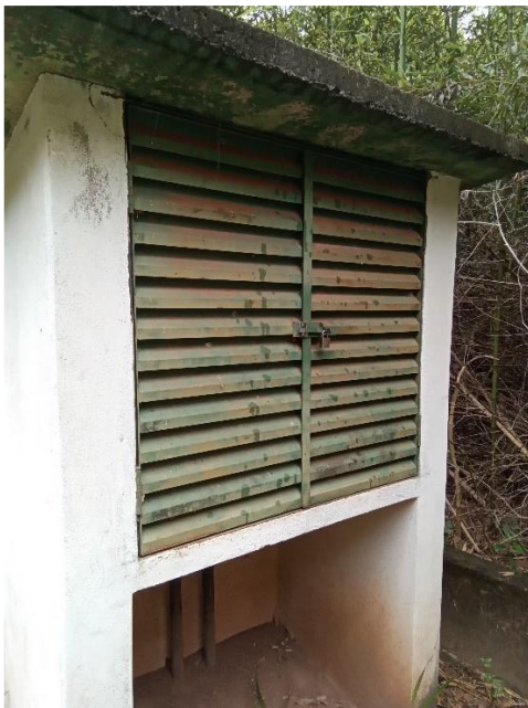
Foto 13 – Abrigo do quadro de comando
