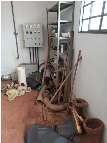
Foto 23 – Interior da casa de comando da EEA
