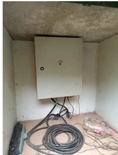
Foto 14 – Quadro de comando (fechado)
