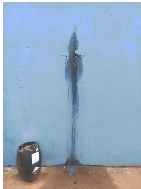
Foto 33 – Sinais de vazamento
