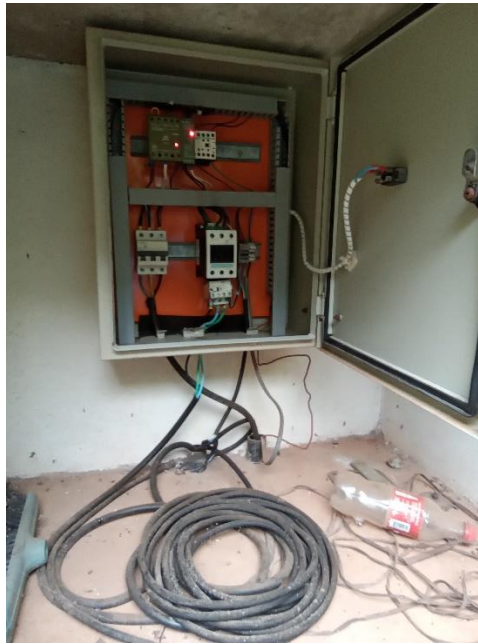
Foto 15 – Quadro de comando (aberto)
