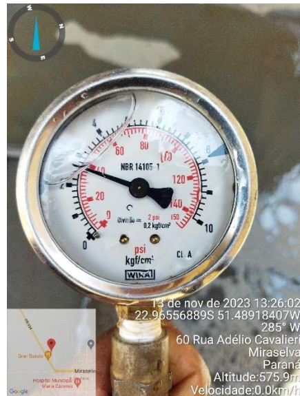
Foto 39 - Medição de pressão do ponto 03
