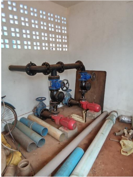
Foto 21 – Elevatória de água tratada
