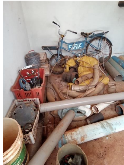
Foto 22 – Interior da casa de comando da EEA
