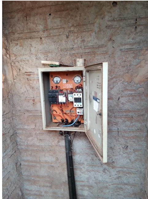
Foto 20 – Quadro de comando (aberto)
