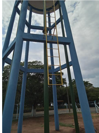
Foto 27 – Escada sem guarda corpo
