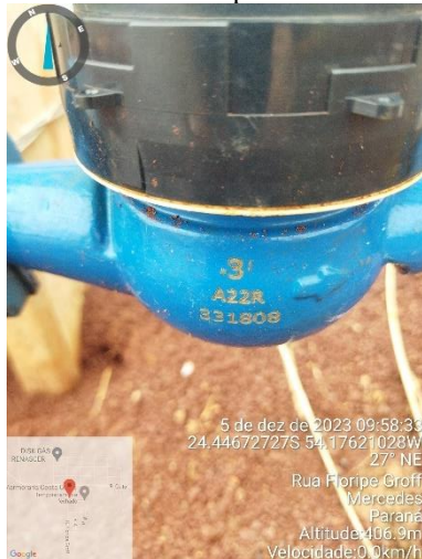
Foto 154 - Hidrômetro ponto 02 - Ano 2022
