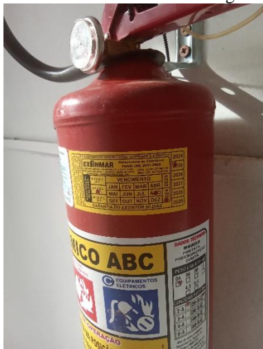
Foto 51 – Extintor validade vigente
