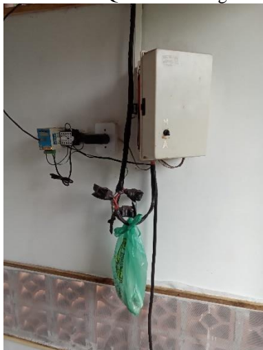
Foto 45 – Quadro de energia
