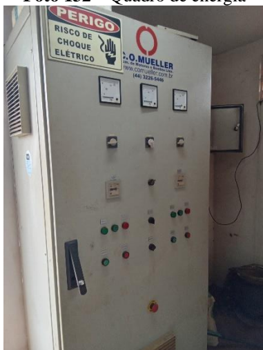
Foto 132 – Quadro de energia
