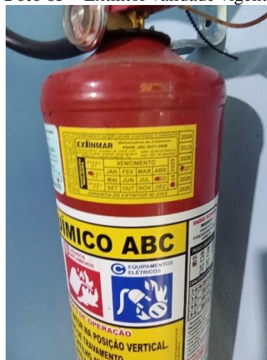
Foto 85 – Extintor validade vigente
