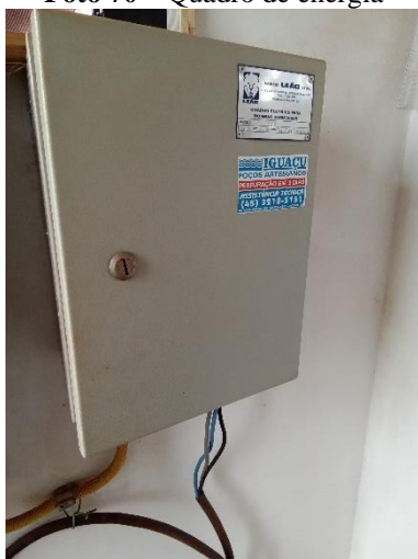
Foto 70 – Quadro de energia
