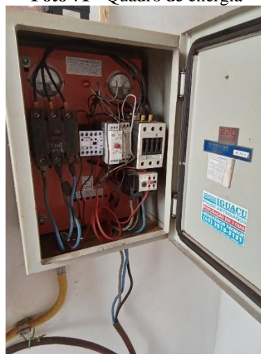
Foto 71 - Quadro de energia
