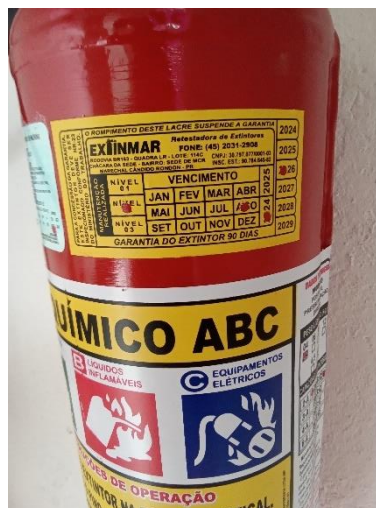
Foto 79 – Extintor com validade vigente
