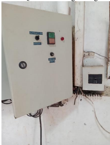
Foto 140 – Quadro de energia Sanga Alegre
