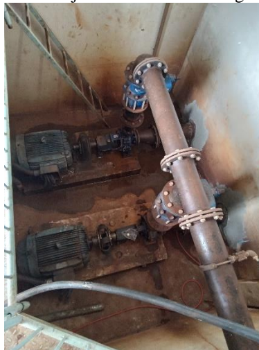
Foto 131 – Conjunto motobomba Sanga Mineira
