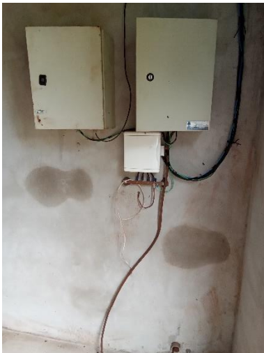
Foto 35 – Quadro de energia
