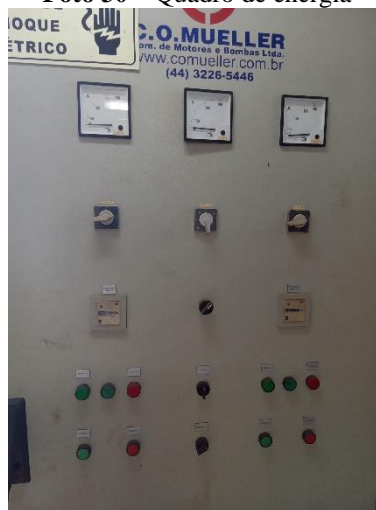
Foto 30 – Quadro de energia
