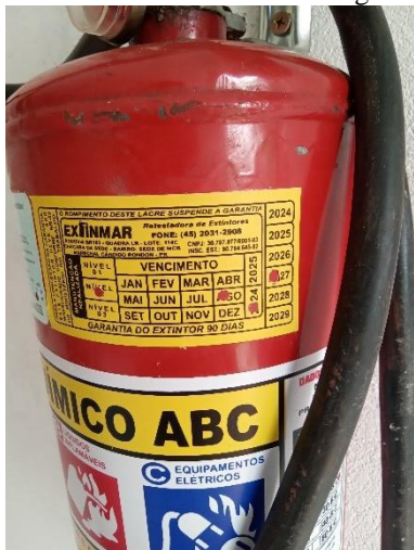
Foto 21 – Extintor validade vigente
