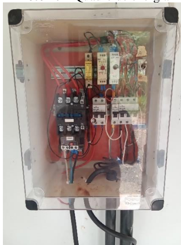
Foto 20 – Quadro de energia
