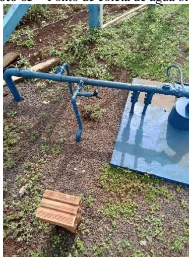
Foto 65 – Ponto de coleta de água bruta
