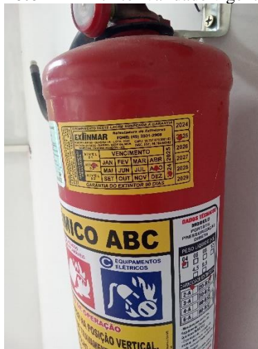
Foto 44 – Extintor validade vigente
