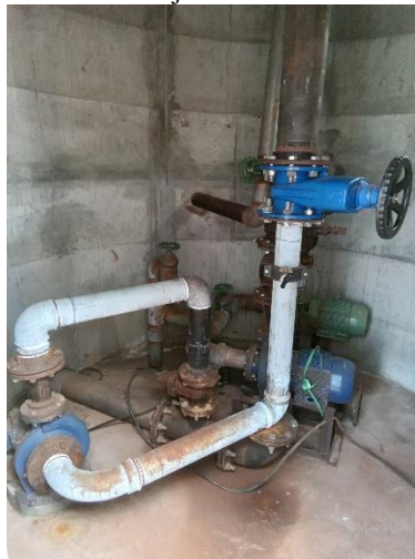
Foto 145 – Conjunto motobomba Sede
