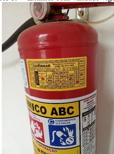
Foto 59 – Extintor com validade vigente
