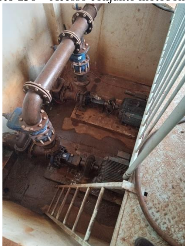
Foto 136 – Acesso conjunto motobomba
