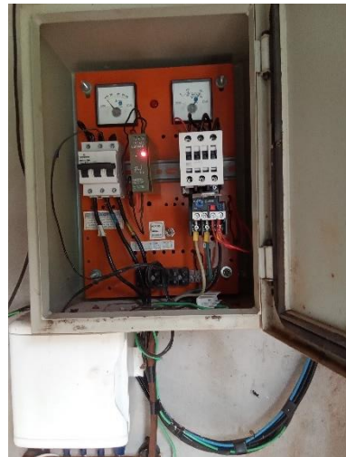
Foto 36 – Quadro de energia
