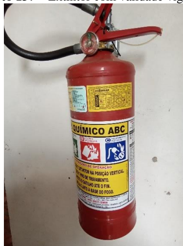
Foto 137 – Extintor com validade vigente
