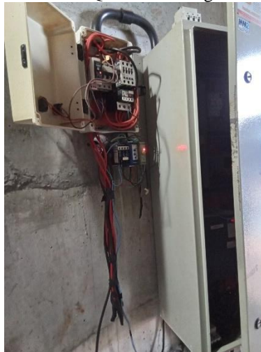
Foto 149 - Quadro de energia Sede
