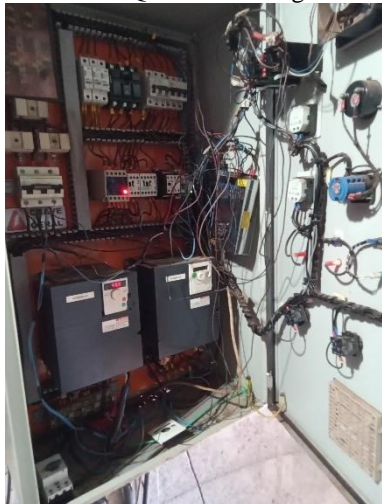
Foto 148 - Quadro de energia Sede
