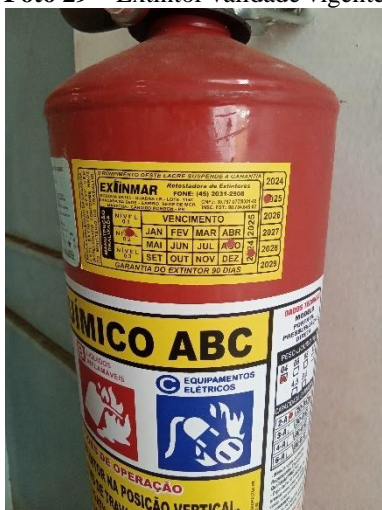
Foto 29 – Extintor validade vigente
