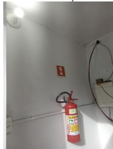
Foto 50 – Extintor e iluminação casa de comando
