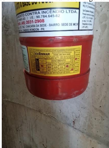
Foto 147 – Extintor validade vigente Sede
