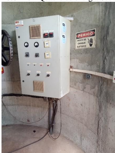
Foto 146 – Quadro de energia Sede
