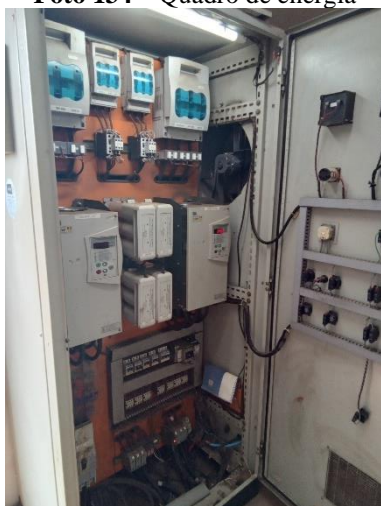
Foto 134 – Quadro de energia
