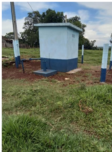
Foto 38 – Cercamento incompleto (falta alambrado e portão)
