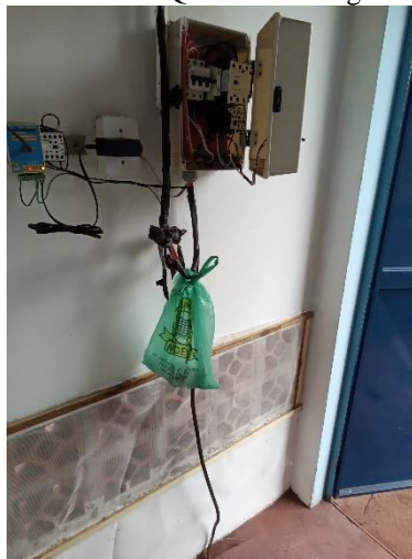
Foto 46 - Quadro de energia
