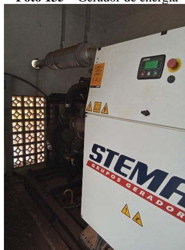
Foto 135 – Gerador de energia
