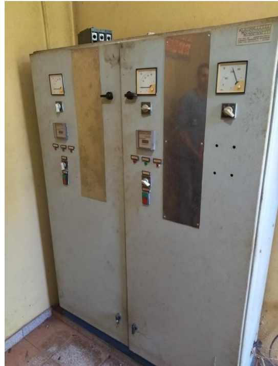
Foto 62: Quadro de comando
