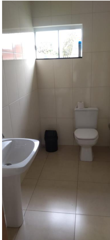
Foto02: Banheiro Sede (falta acessibilidade para deficientes).
