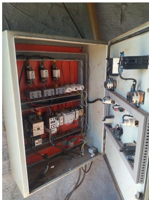
Foto 49: Quadro de comando.
