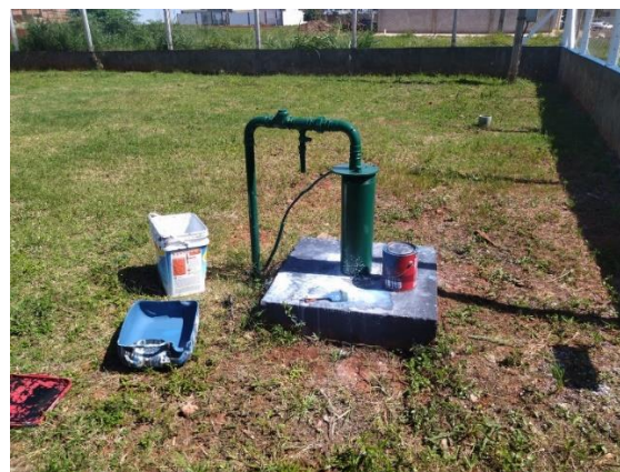
Foto 47: Poço Novo Horizonte, instalações.
