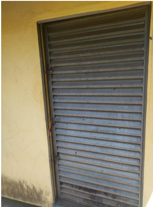
Foto 61: Porta necessitando de reparos
