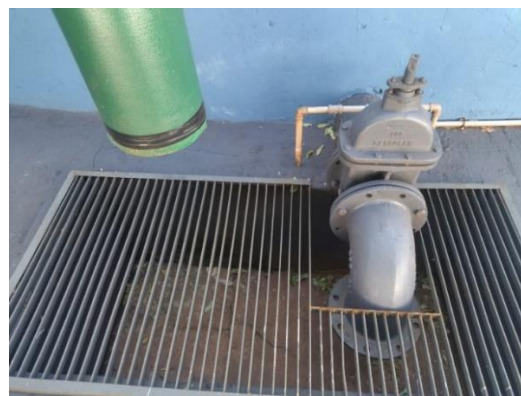
Foto 81: extravasor de registro
