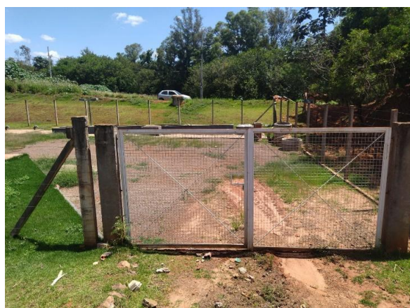
Foto 115: Falta de identificação (acesso)
