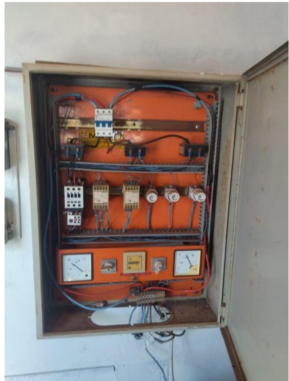
Foto 43: Quadro elétrico de comando.
