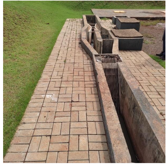
Foto 107: Sistema de gradeamento
