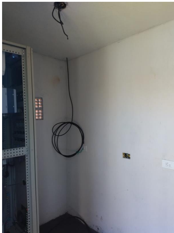
Foto 32: Ausencia de iluminação interna na casa de comando.
