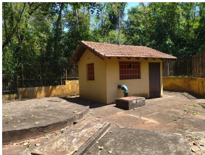
Foto 60: Instalações EEA, Falta de iluminação externa.
