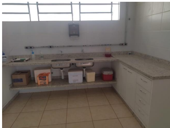
Foto 09: Parte interna do laboratório (ausência de chuveiros de emergência)
