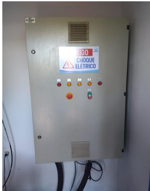
Foto 36: Quadro elétrico de comando
