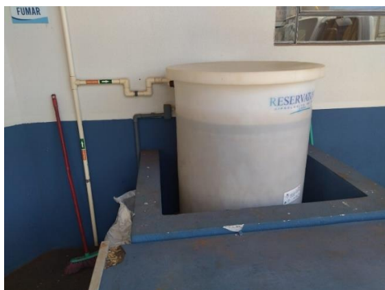
Foto 22: Tanque de armazenamento de cloro.
