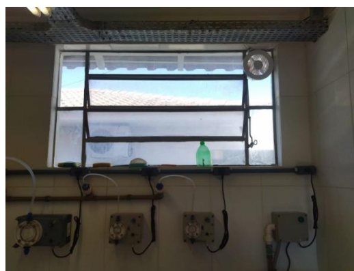
Foto 19: Bombas dosadoras e ventilação.
