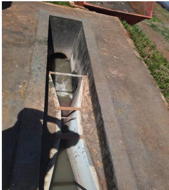
Foto 94: Calha Parshall (entrada)
