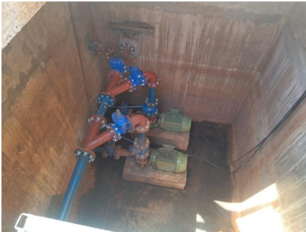
Foto 118: Bombas de Recalque e escada
