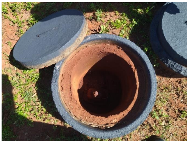
Foto 76: Caixa de registro
