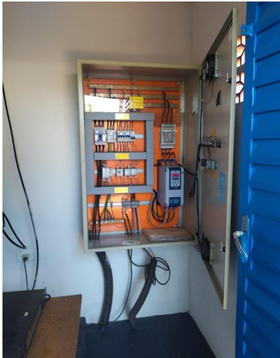
Foto 36: Quadro elétrico de comando
