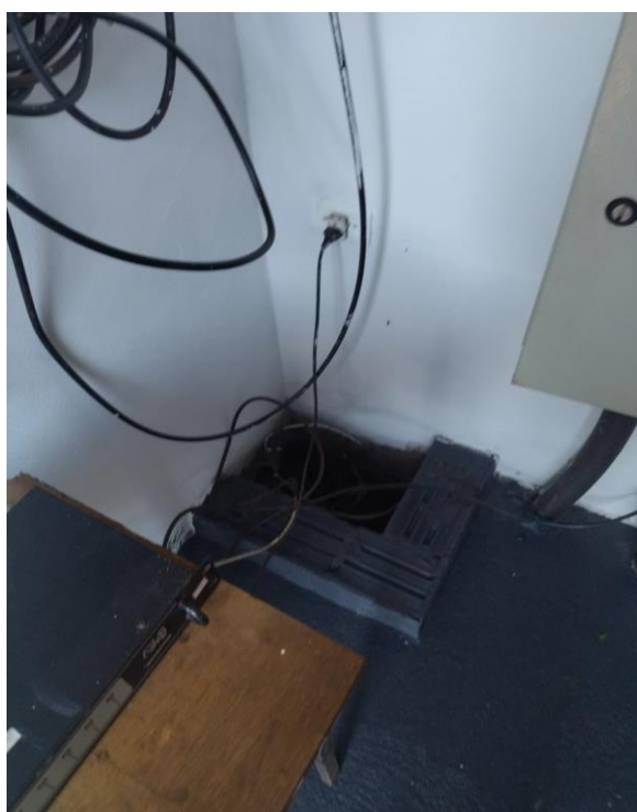
Foto 35: Falta de isolamento da fiação elétrica
