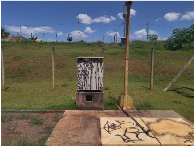
Foto 120: Quadro de comando
