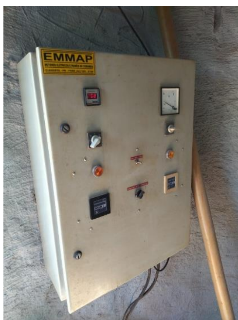
Foto 48: Quadro de comando.
