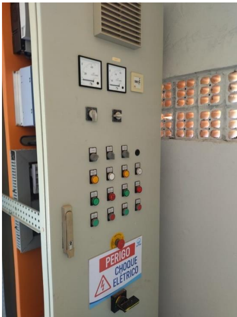
Foto 30:Quadro de comando.
