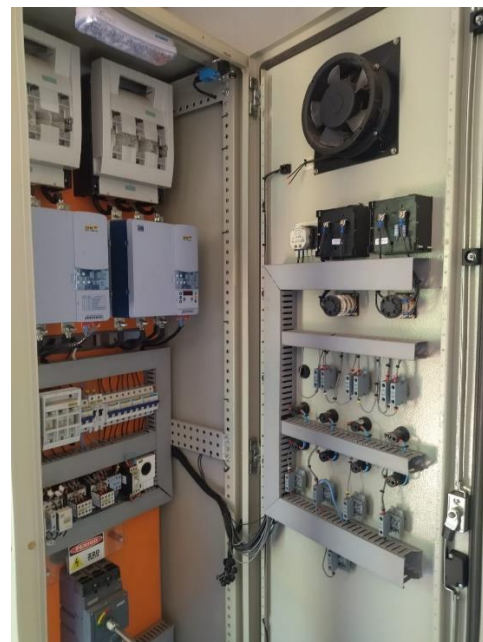
Foto 31: Quadro de Comando.
