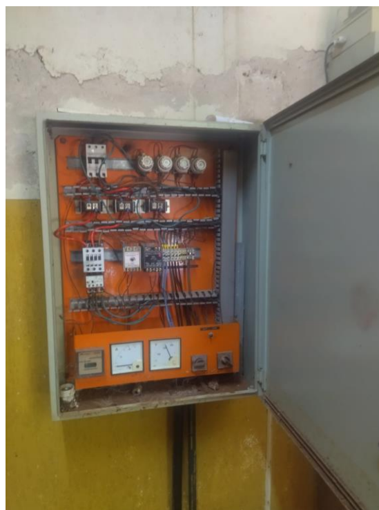
Foto 68: Quadro de comando.
