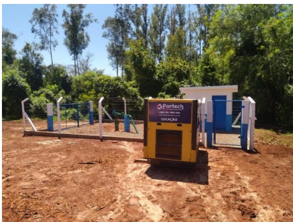
Foto 26: Poço Volpato – Area sem iluminação externa .
