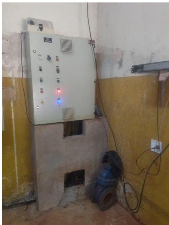
Foto 67: Quadro de comando.
