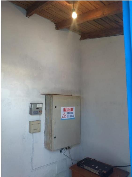
Foto 42: Quadro elétrico de comando.
