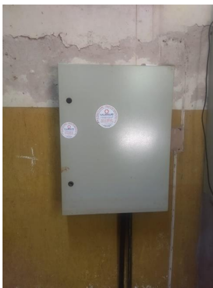
Foto 53: Quadro de comando.
