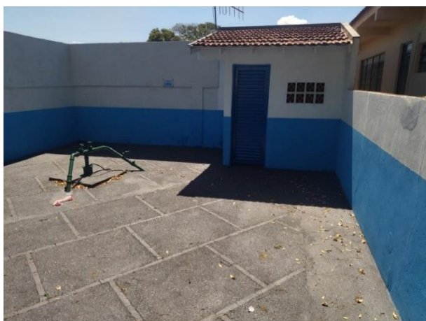
Foto 41: Condições estruturais, Identificação IAT
