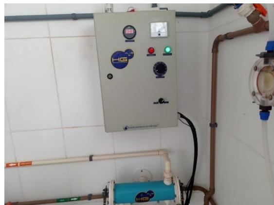
Foto 23: Quadro de comando (gerador de cloro)
