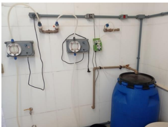
Foto 24: Tanque de flúor.
