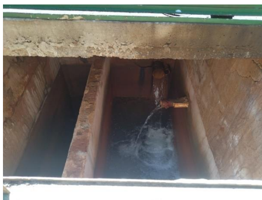
Foto 56: Entrada de água bruta no reservatório da mina.
