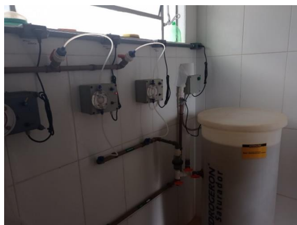
Foto 25: Saturador de cloro.
