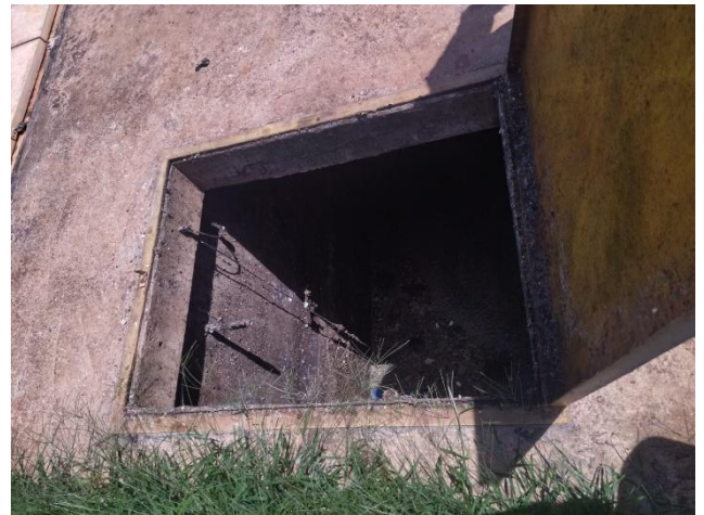
Foto 119: Reservatório efluente EE2
