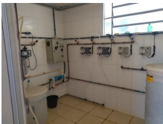
Foto 18: Unidade de tratamento de água (ausência de extintores)
