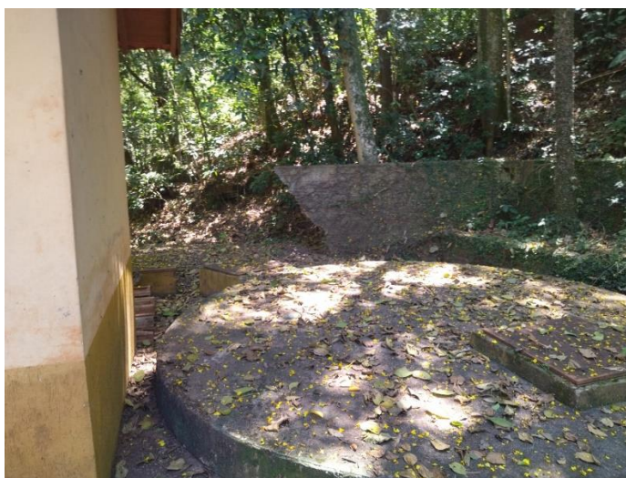
Foto 75: Muro próximo ao reservatório necessitando de reparos
