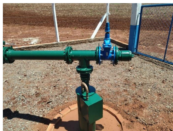
Foto 29: Ausencia tomada de coleta, nível e laje adequada.
