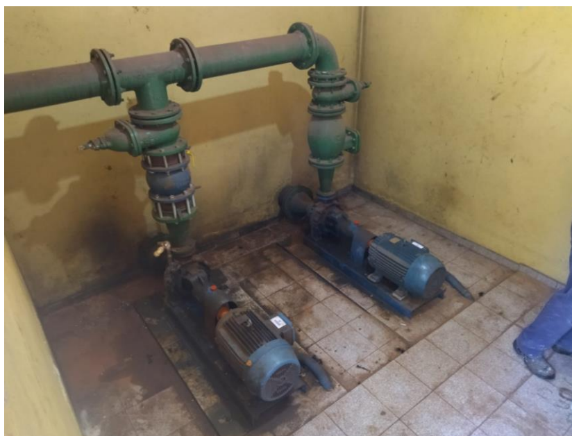
Foto 64: Conjunto moto bomba instalado.
