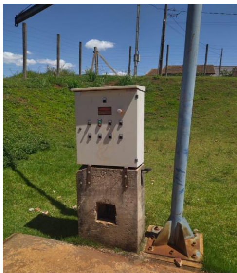
Foto 113: Quadro de comando
