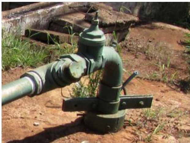
Figura 6 – Manancial subterrâneo sem estrutura adequada (principais pontos: falta de laje de apoio e tubo de revestimento a menos de 50 cm da superfície).
