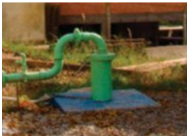
Figura 7 – Manancial subterrâneo com estrutura adequada (principais pontos: existência de laje de cobertura, tubo de revestimento a mais de 50 cm da superfície e lacre entre tubos de revestimento e de captação)
