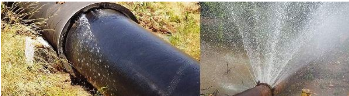
Figura 11 – Adutoras de água com vazamento
