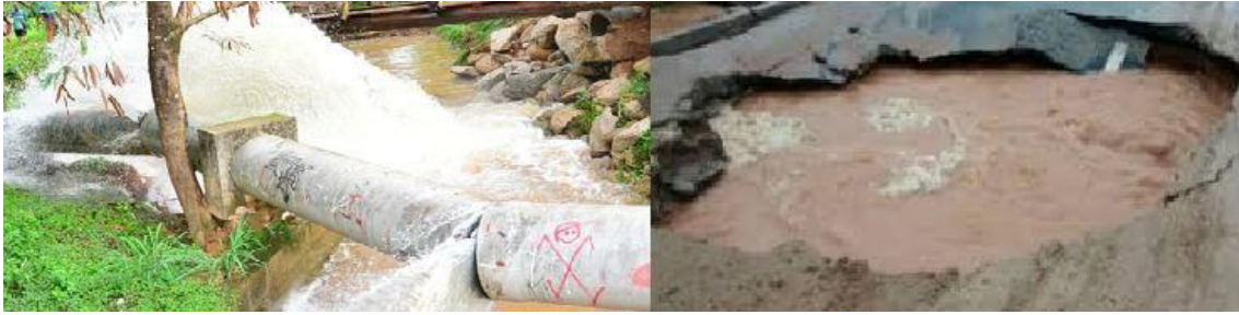
Figura 12 – Trecho de adutora rompida em travessia suspensa sobre curso d'água à esquerda e pavimento cedido após rompimento de adutora à direita.
