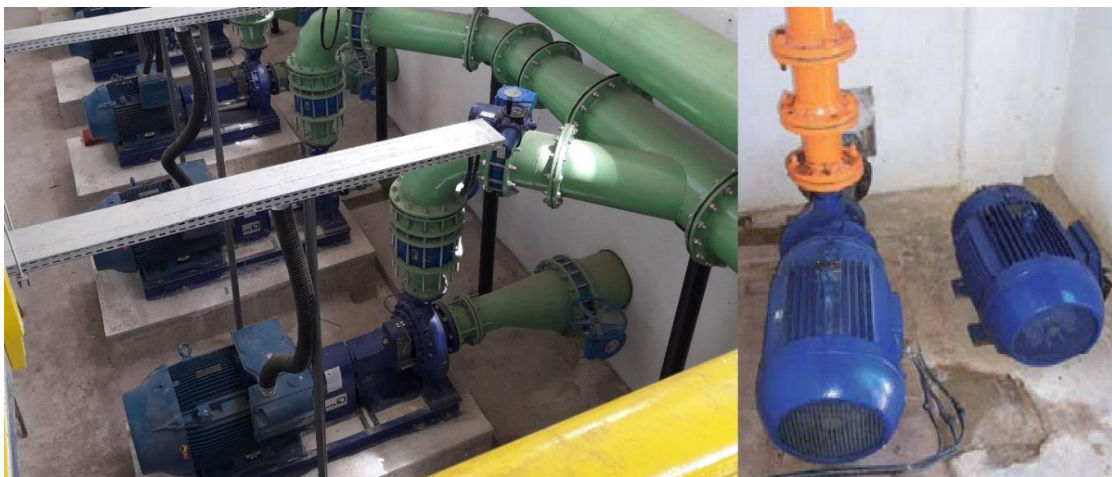
Figura 10 – Elevatórias de água com bomba reserva (à esquerda instalada em paralelo e à direita em espera).
